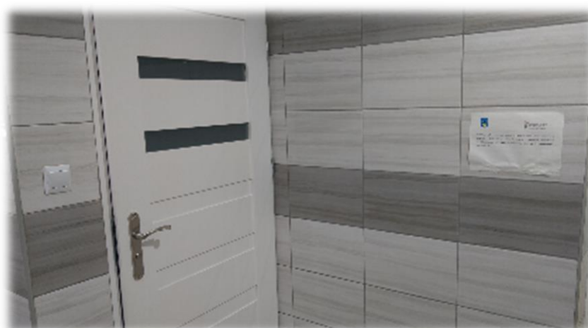
Fot. Dostosowanie łazienki do potrzeb osób niepełnosprawnych w Urzędzie Gminy
