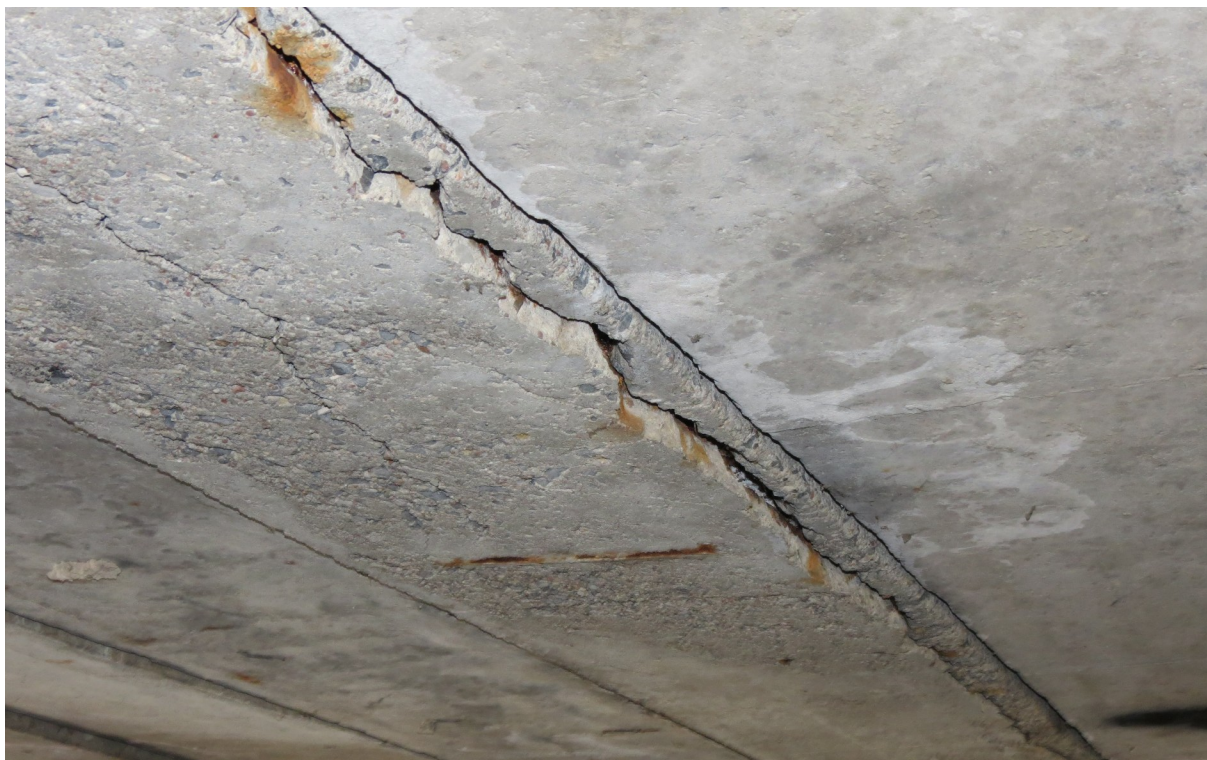
Fot. 8. Korozja betonu, ubytki w otulinie. Punktowa korozja zbrojenia belek prefabrykowanych.
