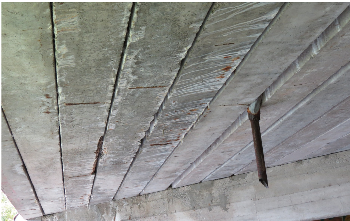
Fot. 6. Osady i wykwity zakończone stalaktytami na belkach prefabrykowanych ustroju nośnego. Korozja stali zbrojeniowej belek.
