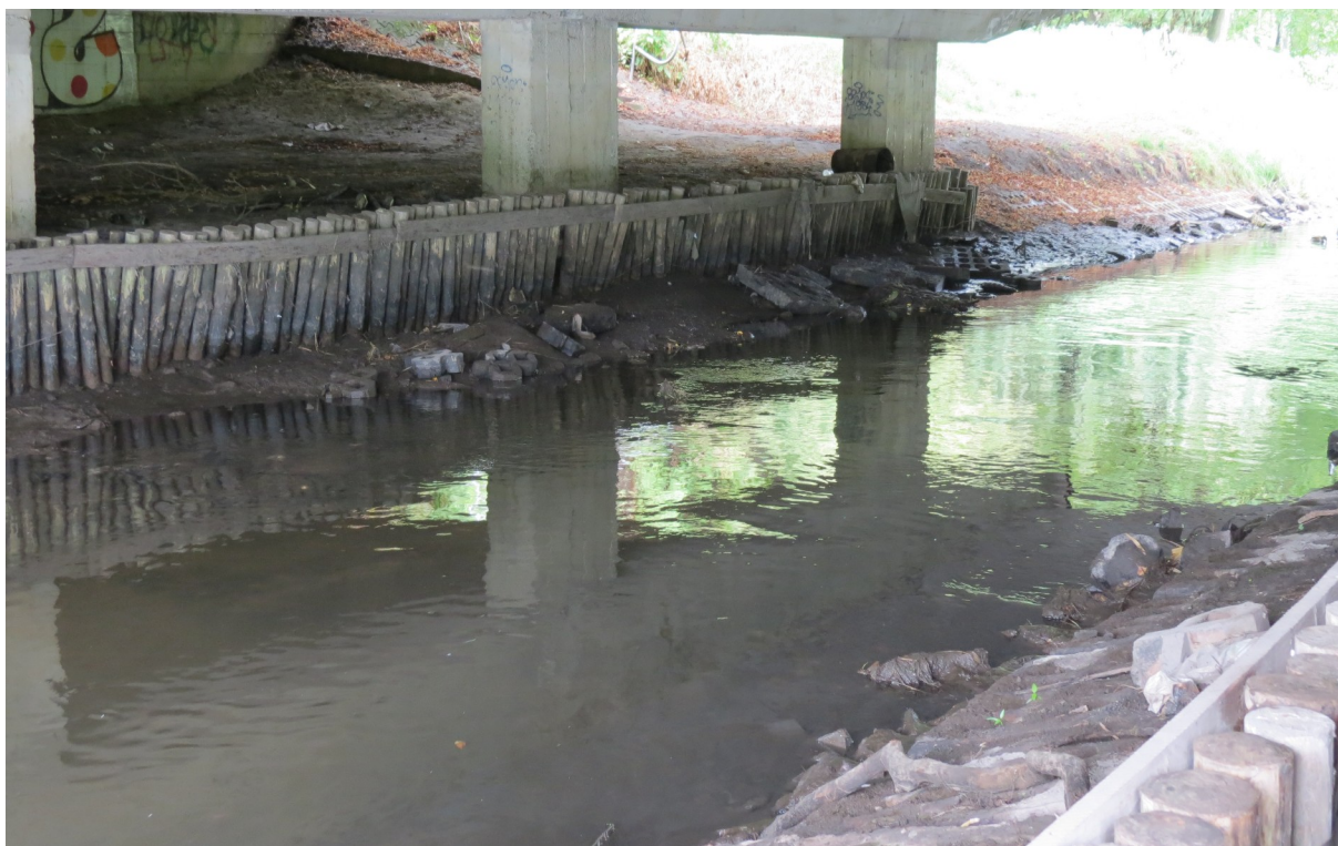
Fot. 37. Przemieszczenie elementów betonowych umocnienia skarp rzeki oraz zanieczyszczenie koryta rzeki.
