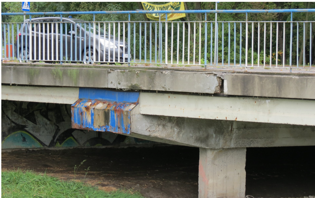
Fot. 17. Korozja i ubytki betonu prefabrykatów gzymsowych.
