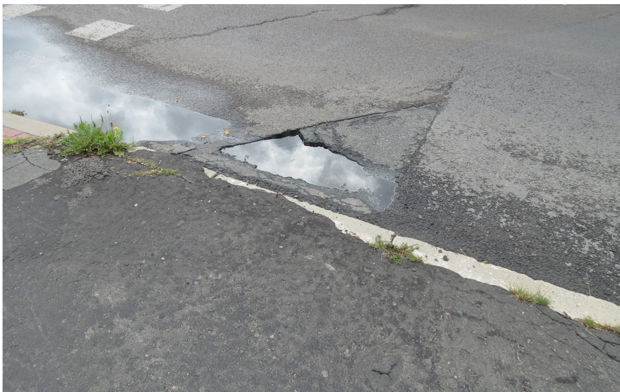
Fot. 33. Deformacja nawierzchni chodnika z masy oraz ubytki i nierówności w nawierzchni bitumicznej jezdni.
