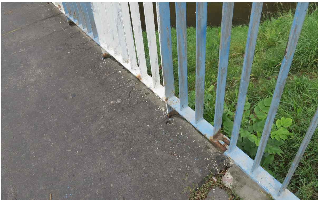
Fot. 30. Korozja balustrady mostowej.
