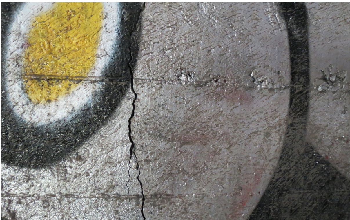
Fot. 11. Rysy i pęknięcia betonu oraz akt wandalizmu w postaci graffiti na ścianie przyczółka.
