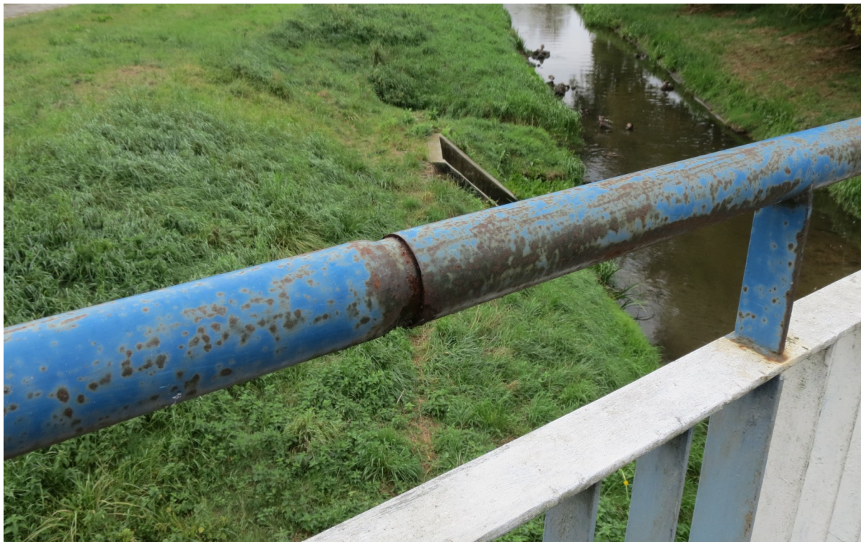
Fot. 29. Uszkodzenie powłoki zabezpieczenia antykorozyjnego pochwytu balustrady.
