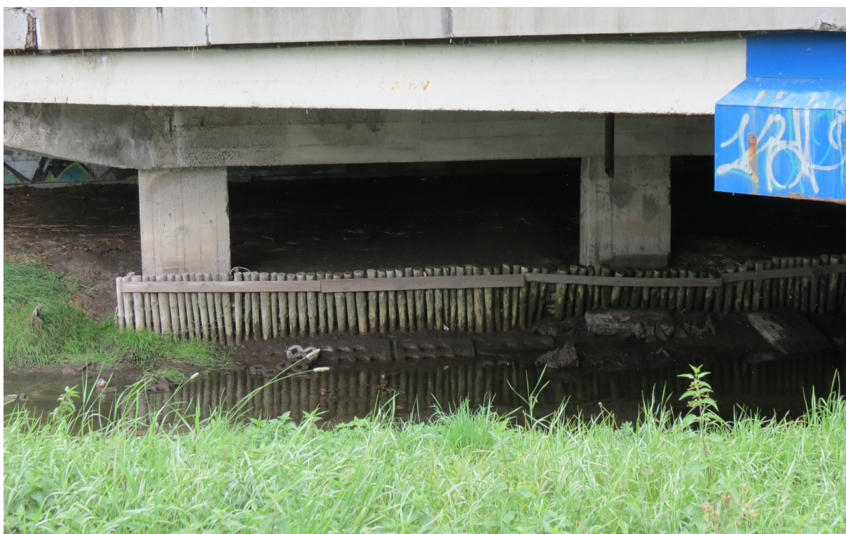
Fot. 36. Korozja biologiczna umocnienia skarp rzeki z palisady.
