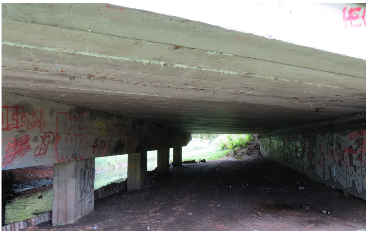
Fot. 5. Zanieczyszczenia, przecieki wody przez uszkodzoną izolację. Osady i wykwity na spodzie płyty pomostu zakończone stalaktytami. Początek degradacji betonu.
