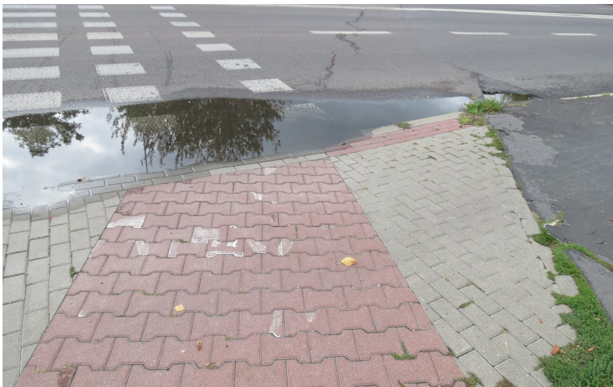
Fot. 34. Zastoisko wody na jezdni powstałe wskutek zniżenia nawierzchni bitumicznej jezdni i braku urządzeń odwadniających.
