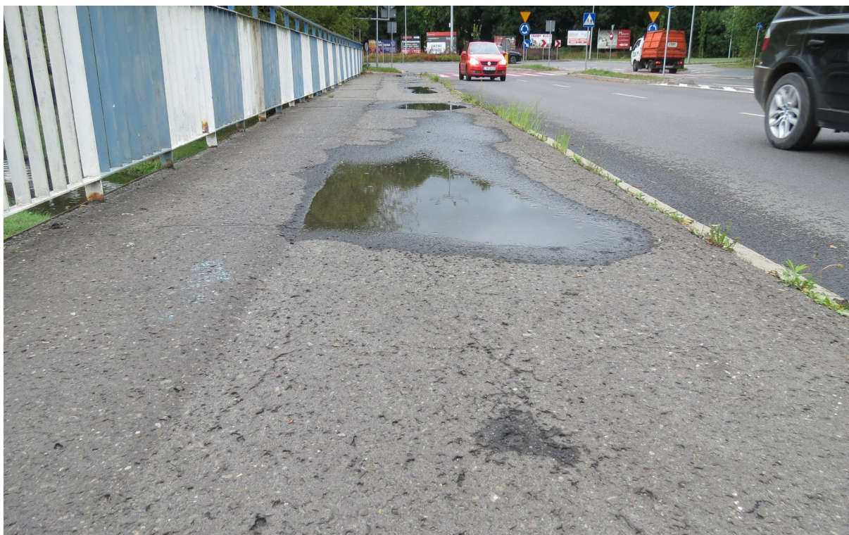
Fot. 25. Deformacja nawierzchni chodnika z masy z widocznymi zastoiskami wody. Wegetacja roślinności przy krawężniku.
