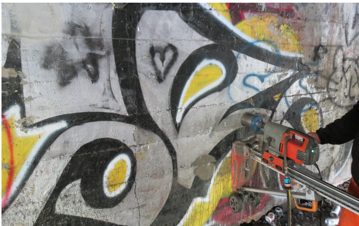
Fot. 13. Zanieczyszczenie ściany przyczółka przez graffiti z widocznymi rysami i pęknięciami betonu.
