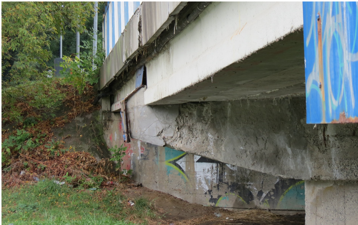
Fot. 19. Degradacja betonu oczepu. Wegetacja roślinności na umocnieniu skarpy nasypu.
