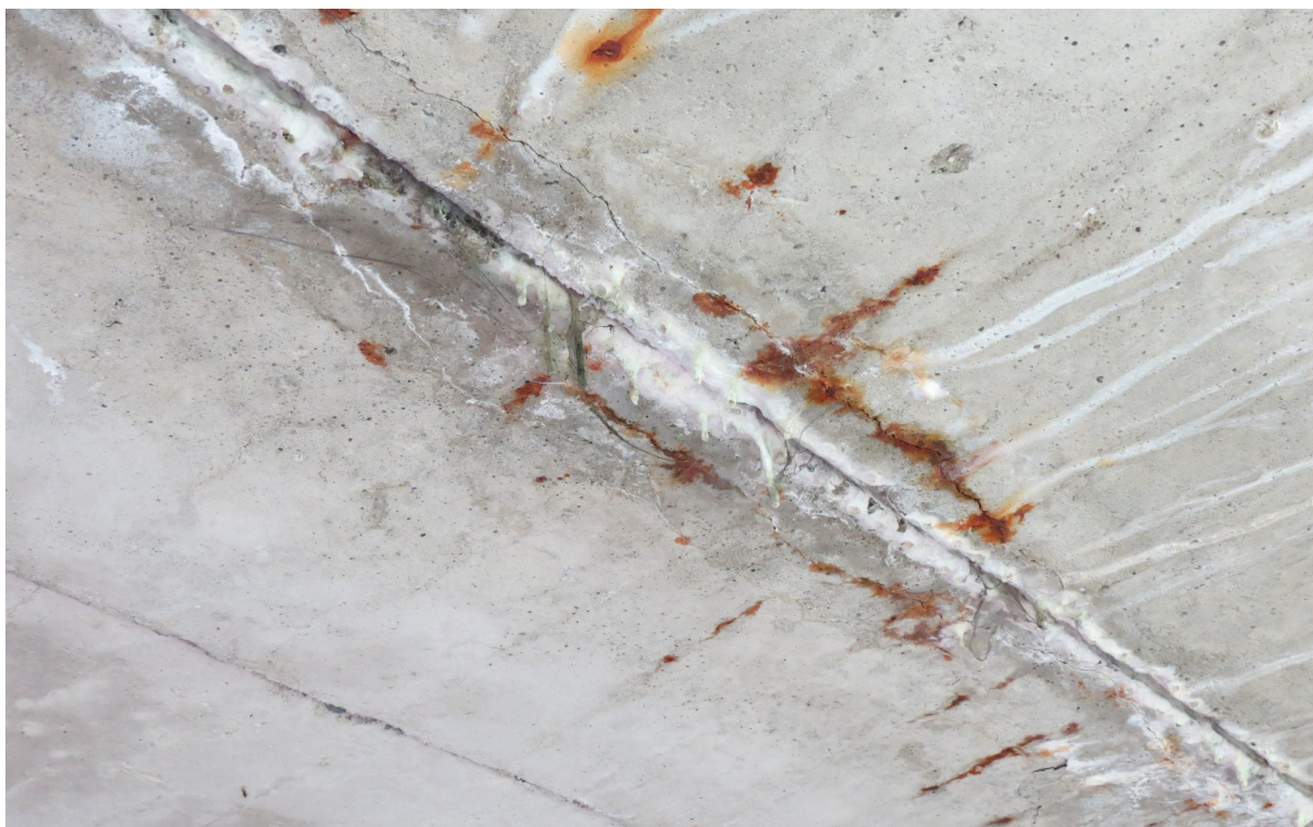
Fot. 7. Korozja betonu, widoczne rysy i ubytki betonu spowodowane dużą nasiąkliwością.
