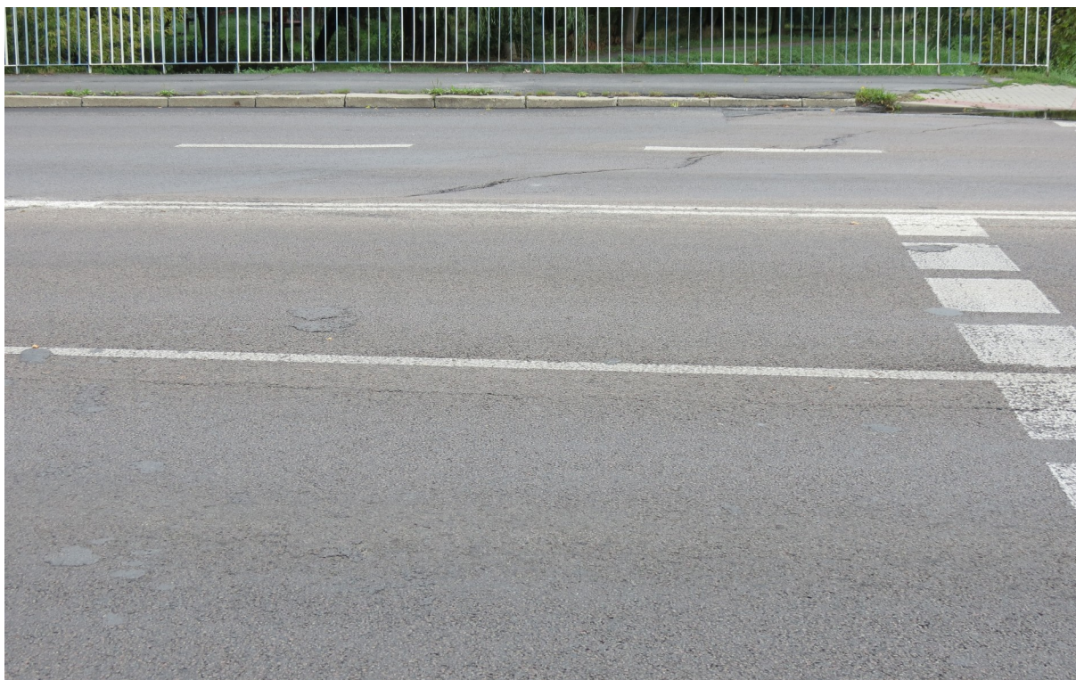
Fot. 35. Rysy wzdłużne i poprzeczne nawierzchni na moście.
