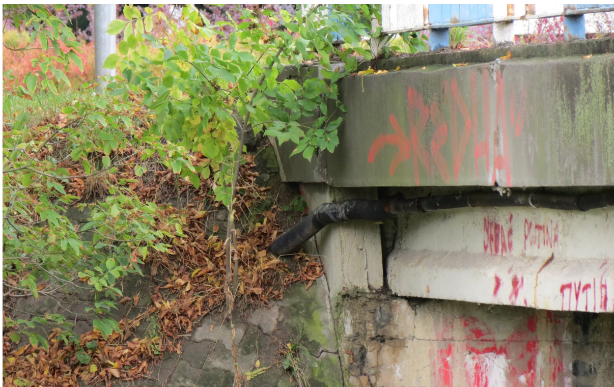
Fot. 22. Rozległe zanieczyszczenia graffiti pogarszające estetykę obiektu na pow. betonowych. Wegetacja roślinności na stożkach nasypów.
