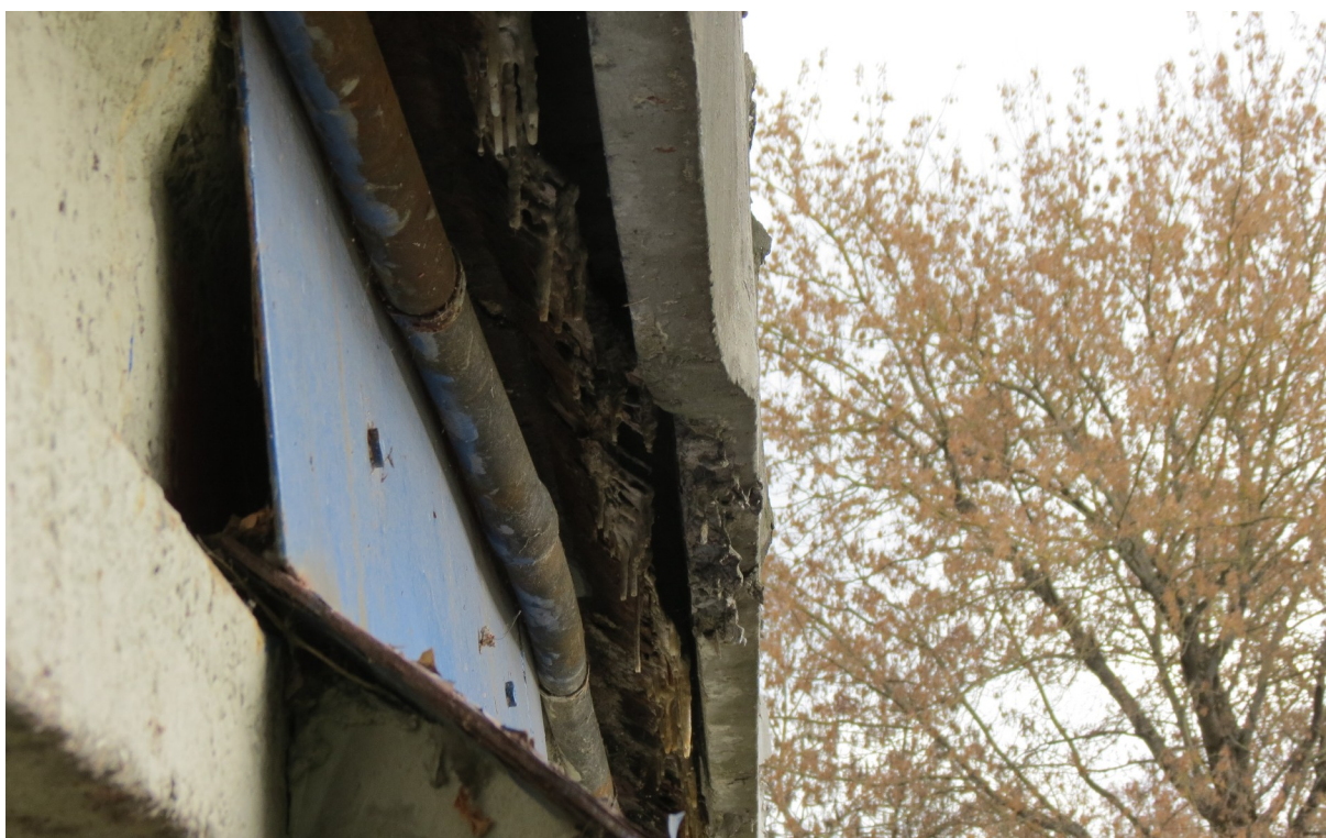
Fot. 16. Uszkodzone rur osłonowych z urządzeniami obcymi.
