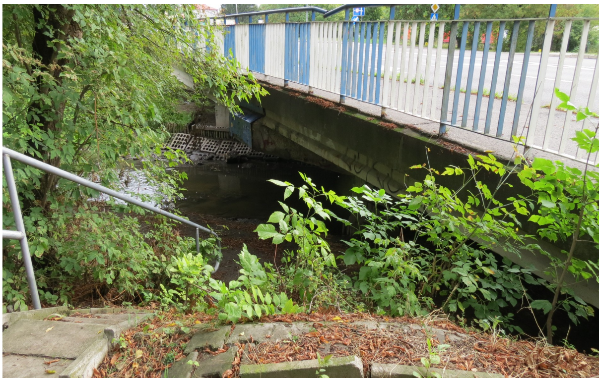
Fot. 23. Zanieczyszczenie stożków nasypu z wegetacją roślinności na ich powierzchni oraz schodów technologicznych.
