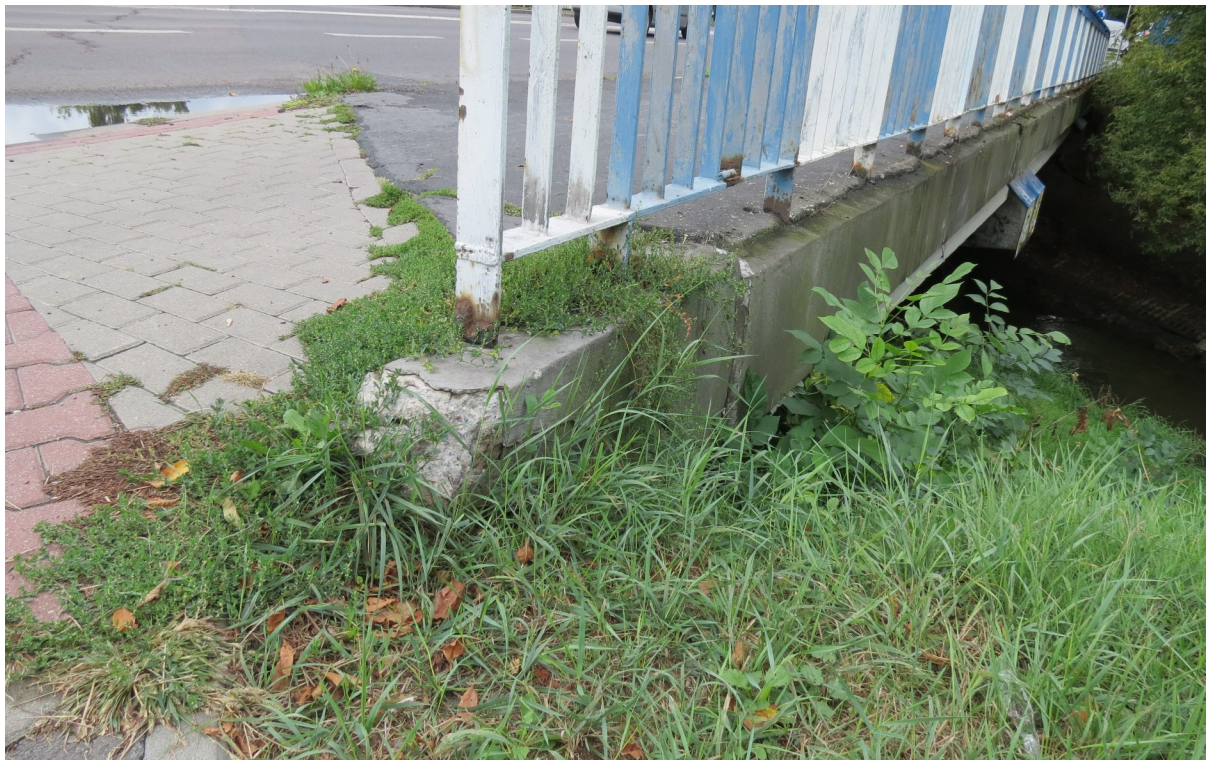
Fot. 31. Bujna roślinność na chodniku i skarpie nasypu.
