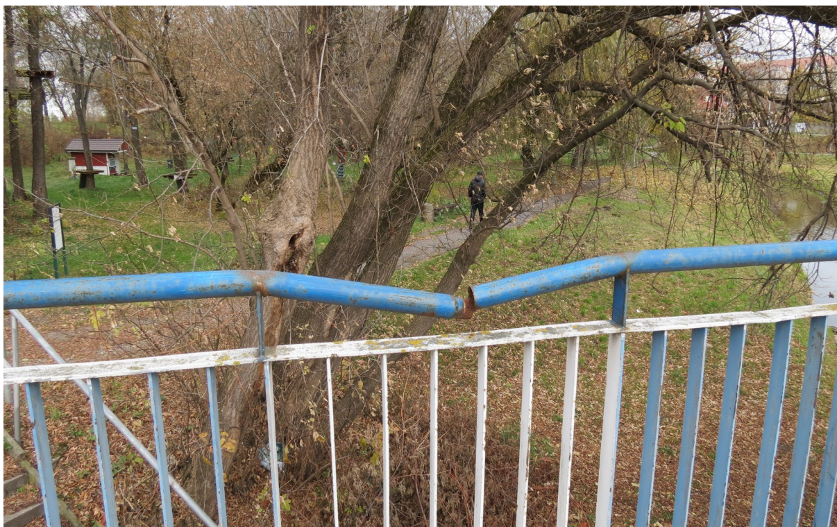
Fot. 32. Uszkodzenie pochwyty oraz zabezpieczenia antykorozyjnego balustrady mostowej.
