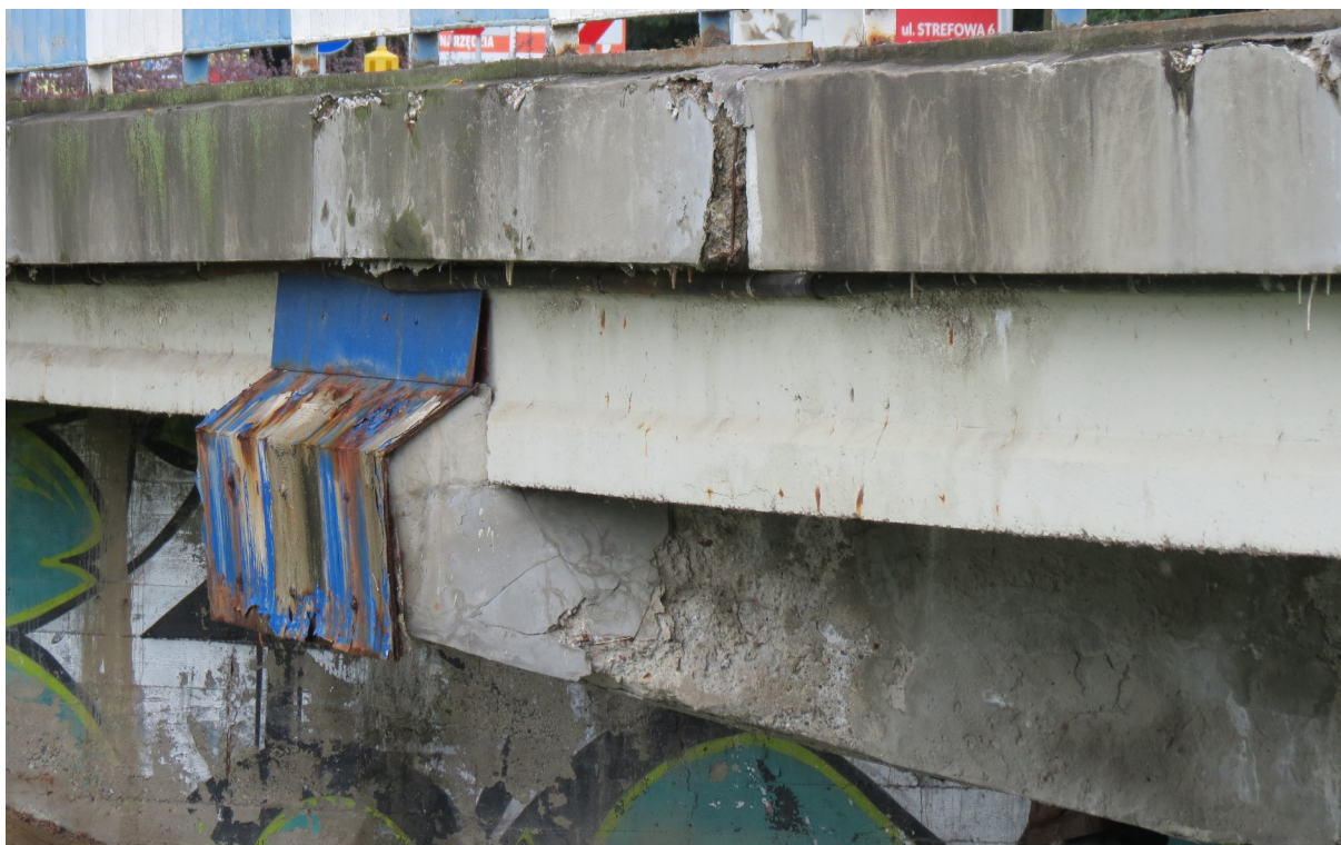
Fot. 21. Wykwity, zanieczyszczenia oraz stalaktyty na betonie desek gzymsowych oraz niewielkie ubytki betonu.
