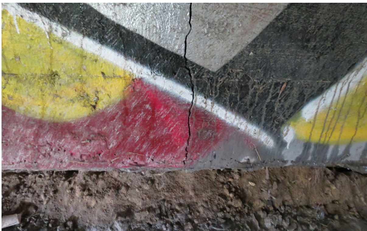
Fot. 12. Pionowa rysa na ścianie przyczółka od str. ul. Dzieci Zamojszczyzny. Rozwartość rysy powyżej 5mm.
