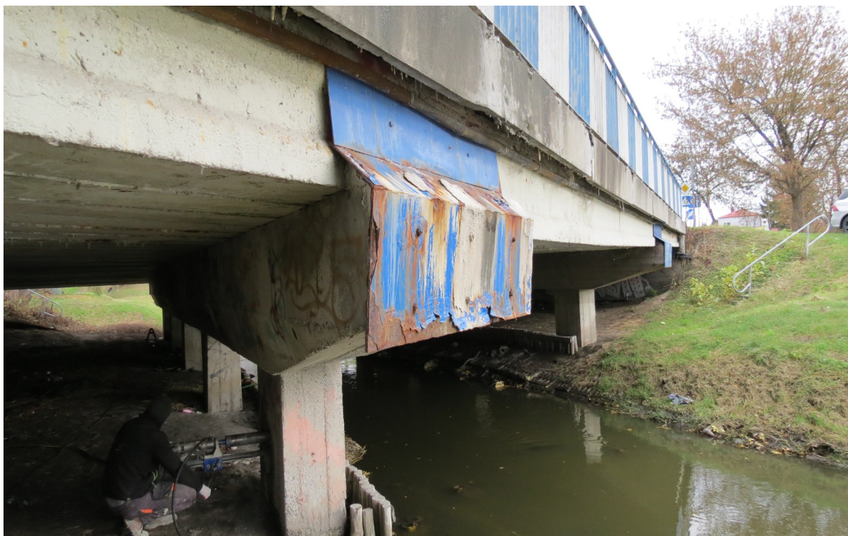
Fot. 15. Korozja blach osłonowych oczepów.
