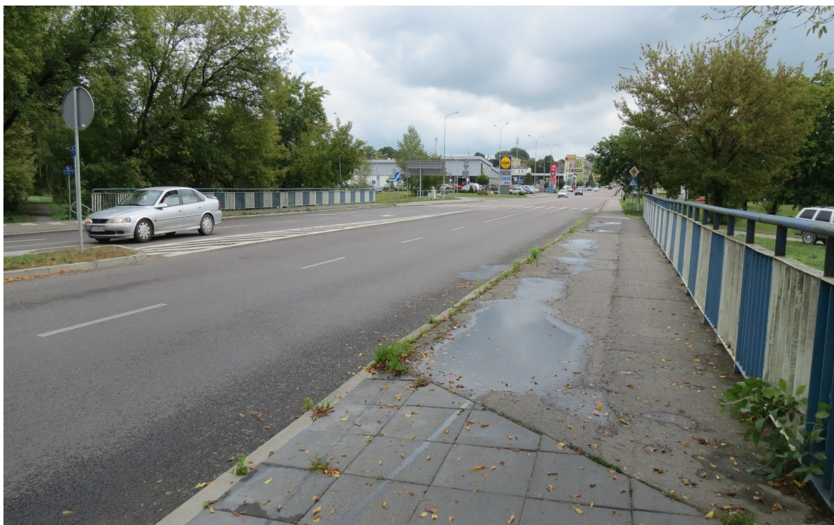
Fot. 26. Zanieczyszczenie i wegetacja roślinności na chodniku z masy bitumicznej.
