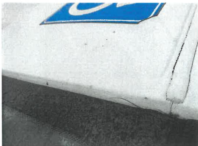
Ślady korozji na przedniej krawędzi dachu.
