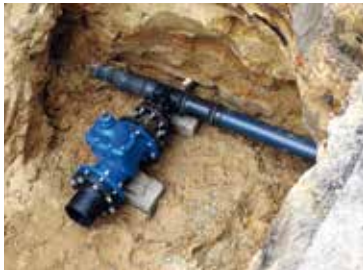
gk Przyłącze wodociągowe. Fot. UG
