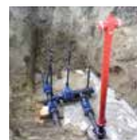
Wodociąg. Fot. UG
