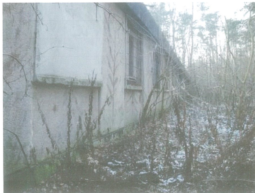
Elewacja zachodnia budynku - fragment. Aktualizacja. Stan techniczny zły.
