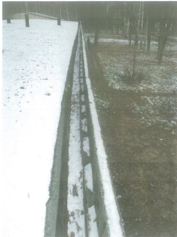
Aktualizacja. Dach części płn.- wsch. - fragment. połąć, fragment pokrycia, rynny PCV, attyka. Stan techniczny pasa rynnowego - zły.
