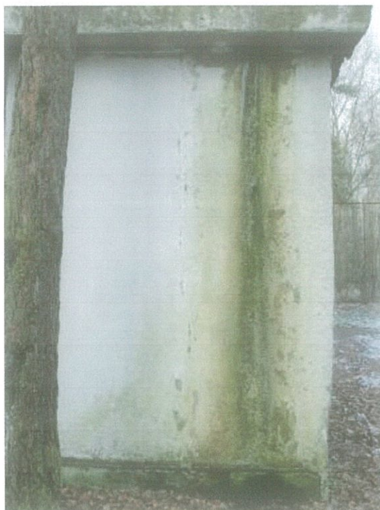
Elewacja wschodnia. Na elewacji widoczne ślady po przecieku i zawilgoceniu. Aktualizacja. Stan techniczny zły.
