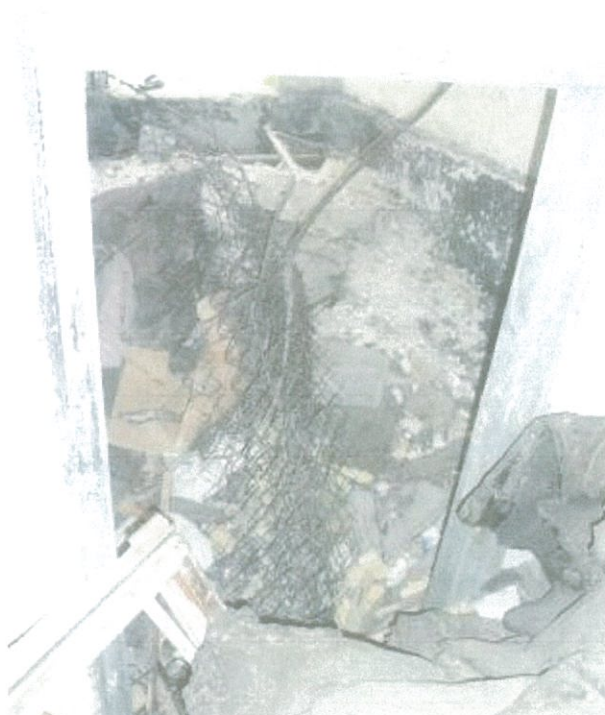
Aktualizacja. Pomieszczenia Uszkodzona konstrukcja i deskowanie podłóg. Stan techniczny podłóg zły.
