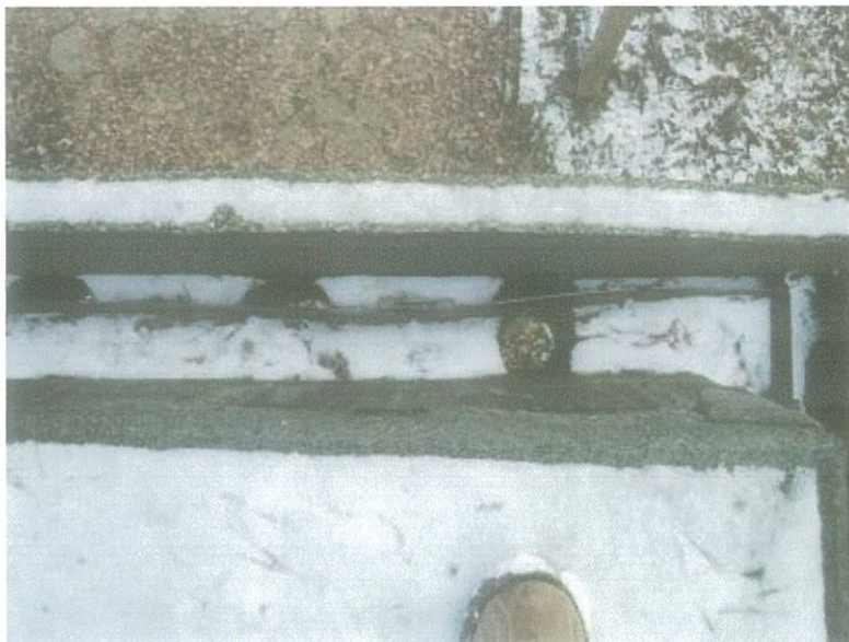
Aktualizacja.Dach części pld.- zach. - fragment. fragment pokrycia, obróbka papa, rynna PCV - wpust , attyka. Stan techniczny elementu - zły.
