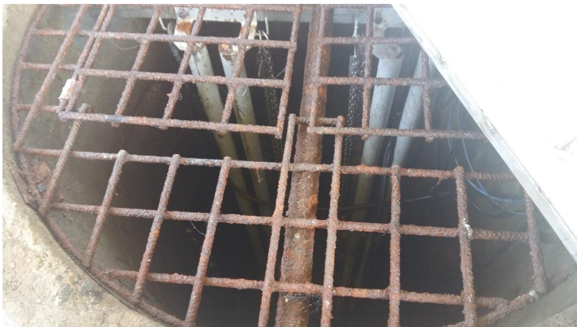
Rysunek 7 Widok wnętrza pompowni ścieków surowych [2]
