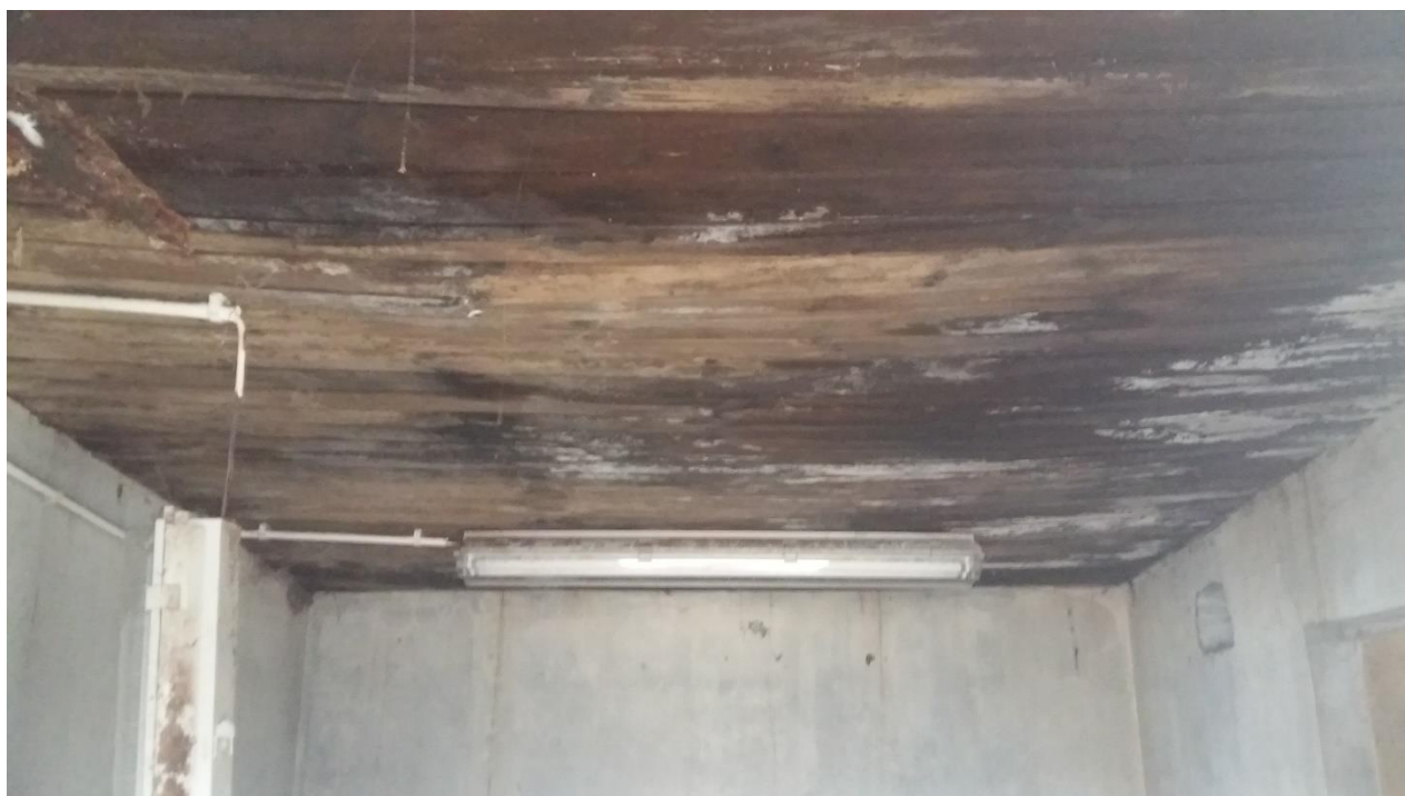
Rysunek 24 Uszkodzony strop/sufit budynku pompowni ścieków oczyszczonych
