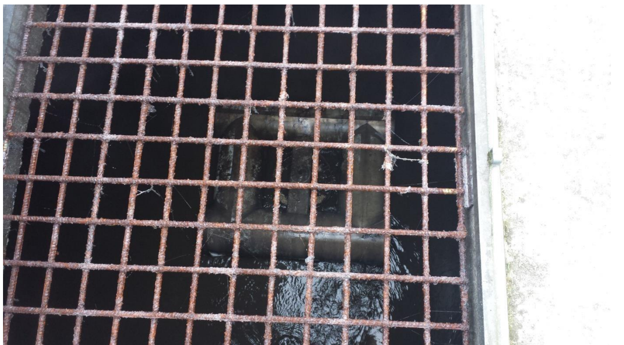
Rysunek 15 Widok dekantera do odprowadzenia ścieków oczyszczonych z reaktora biologicznego SBR [5]4
