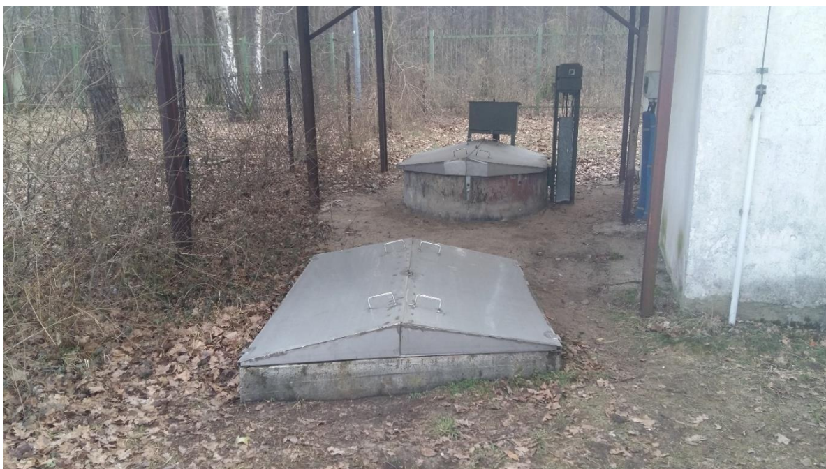
Rysunek 6 Widok na pokrywę studni zbiorczej z zasuwą [1] oraz pompownię ścieków surowych [2]
