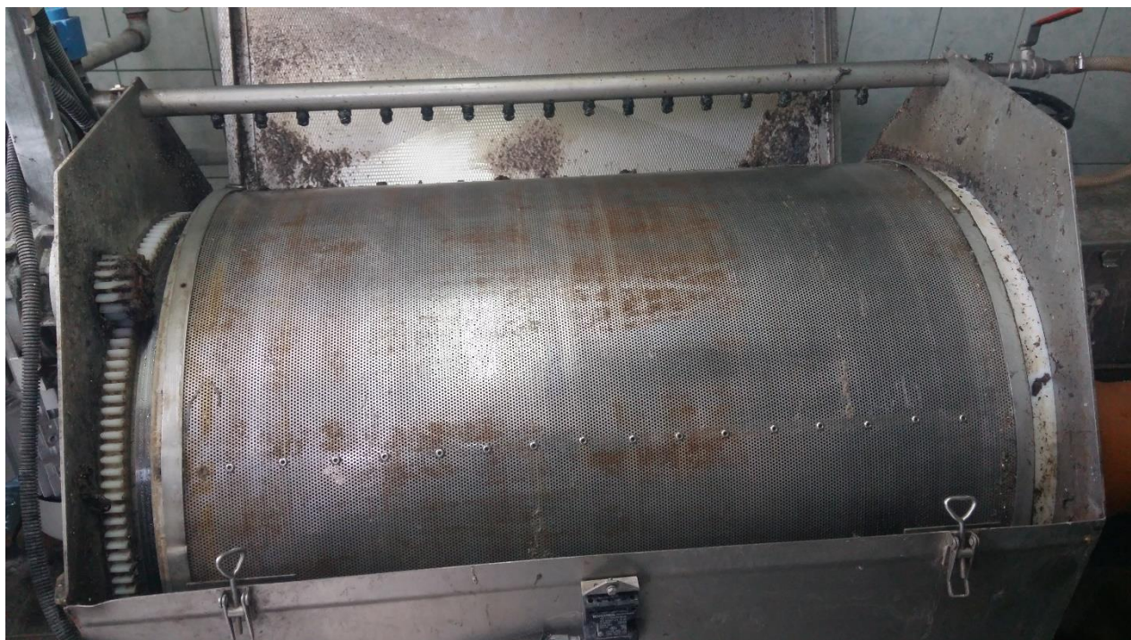
Rysunek 12 Widok na górną część sita bębnowego ROTO-SIEVE umieszczonego w pomieszczeniu sita [3]
