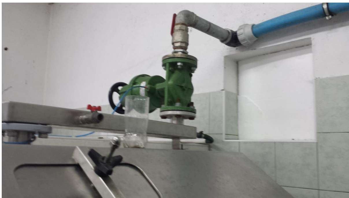
Rysunek 27 Widok układu zasilającego workownicę DRAIMAD w pomieszczeniu odwadniania osadów
