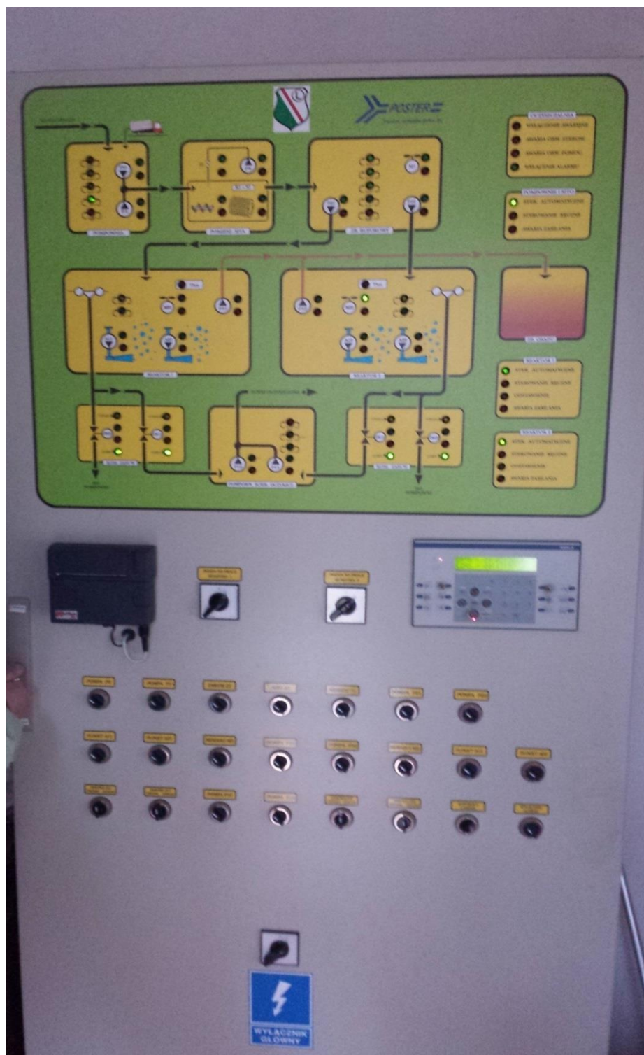
Rysunek 32 Tablica synoptyczna i szafa sterownicza OŚ „DĘBAK” w pomieszczeniu sterowni [11]
