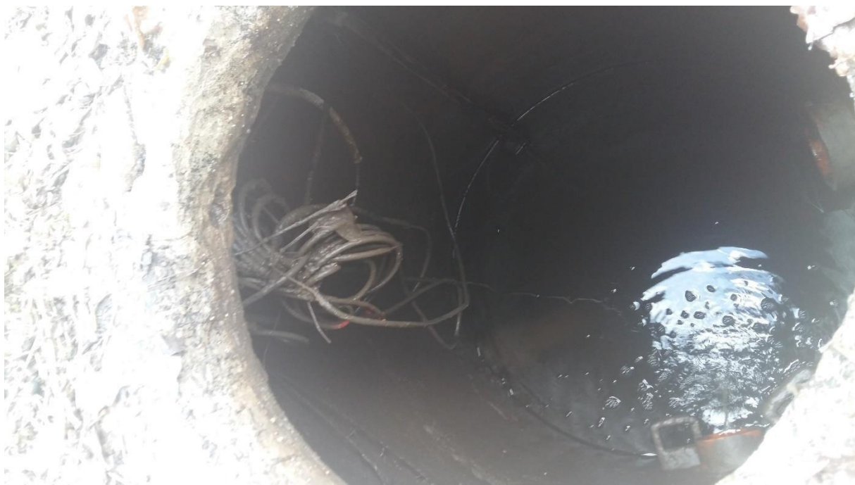
Rysunek 18 Studnia czerpalna ścieków oczyszczonych
