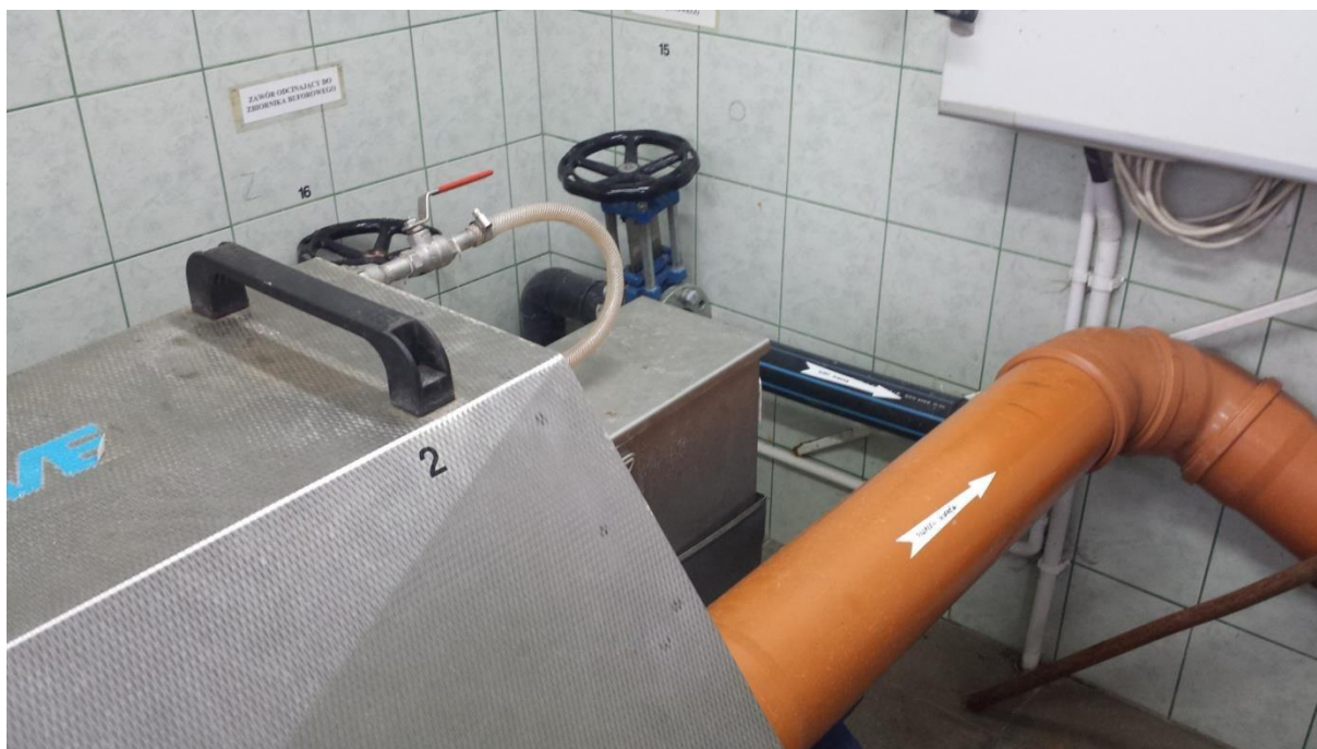
Rysunek 11 Widok na górną część sita bębnowego ROTO-SIEVE umieszczonego w pomieszczeniu sita [3] – odpływ ścieków oczyszczonych mechanicznie
