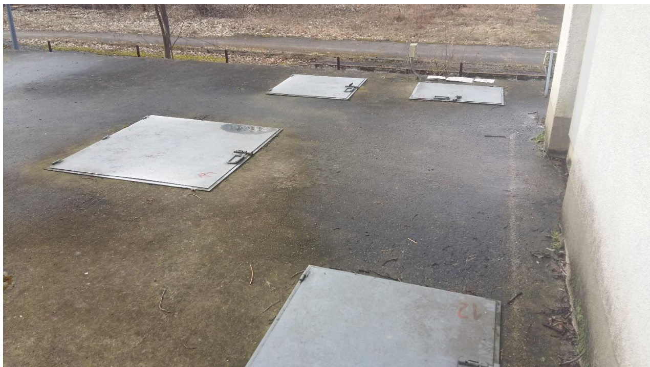
Rysunek 16 Widok górnej części reaktora biologicznego typu SBR oraz na dalszym planie przepompowni ścieków oczyszczonych [8]
