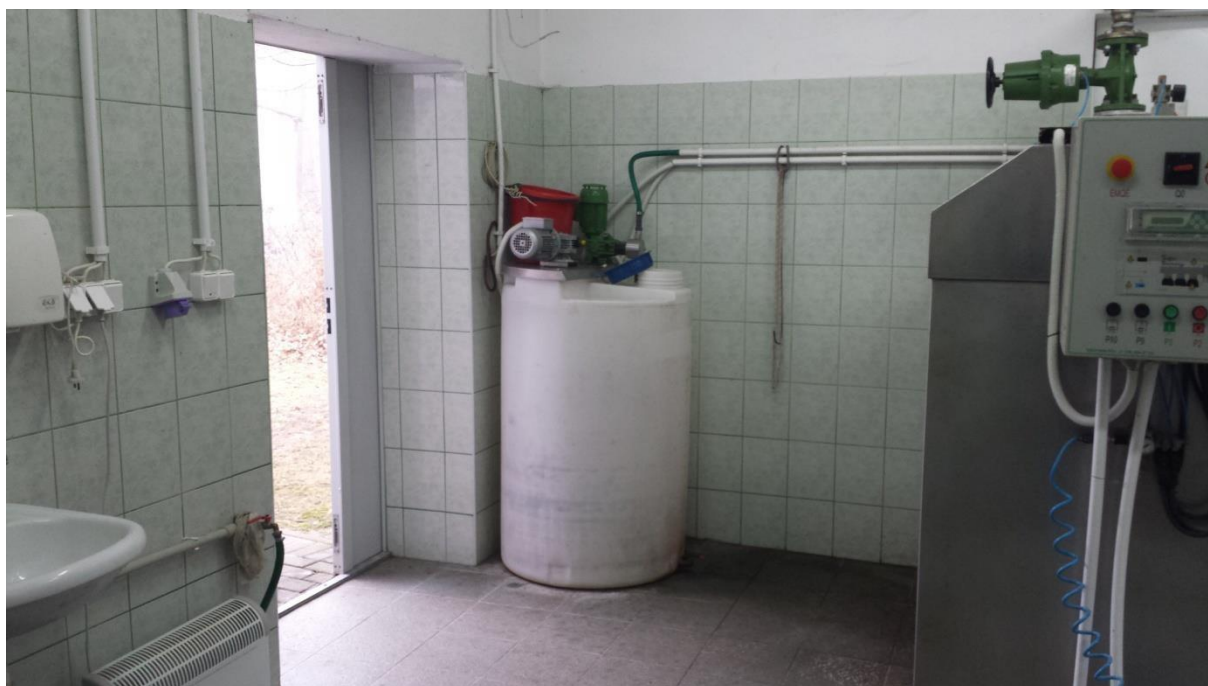
Rysunek 29 Pomieszczenie odwadniania osadów ściekowych – widok układu przygotowania i dozowania polielektrolitu
