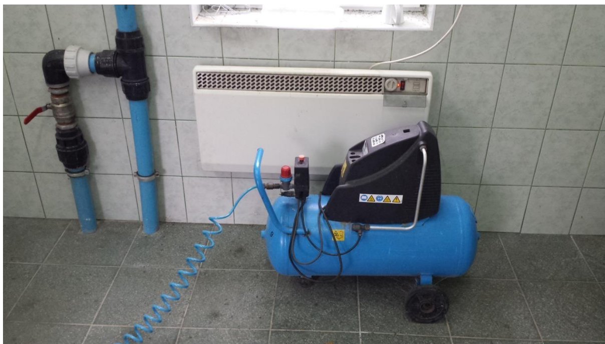
Rysunek 28 Widok sprężarki do zasilania układów pneumatycznych w budynku odwadniania osadu [9]
