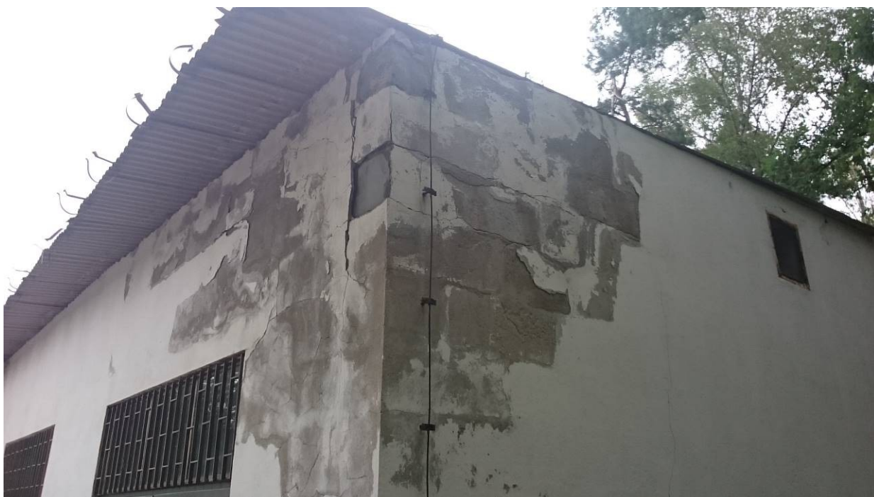
Zdjęcie nr 02 – Pęknięcia i odspojenia pustaków w narożniku od strony pld.-wsch.
