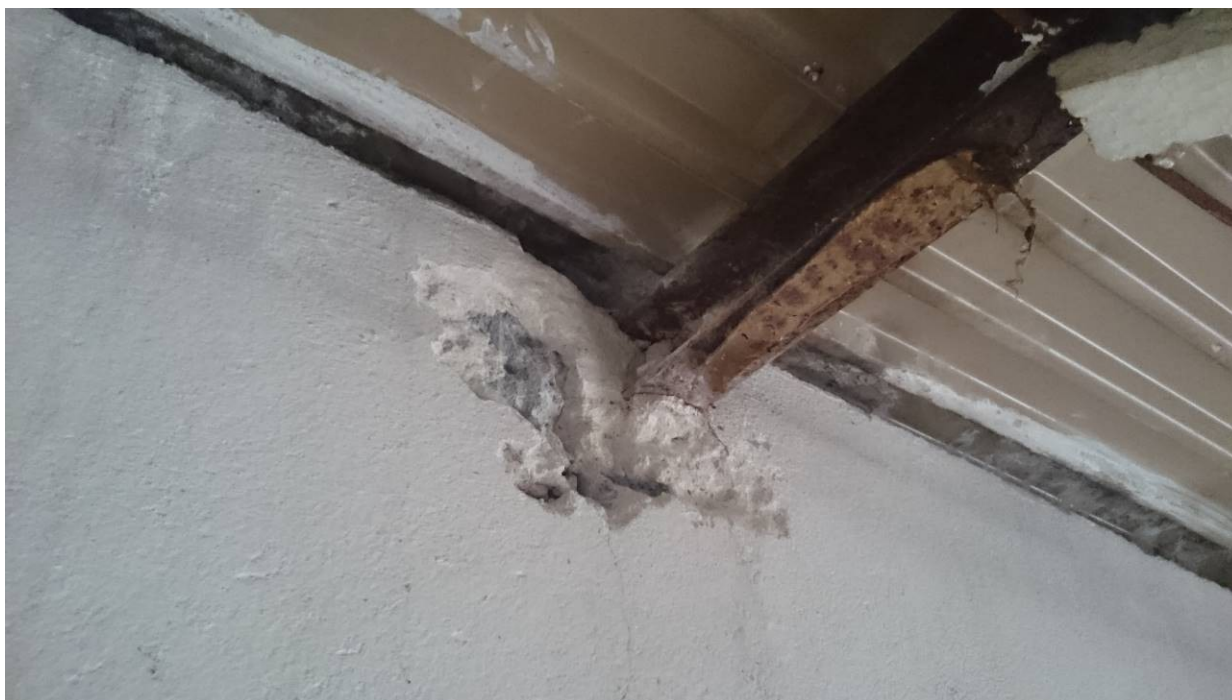
Zdjęcie nr 06 – Oparcie płatwi na ścianie poprzecznej. Korozja płatwi.
