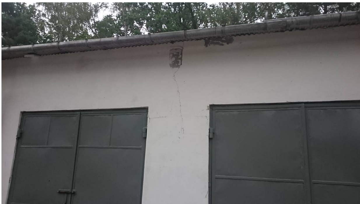
Zdjęcie nr 01 – Pęknięcia ściany nośnej od strony południowej.
