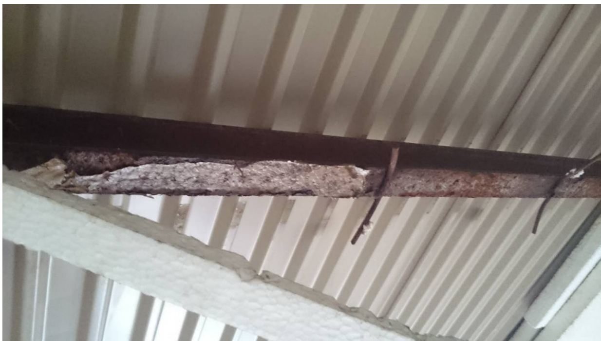
Zdjęcie nr 07 – Rozległa korozja płatwi.
