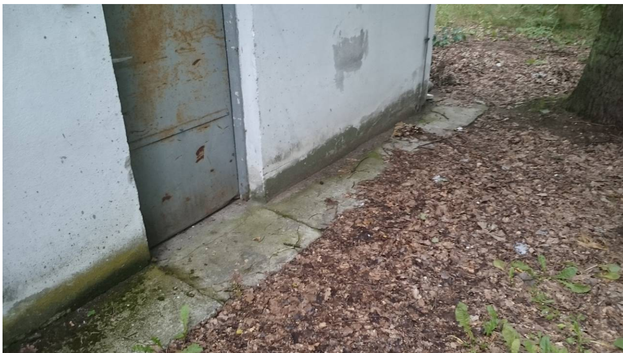
Zdjęcie nr 03 – Pęknięcia opaski betonowej wokół budynku.
