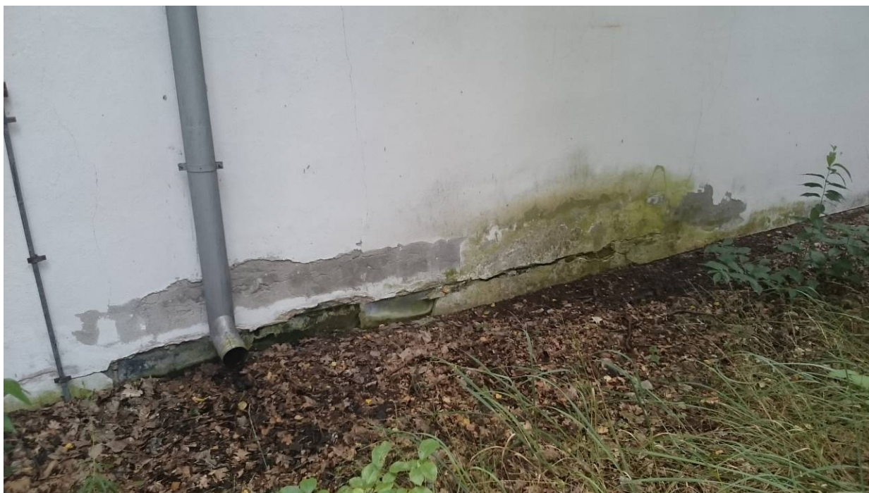
Zdjęcie nr 04 – Zawilgocenie ściany w strefie przyziemia. Zbyt bliskie odprowadzenie wody z połaci dachu do gruntu.
