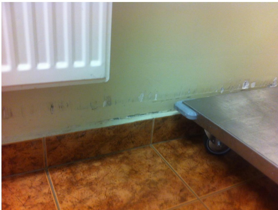
fot. 6.2.2 na zdjęciu widoczny fragment wózka transportowego oraz uszkodzenia ściany ponad cokołami.
