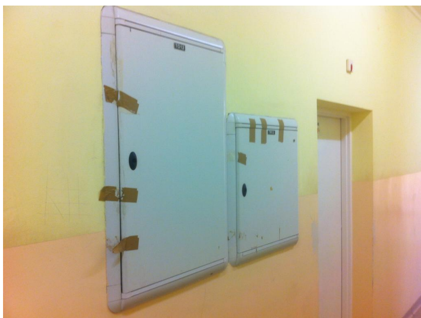
fot. .4.2.2.2 Zdeastrowane skrzynki rozdzielcze nie posiadają właściwego systemu zamknięcia.
