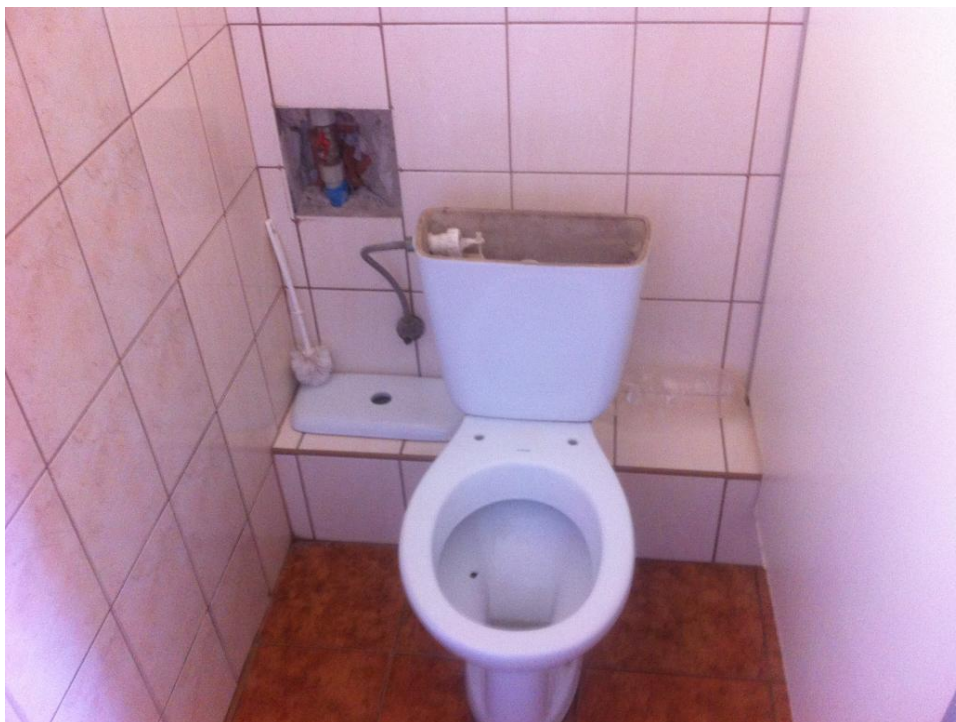
fot. 5.2.2.3 Zdewastowana miska ustępowa oraz niezabezpieczony otwór rewizyjny
