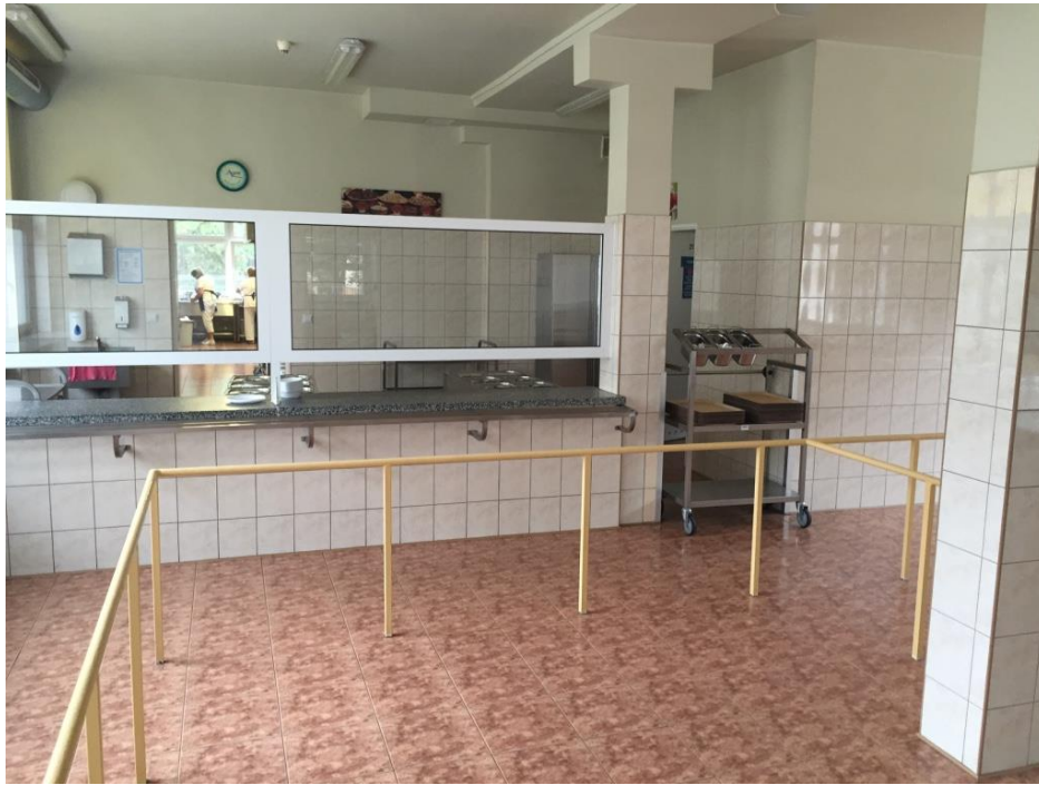
fot. 6.2.4 Stalowa bariera kierunkowa w pomieszczeniu wydawania posiłków – do usunięcia.
