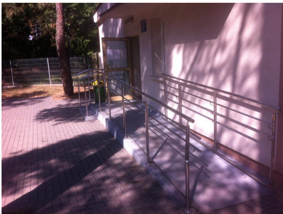
fot. 8.2.6 budynek nr 26 – rampa dla wózków, niestabilna balustrada do wymiany
