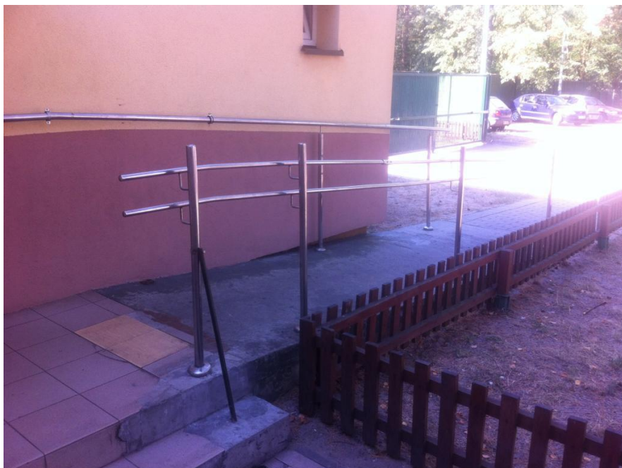
fol. 7.1.7 Rampa dla wózków – widoczne ślady degradacji powierzchniowej.
