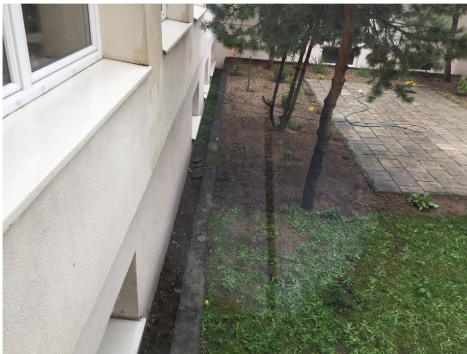
Fot.6.2.7 Patio wewnętrzne zagospodarowane zielenią: występuje problem odpływu wód deszczowych z kanałów przyokiennych
