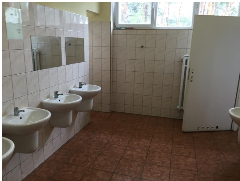
fot. 5.2.1.6 pomieszczenie węzła sanitarnego, widoczny zły podział przestrzenny
