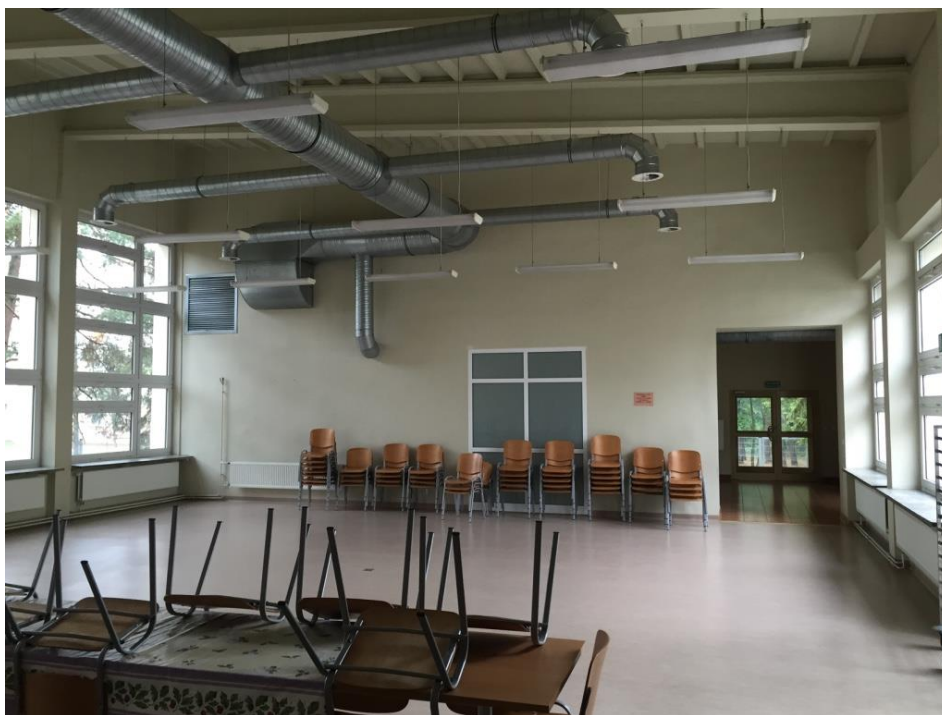
fot. 6.2.8 Widoczne przewody wentylacji mechanicznej w pom. Jadalni
