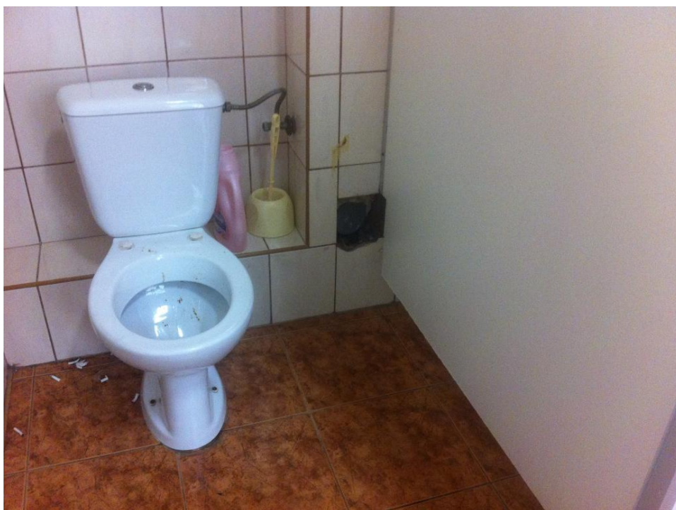
fot. 4.2.2.3 zdewastowana miska ustępowa z urwaną klapą zamykającą. Po prawej stronie widoczny zdewastowany otwór rewizyjny.
