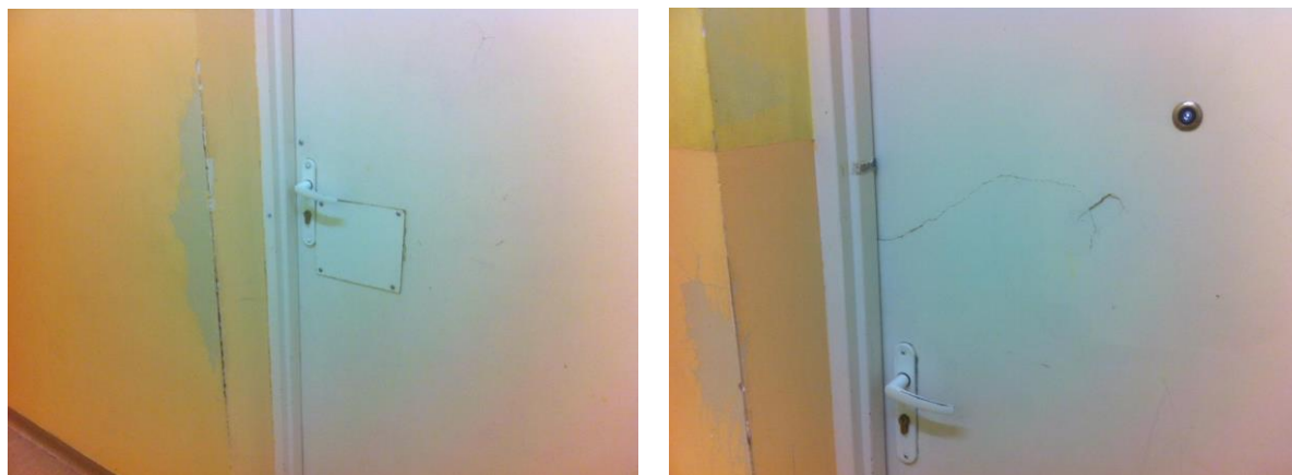
fot. 4.2.1.5 Dewastacja drzwi wejściowych do pomieszczeń mieszkalnych
