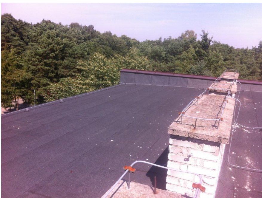
Fot 5.2.1.13 Widoczne odkruszenia spoiny z kominów wentylacyjnych.
