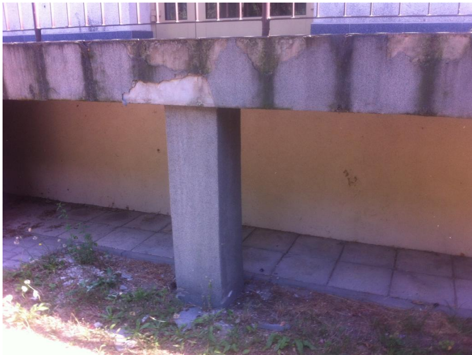
fot. 6.2.5 Widoczna degradacja warstwy tynku na rampie zaopatrzeniowej.
