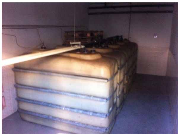
Foto. Pomieszczenie zbiorników na olej
