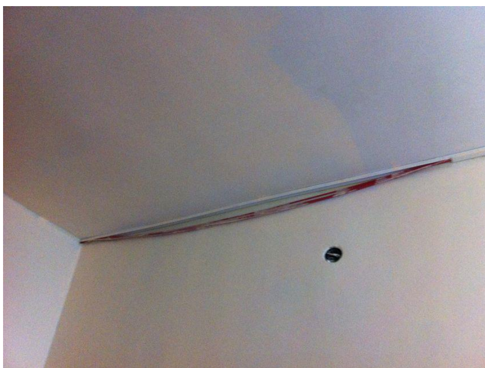
Foto. Fragment nieosłoniętej natynkowej instalacji sygnalizacji ppoż.
