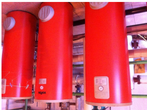
Foto. Pomieszczenie kotłowni
