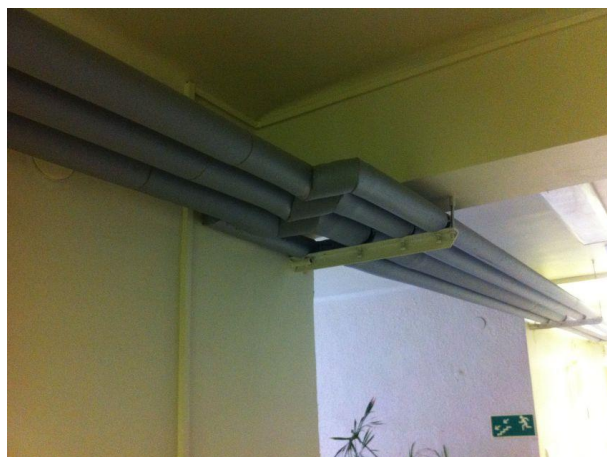
foto. Instalacje c.o. prowadzone podsufitowo
