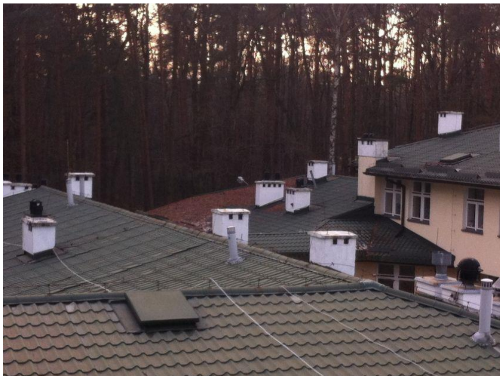
Foto. Na pierwszym planie widoczna nieszczelność w połaci dachowej (lewa dolna ćwiartka)
