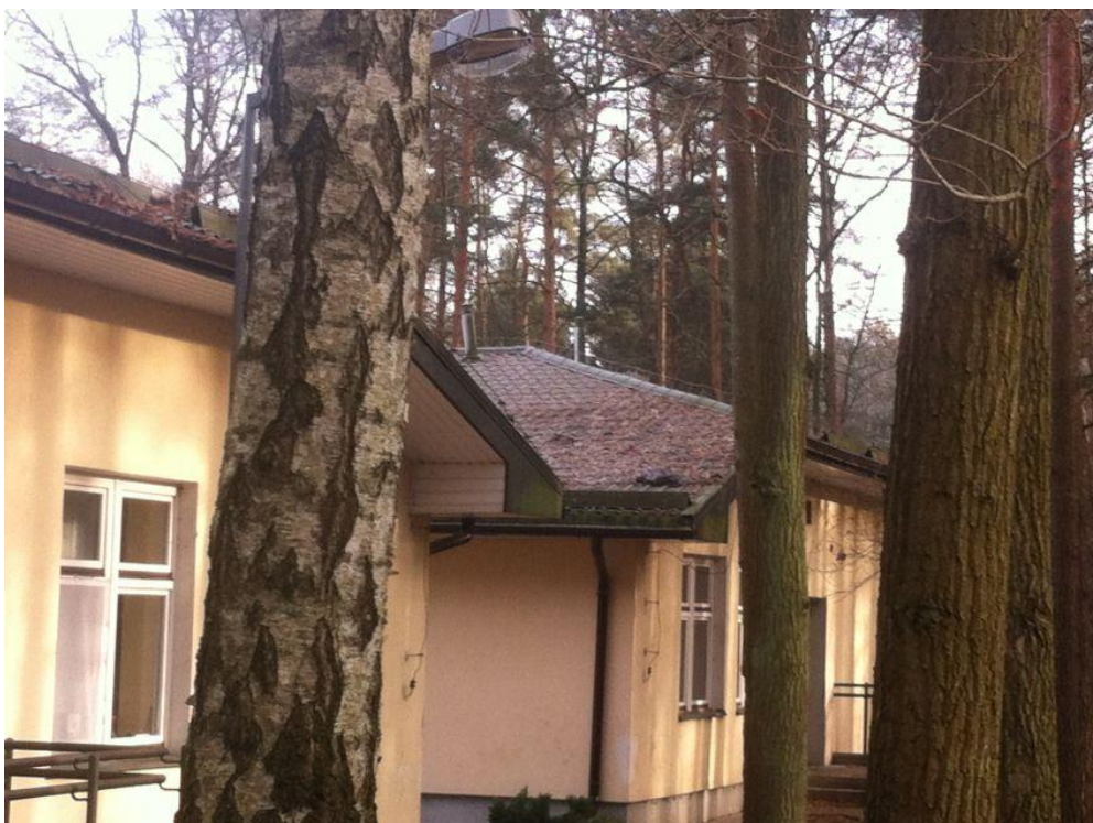
Foto. Listowie i igliwie zalegające na dachu budynku Hotelu Nowego
