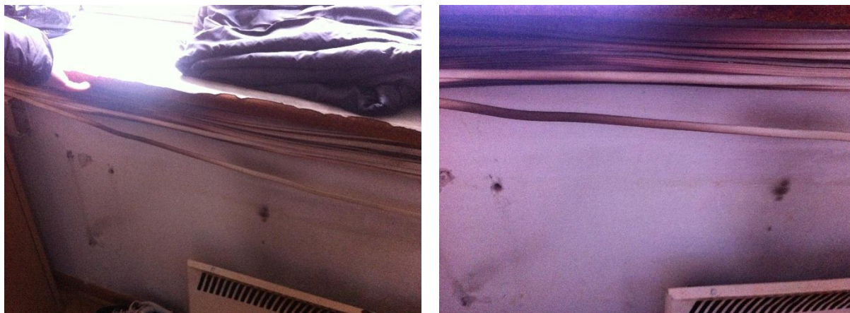
Foto. widoczne odkryte przewody instalacji elektrycznej, pociemniałe w wyniku nadmiernej temperatury od piecyka grzewczego, który został usytuowany w nieprzemyślny sposób
