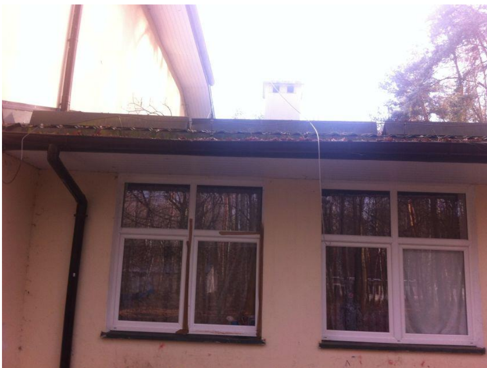
Foto. Widoczne na zdjęciu jedno z wielu miejsc, gdzie rynna utraciła swoją geometrię i spadek
