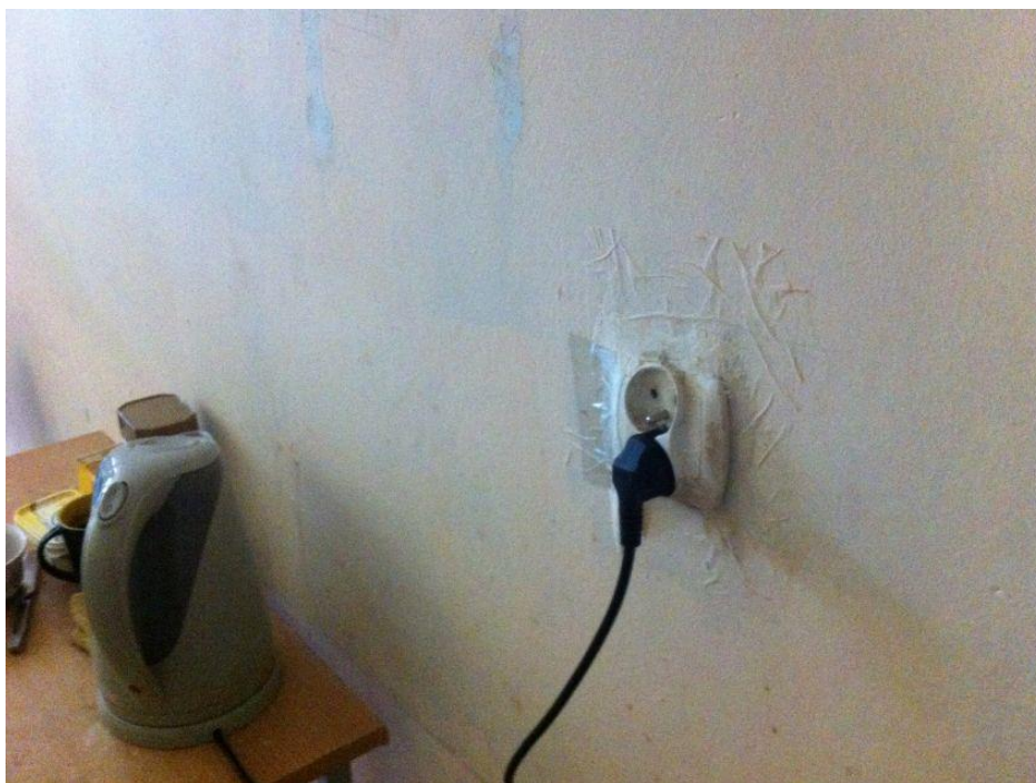
Foto. Stan instalacji elektrycznych w pomieszczeniach mieszkalnych
