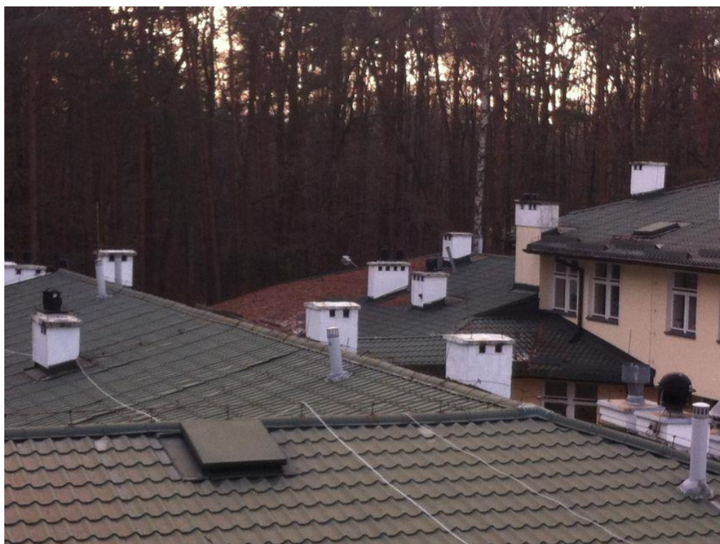
Foto. Na drugim planie widoczne listowie i igliwie zalegające na części dachu (Hotel Nowy)
