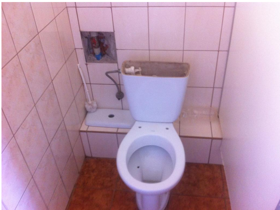
fot. 5.2.2.3 Zdeastowana miska ustępowa oraz niezabezpieczony otwór rewizyjny
