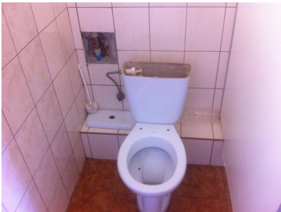
fot. 5.2.1.7 Zdewastowana miska ustępowa oraz niezabezpieczony otwór rewizyjny
