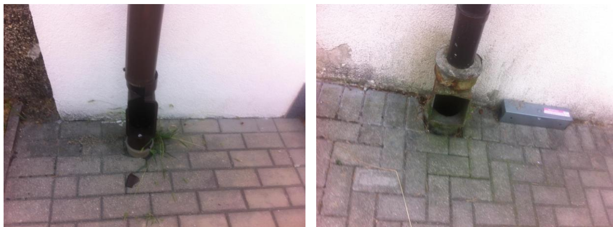
fot. 6.2.6 Widoczne otwory rewizyjne z tworzywa PVC lub stalowe: niejednorodny materiał powoduje rozszczelnianie
