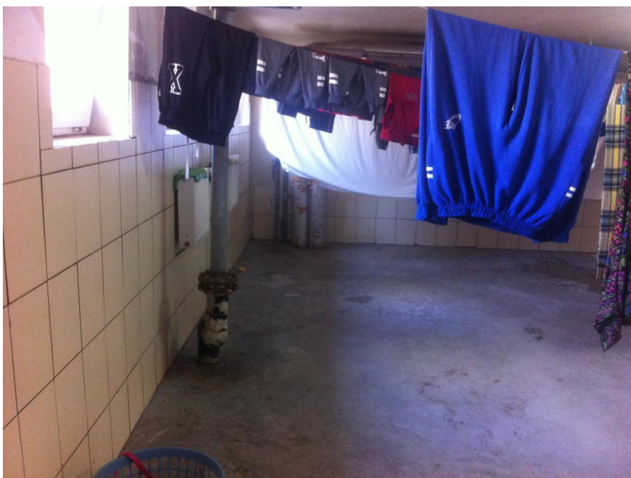
Fot 5.2.1.11 pomieszczenie pralnio-suszarni zlokalizowane w piwnicy.
