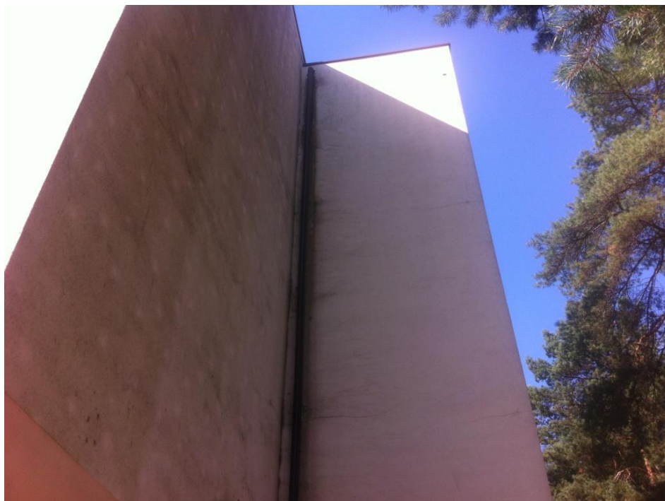
fot. 4.2.1.14 Widoczne wykwyty na elewacji – brak właściwego zabezpieczenia powierzchni tynku.
