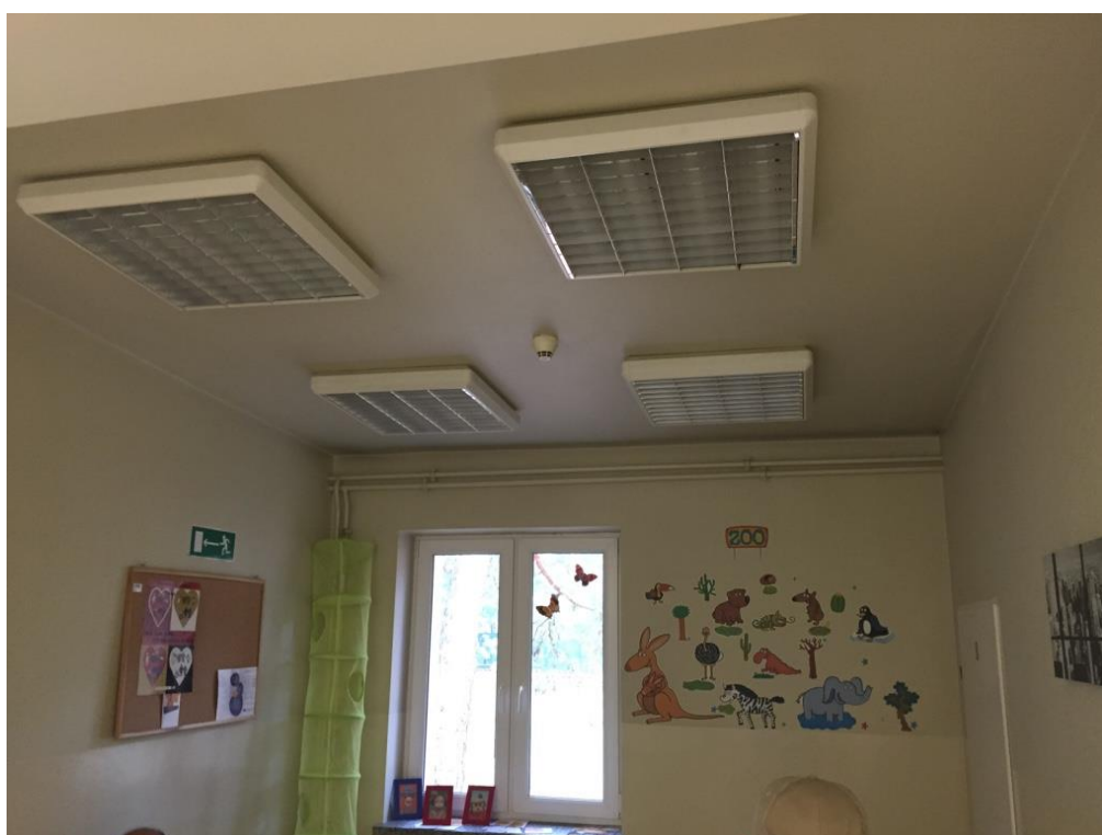
fot. 8.2.2 budynek nr 26 – oprawy oświetleniowe w części ambulatoryjnej.
