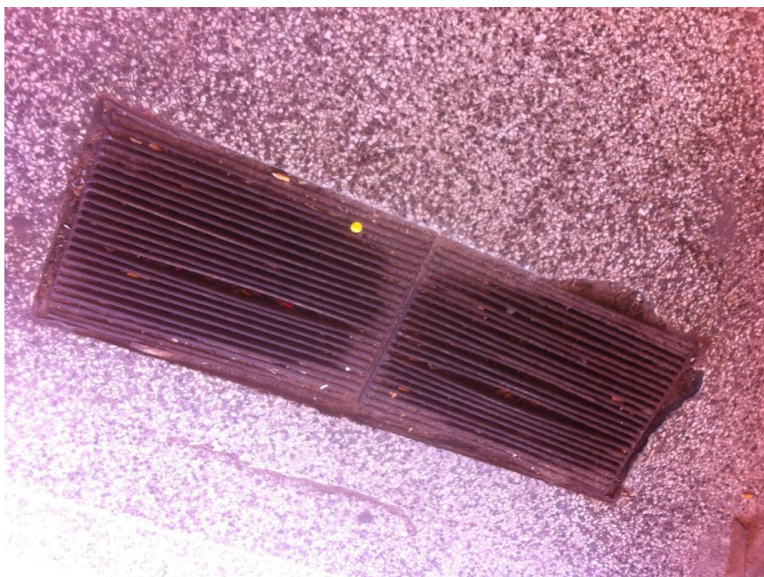
Fot 5.2.1.9 Widoczna wycieraczka zewnętrzna do wymiany
