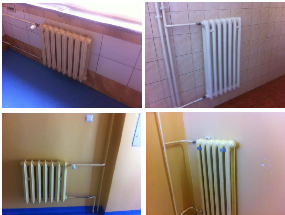
fot.5.2.2.1 Widoczne żeliwne grzejniki żebrowe starego typu w przestrzeniach ogólnodostępnych
