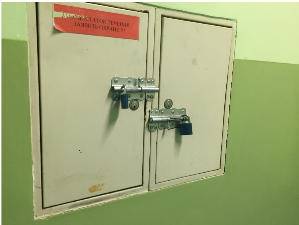
fot. 5.2.2.2 Zdewastowane skrzynki rozdzielcze nie posiadają właściwego systemu zamknięcia.
