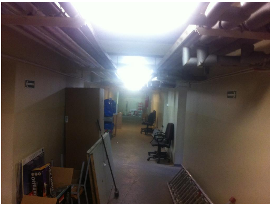
Fot 5.2.1.10 Korytarz komunikacyjny na kondygnacji piwnicznej zastawiony meblami co pogarsza warunki ewakuacji
