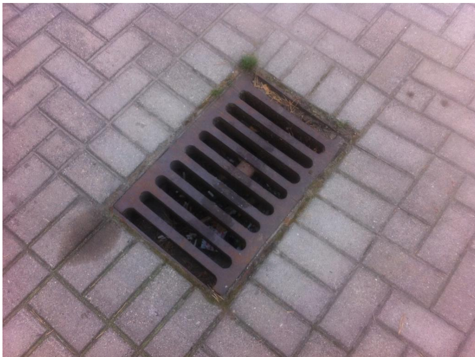
fot. 6.2.7 widoczny niedrożny odpływ kanalizacyjny
