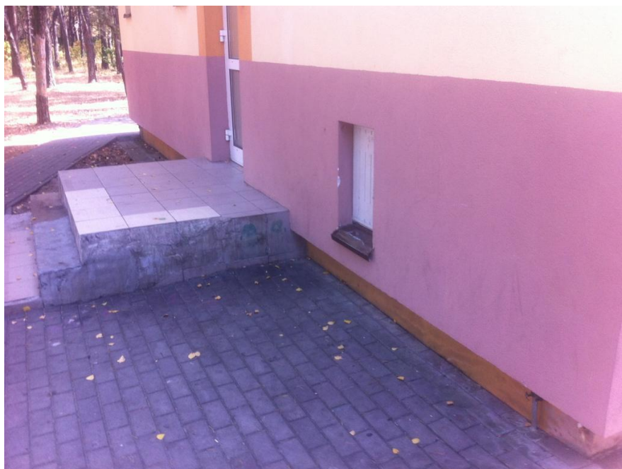
fot. 7.1.6 widoczne znaczne ślady zniszczenia na betonowym podeście wejściowym.
