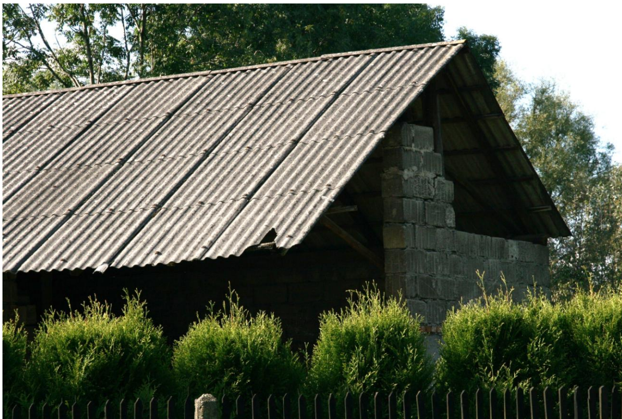
Rysunek 4 Dach budynku gospodarczego pokryty płytami azbestowymi falistymi w I stopniu pilności
