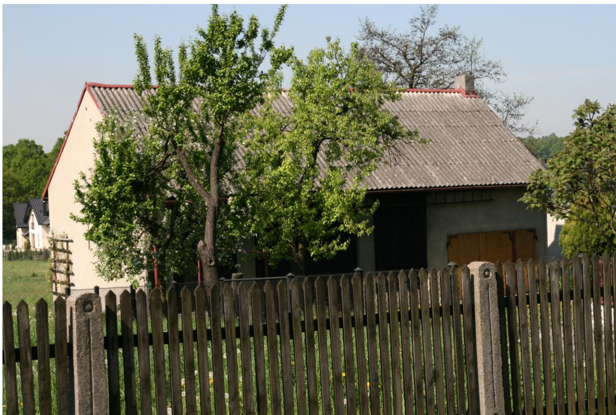
Rysunek 5 Dach pokryty płytami azbestowymi falistymi (II stopień pilności)
