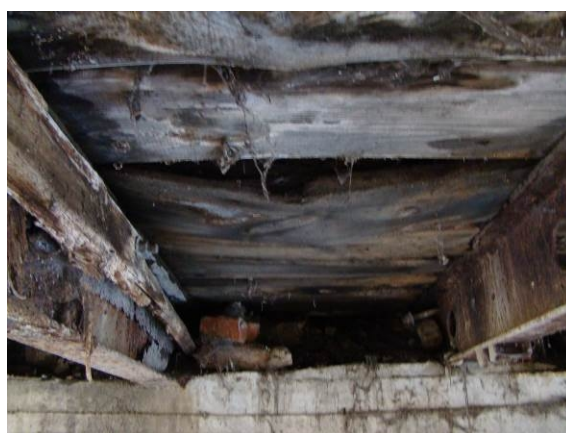
Fot. 4 Widok od spodu na ustrój nośny. Widoczna korozja drewna (gnicie) i złamanie bali drewnianych
