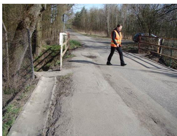
Fot. 10 Wjazd na obiekt od strony zachodniej. Spękania i deformacje nawierzchni na obiekcie i dojazdach.
