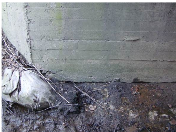
Fot. 7 Podpora po stronie wschodniej. Widoczne zanieczyszczenia koryta ciek.
