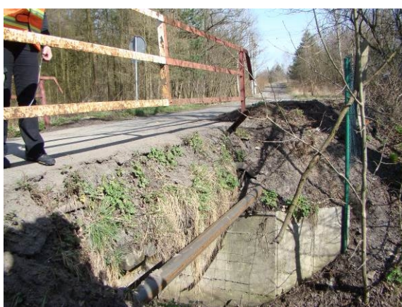
Fot. 9 Widok mostu od strony południowej. Wegetacja roślinności na obiekcie. Widoczne również urządzenie obce w rurze osłonowej.
