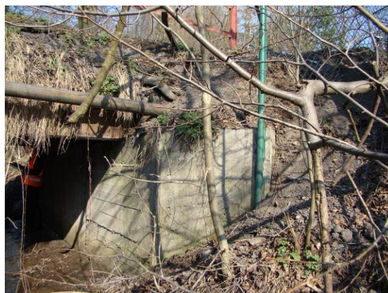
Fot. 8 Widok na podporę wschodnią. Wegetacja roślinności, brak umocnienia skarp.
