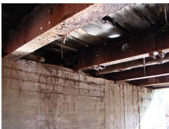
Fot. 3 Widok od spodu na ustrój nośny. Widoczne zawilgocenie bali drewnianych i korozja dźwigarów
