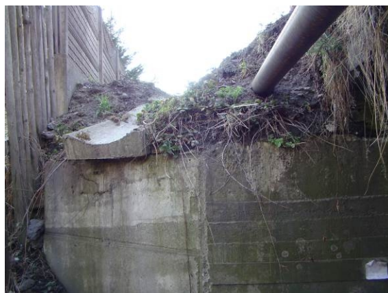
Fot. 6 Podpora po stronie zachodniej. Widoczne zacieki i wykwyty
