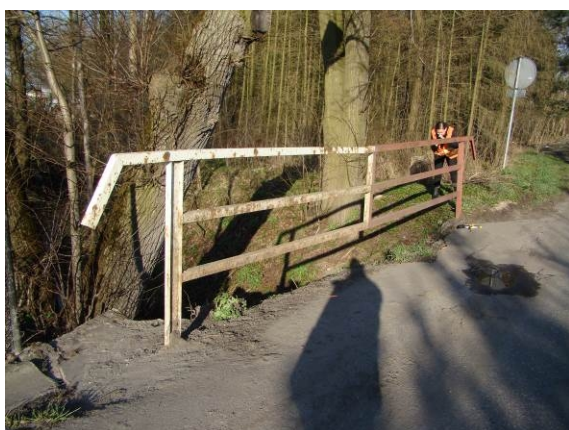
Fot. 11 Korozja i deformacja balustrady stalowej
