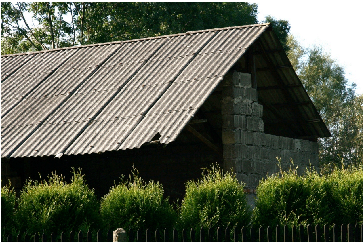
Rysunek 10 Dach budynku gospodarczego pokryty płytami azbestowymi falistymi w I stopniu pilności Fotografia Agnieszka Chylak
