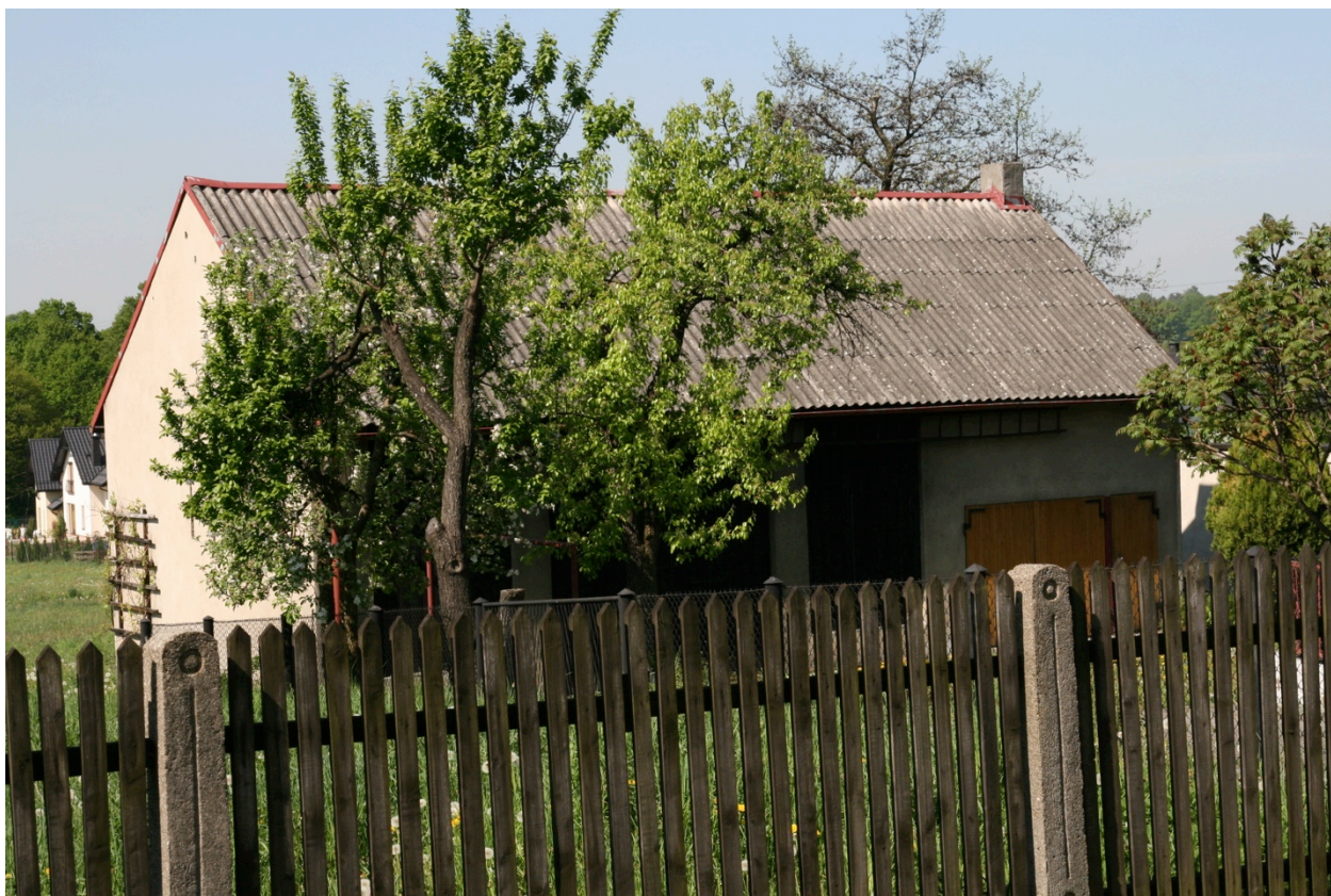
Rysunek 11 Dach pokryty płytami azbestowymi falistymi (II stopień pilności)
