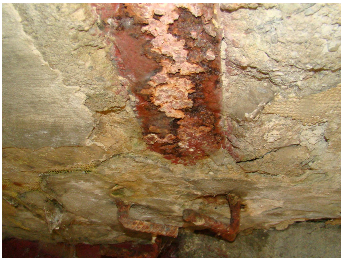
Fot.22 Widok spodu płyty pomostowej – widok prętów kotwiących słupka bariery ochronnej
