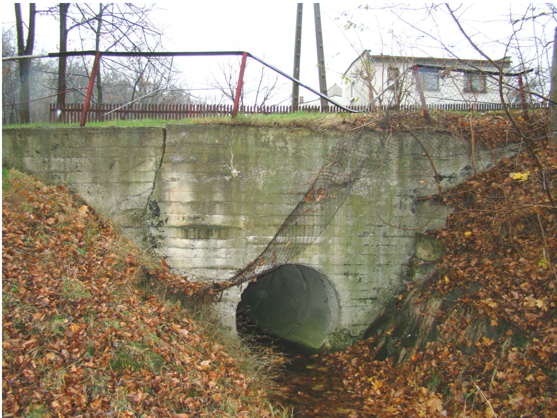
Fot.10 Istniejący przepust rurowy (obok przedmiotowego mostu) od strony południowej. Widok wlotu od strony północno-zachodniej
