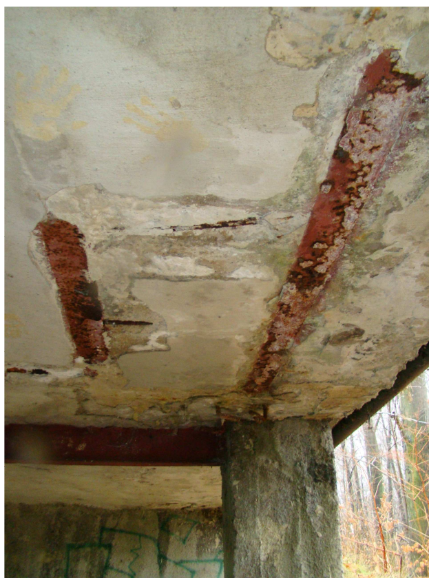
Fot.20 Widok w kierunku północnym - spód płyty pomostowej – część od strony wschodniej
