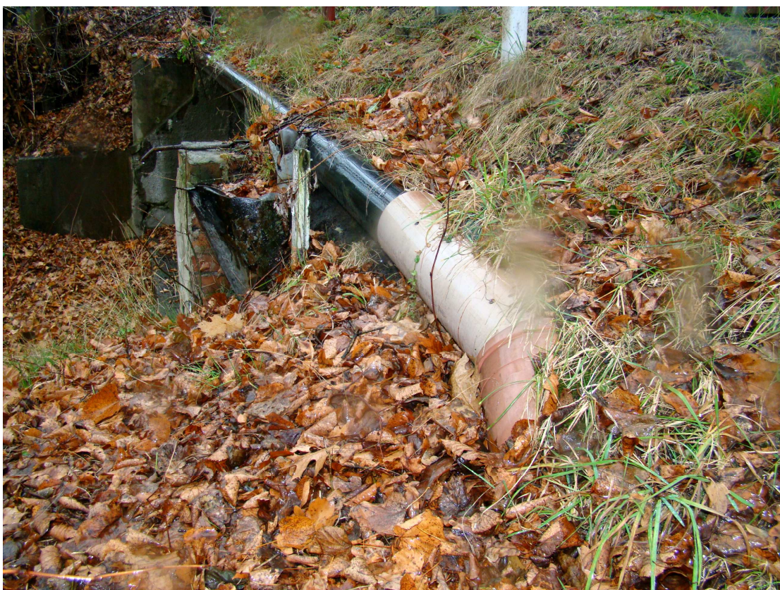
Fot.18 Istniejąca rura PVC (prawdopodobnie osłony kablowej) od strony południowo-wschodniej. Widok od strony północno-wschodniej
