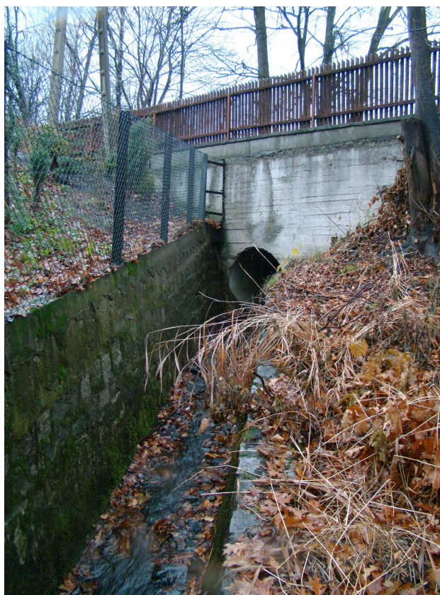
Fot.12 Istniejący przepust rurowy (obok przedmiotowego mostu) od strony południowej. Widok wylotu od strony wschodniej
