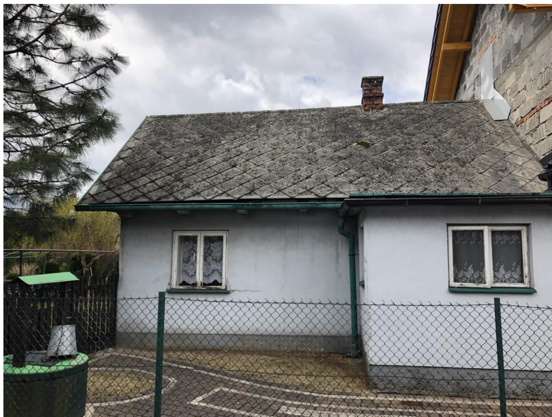
Rysunek 11 Wyroby zawierające azbest na dachu budynku mieszkalnego
