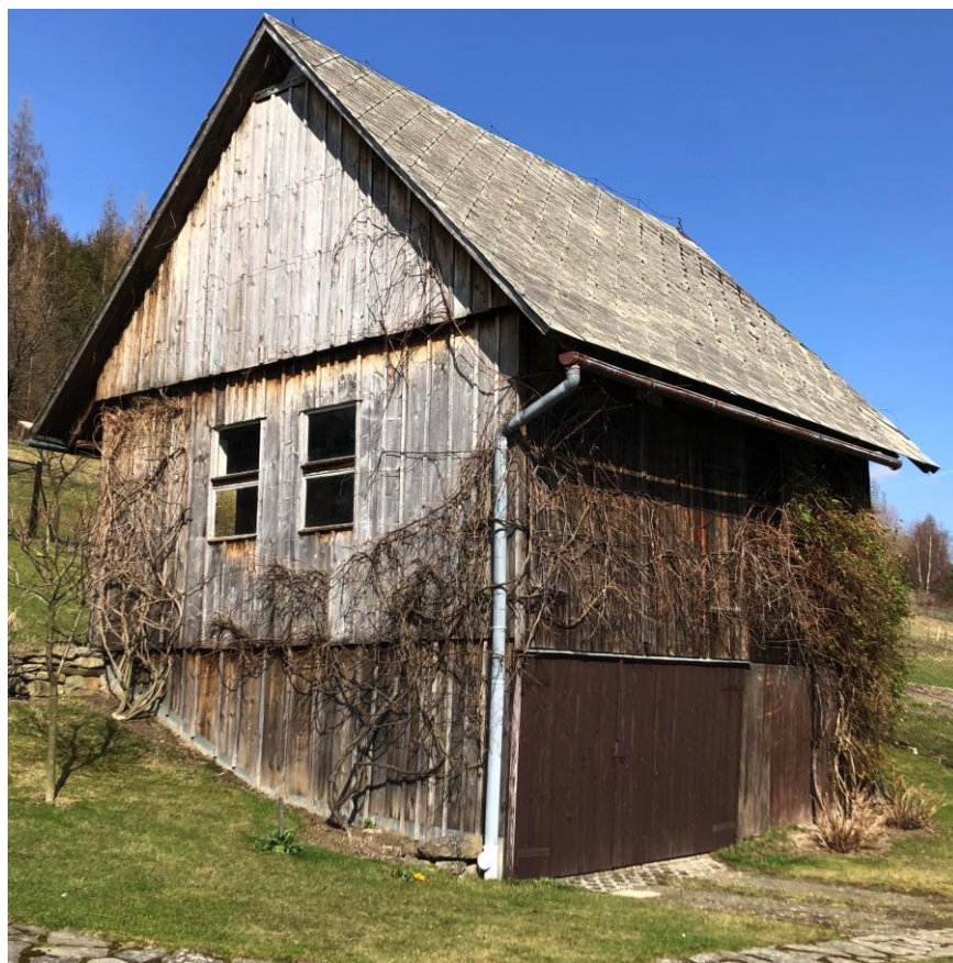
Rysunek 12 Wyroby zawierające azbest na dachu budynku gospodarczego
