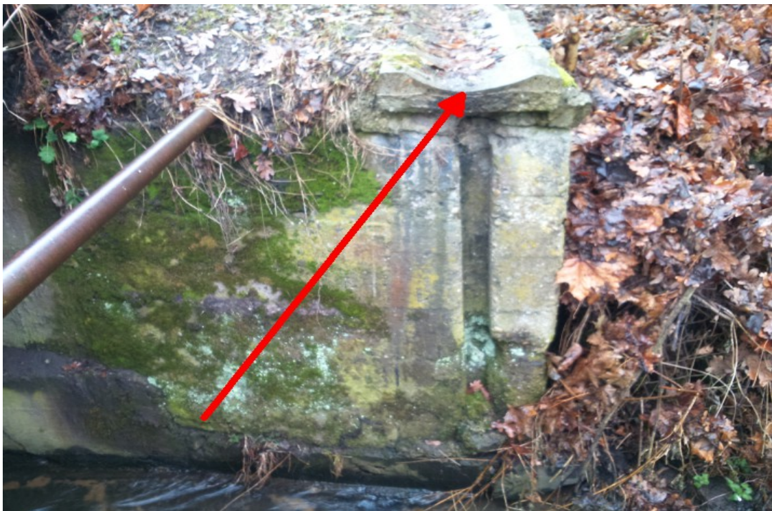
Zdjęcie 3.8: Spływ wody z jezdni
