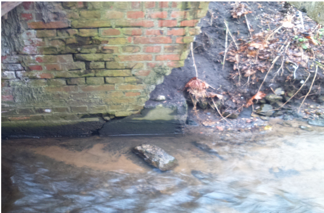
Zdjęcie nr 3.5 : Uszkodzony przyczółek i umocnienie skarpy
