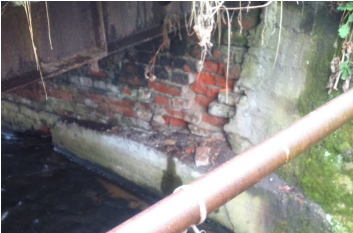
Zdjęcie nr 3.7 : Wykruszony fragment przyczółka ceglanego
