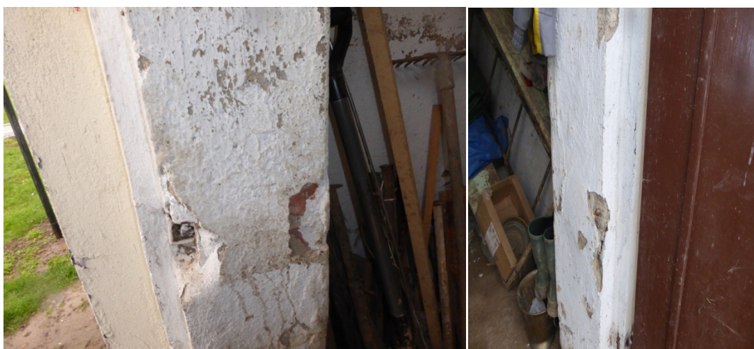
Widoczne miejsca uszkodzeń wnętrza obiektu. Spękania oraz ubytki w tynku.
