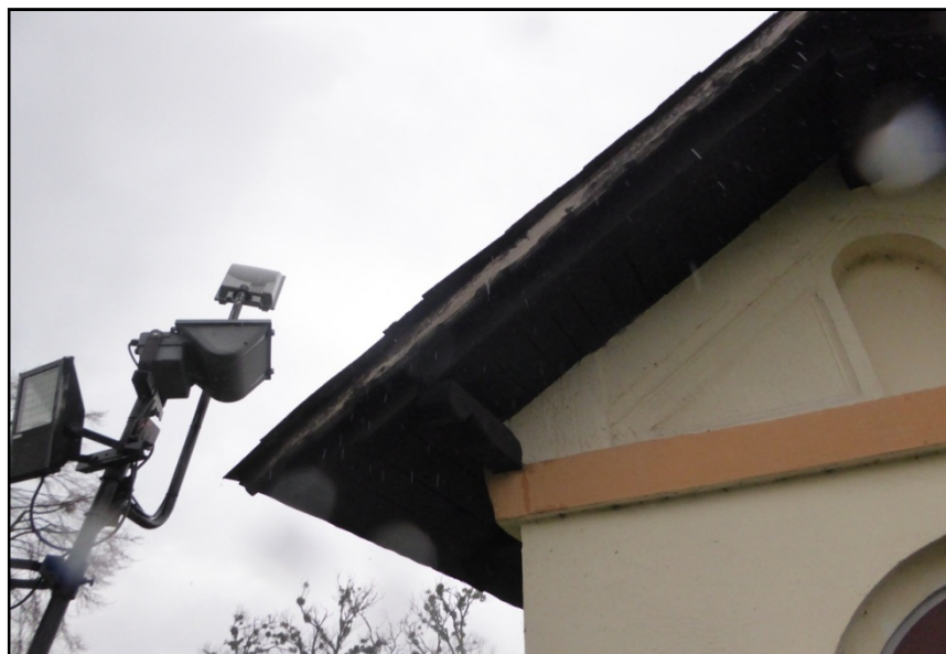
Destrukcja niektórych elementów drewnianych dachu (drewniane wiatrownice)
