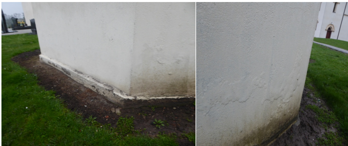
Widoczne miejsca uszkodzeń elewacji. Ślady zawilgocenia w dolnych partiach ścian.
