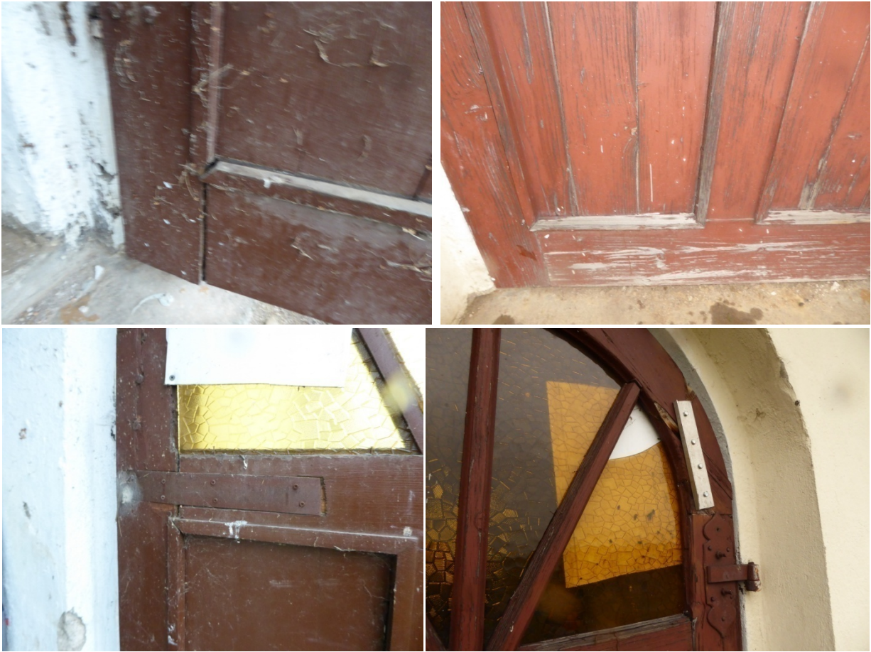
Widoczne miejsca uszkodzeń elementów drewnianych drzwi.
