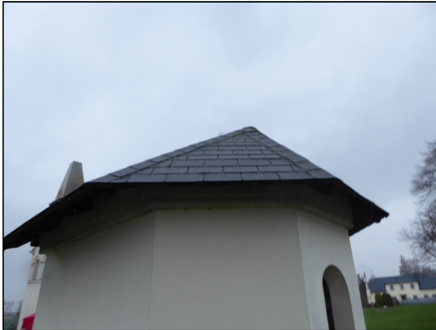
Destrukcja pokrycia dachu o małym stopniu zużycia.
