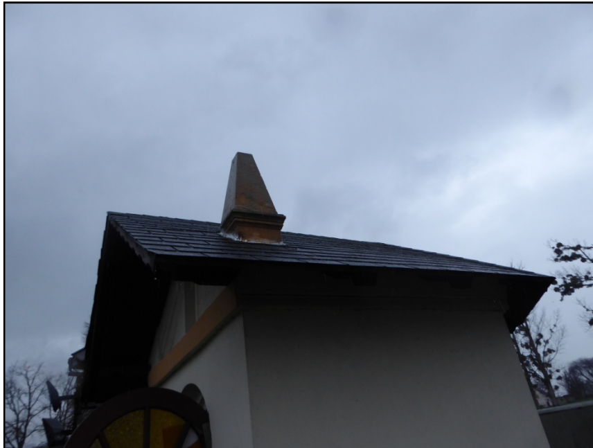
Destrukcja tynku sterczyn, widoczne luźne elementy, spękania elementów betonowych oraz ubytki.
