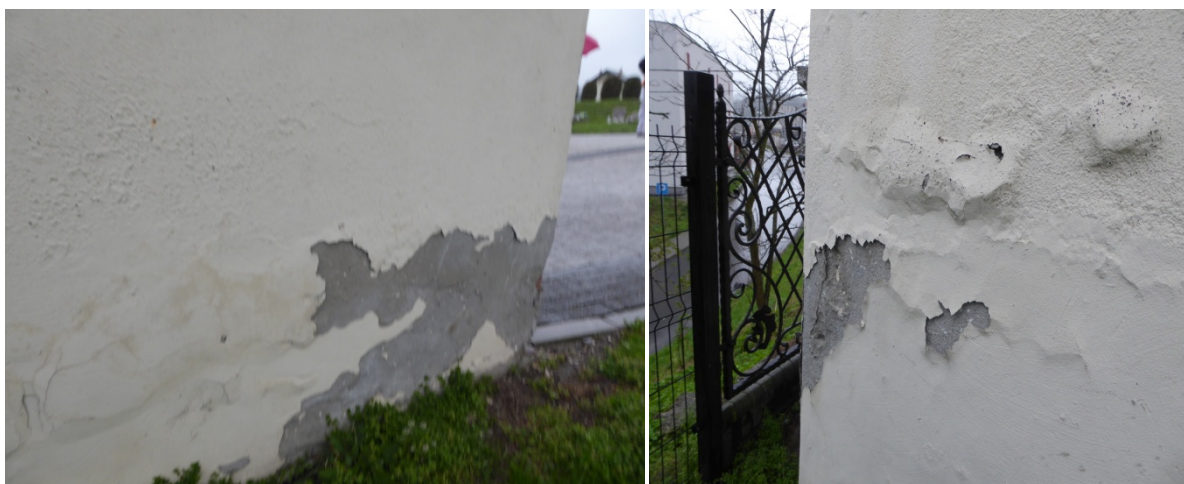
Widoczne miejsca uszkodzeń elewacji.
