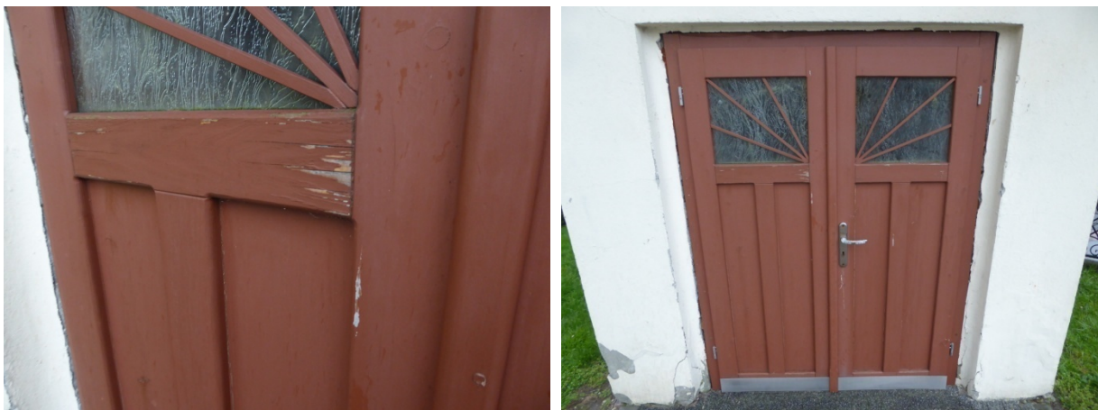
Widoczne miejsca uszkodzeń elementów drewnianych drzwi.
