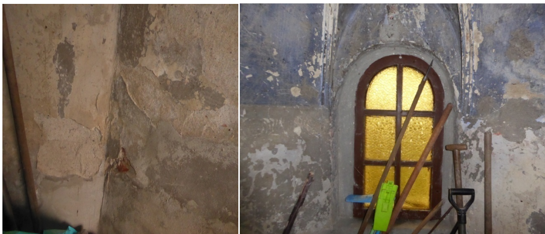
Widoczne miejsca uszkodzeń wnętrza obiektu. Spękania oraz ubytki w tynku.
