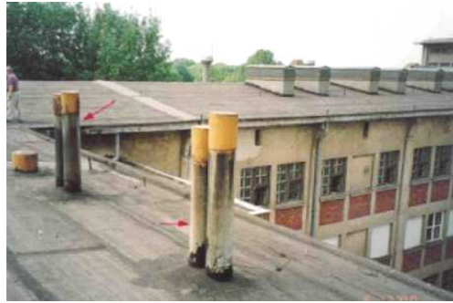
Zdjęcie 9 Instalacja- przewody wentylacji grawitacyjnej w obiekcie przemysłowym wykonana z rur azbestowo-cementowych
