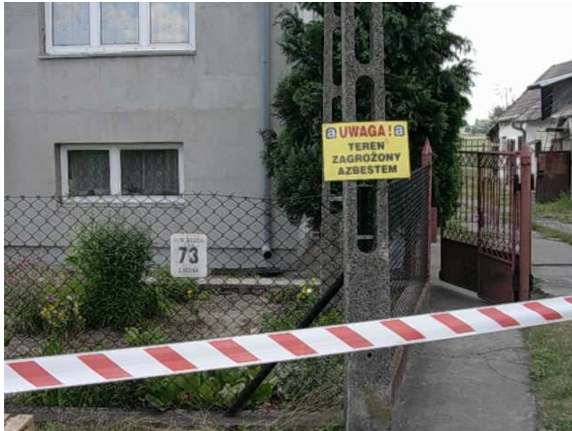
Zdjęcie 20 Prawidłowy sposób zabezpieczenia terenu zagrożonego azbestem.
