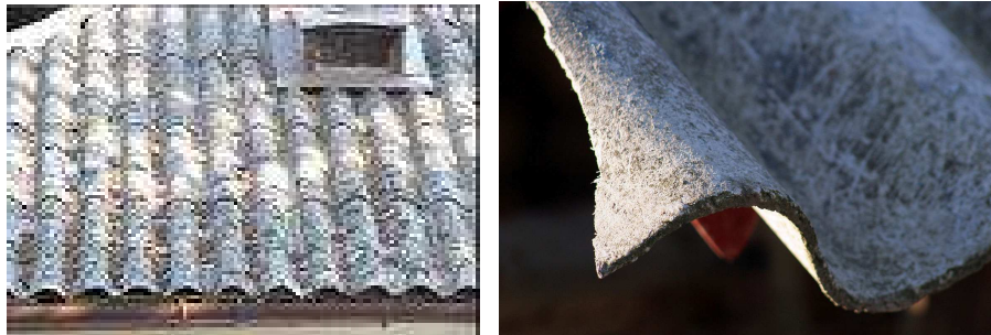
Zdjęcie 6 Płyty faliste azbestowo-cementowych
