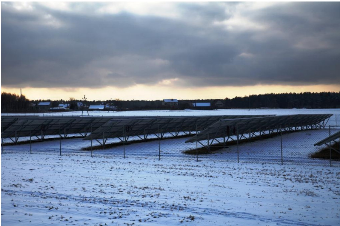
Zdjęcie 12, Zdjęcie 13. Druga w Polsce instalacja fotowoltaiczna „ Czarniejowice ” o mocy 1,2MW (woj. Łódzkie) oddana do użytkowania w lutym 2013r. (Źródło: Projekt - Solartechnik).
