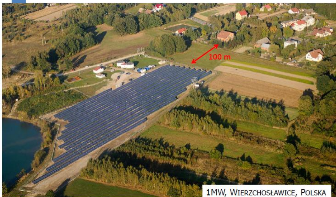
Zdjęcie 19. Pierwsza w Polsce instalacja fotowoltaiczna „ Wierchosławice ” k/Tarnowa. Źródło: UG Wierchosławice
