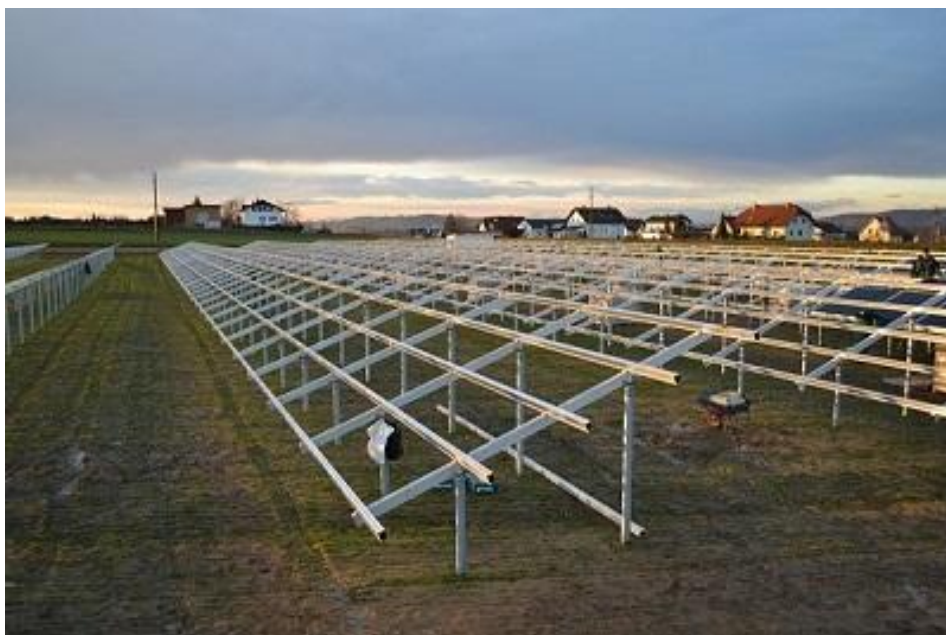
Zdjęcie 14. Szkielety przed montażem paneli, farma solarna NIENBURG 4 MW (Niemcy) (Remor Solar)
