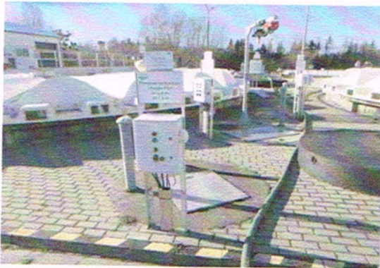
Pompownia PS1 i PS2
