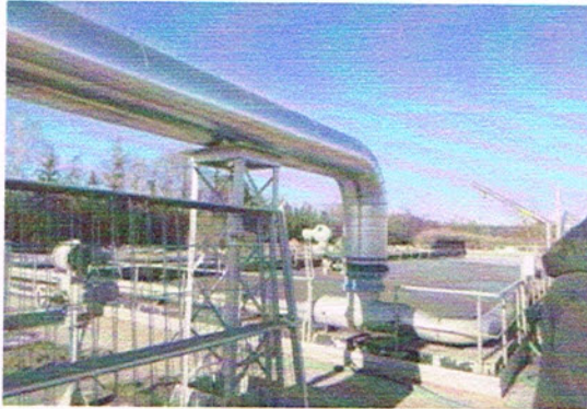
Rurociąg sprężonego powietrza
