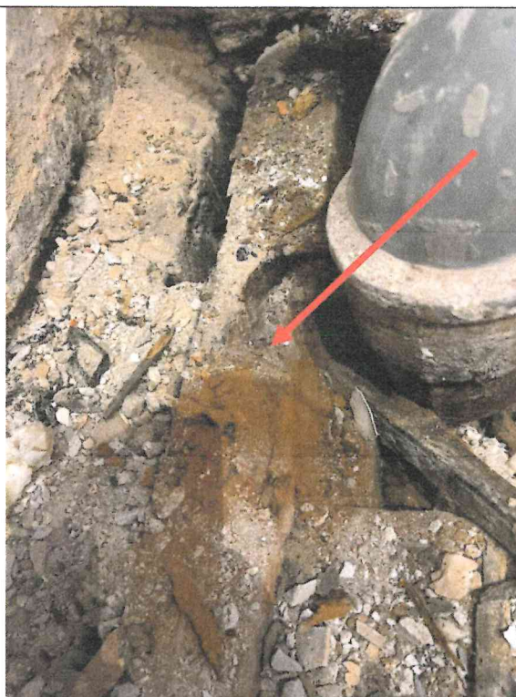
Fot. 8- Zbutwiał fragment belki stropowe w obrębie odpływu kanalizacji sanitarnej i podparcia na murze
