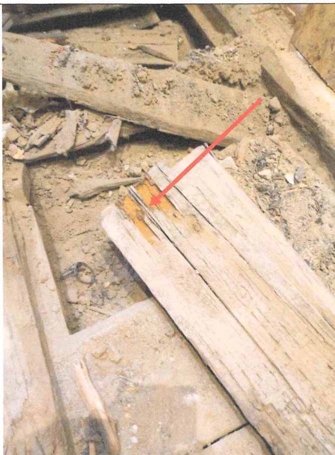
Fot. 4- Skorodowany fragment desek stropowych
