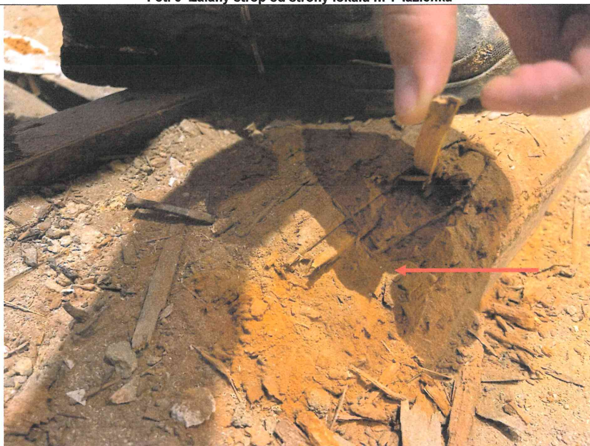
Fot. 7- Zbutwiały fragment belki stropowej
