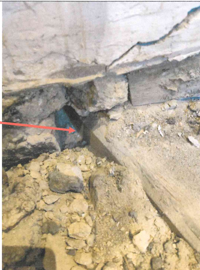
Fot. 9- Przejście belki pod ścianą działową między łazienką a korytarzem mieszkania 10.
