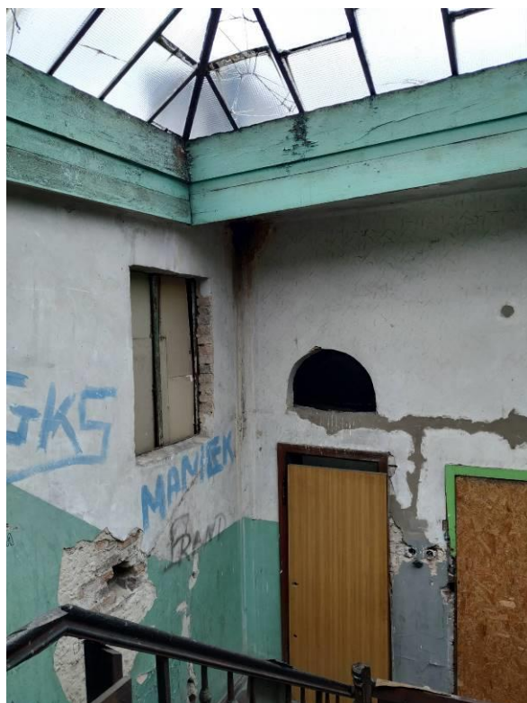
Rys. 11 Ubytki cegieł w ścianie na klatce oraz ubytki tynku, brak stolarki okiennej oraz drzwiowej w ścianach, spękania oszklenia w świetliku
