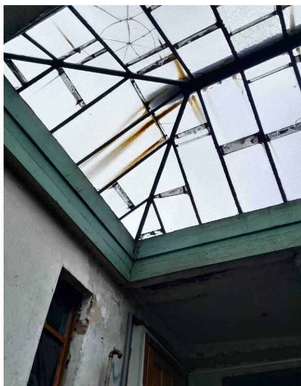
Rys. 12 Korozja stalowej konstrukcji świetlika oraz miejscowe pęknięcia oszklenia świetlika
