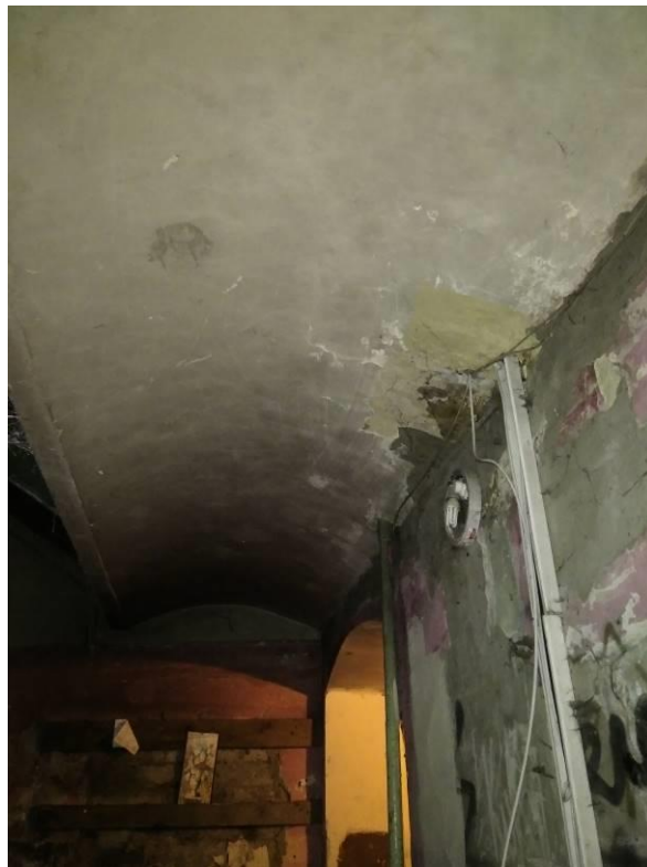
Rys. 4 Widok na strop nad parterem - ubytki tynku, zarysowania, zabrudzenia
