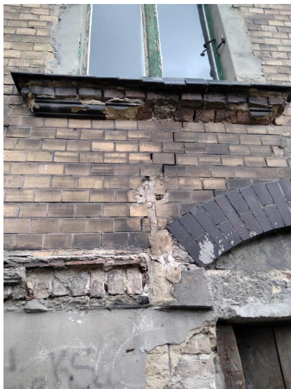
Rys. 18 Zarysowanie ukośne murów podokiennych przy nadprożu drzwiowym na elewacji tylnej, ubytki gzymsu oraz parapetu, korozja powłoki malarskiej stolarki okiennej
