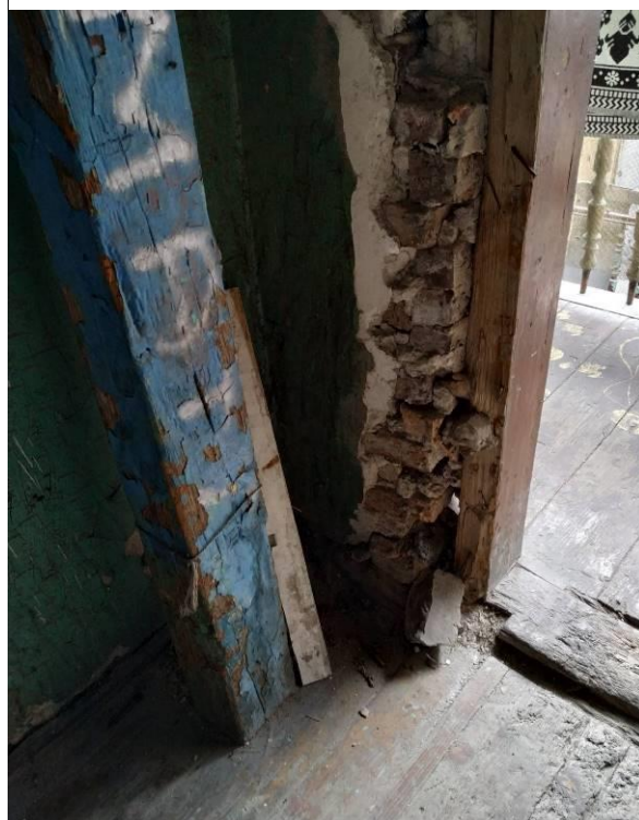
Rys. 14 Ubytki w ścianie, degradacja tynku oraz powłoki malarskiej
