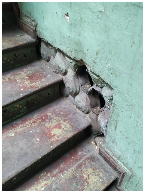
Rys. 9 Miejscowe ubytki w ścianie, degradacja stopnic schodów
