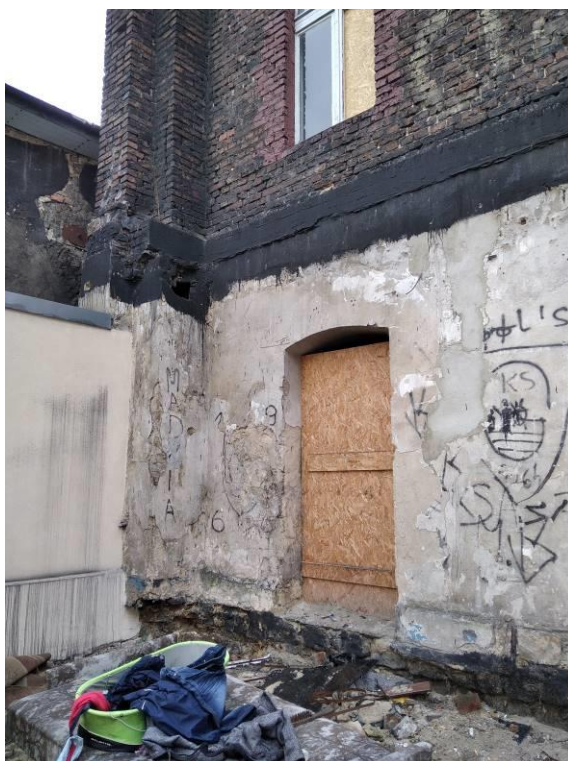
Rys. 16 Miejscowe zabrudzenia oraz odspojenia tynku na elewacji frontowej, zalegające odpady wokół budynku
