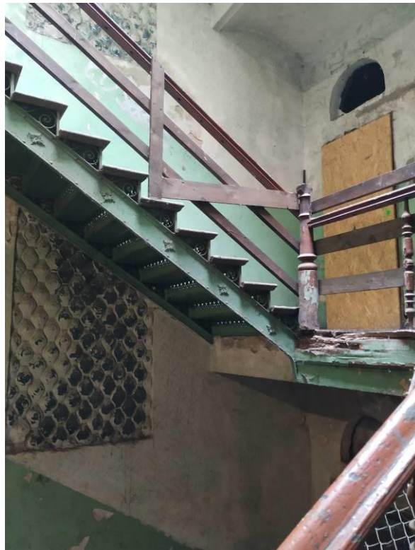
Rys. 8 Drewniane balustrady przy schodach, które tymczasowo zabezpieczają przed upadkiem z wysokości, miejscowe braki w konstrukcji balustrady, degradacja konstrukcji schodów, brak stolarki okiennej i drzwiowej
