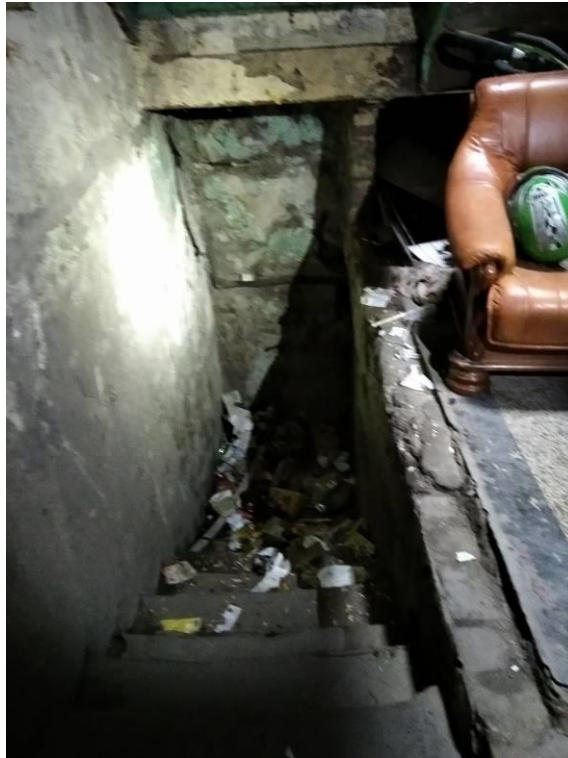
Rys. 3 Zejście do piwnicy, całkowicie zasypane odpadami
