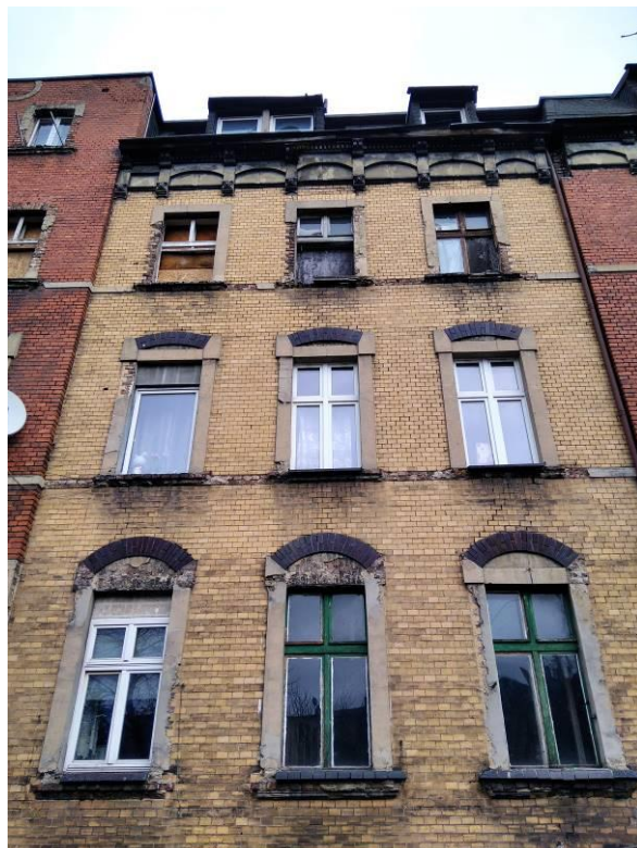
Rys. 17 Zarysowania ukośne murów podokiennych przy nadprożu okiennym na elewacji tylnej, braki w oszkleniu stolarki okiennej, ubytki gzymsów
