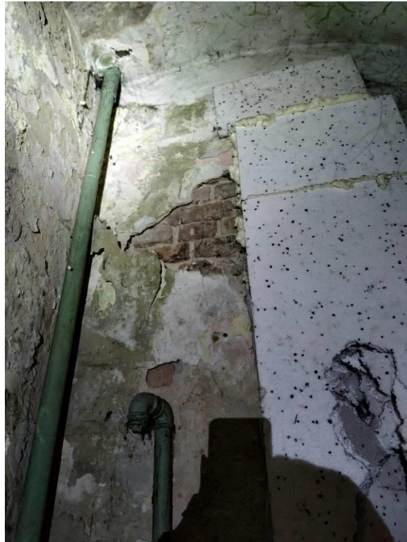
Rys. 7 Ubytki tynku na klatce schodowej w budynku, degradacja powłoki malarskiej, silne zawilgocenia
