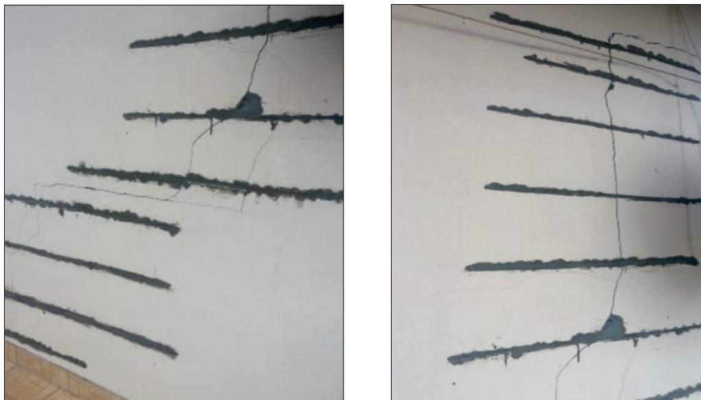
Rys. 22 Zszyście rys zbrojeniem – ściana wewnętrzna
