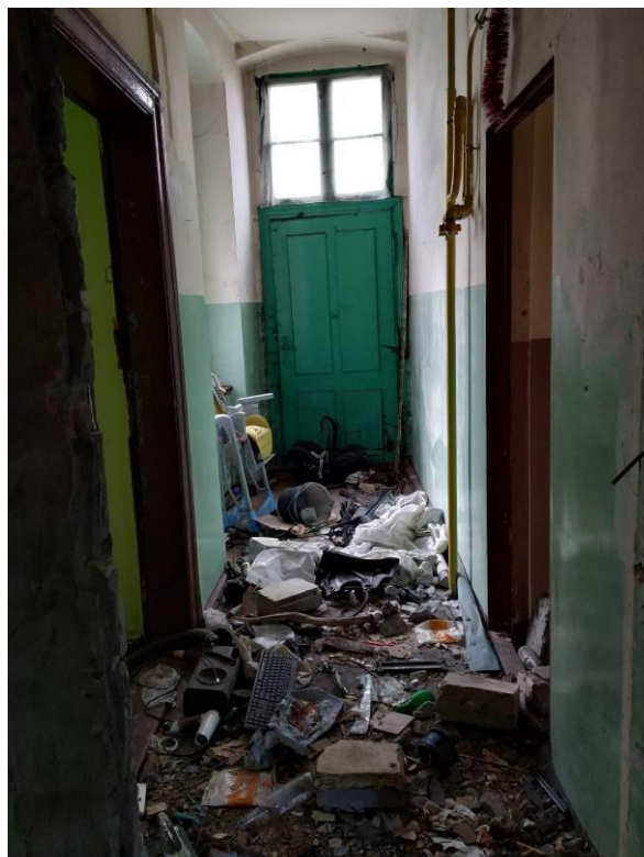
Rys. 5 Lokal zdewastowany na 1 piętrze w budynku – brak drzwi wejściowych, zalegające odpady w mieszkaniu
