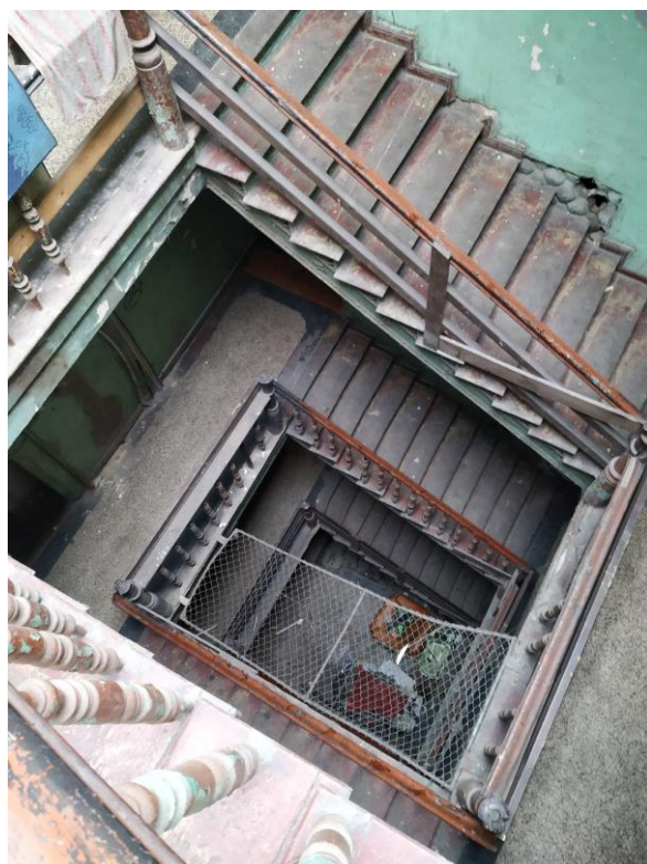
Rys. 10 Widok na klatkę schodową, degradacja konstrukcji schodów oraz balustrady
