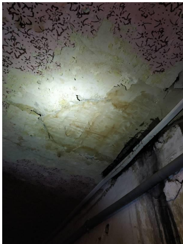
Rys. 13 Zacieki na poddaszu – zalanie sufitu, odspojenie tynku oraz powłoki malarskiej
