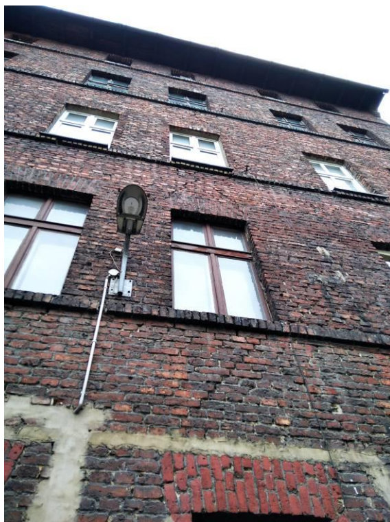
Rys. 15 Zarysowania ukośne murów podokiennych przy nadprożu okiennym na elewacji frontowej
