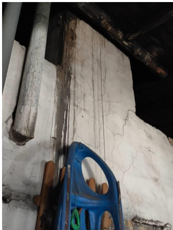
Rys. 15 Spękania komina, miejscowe zacieki
