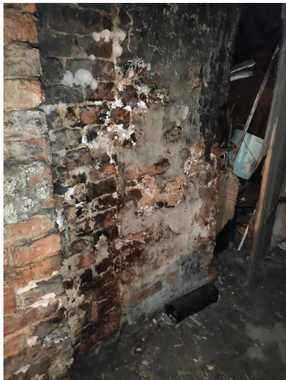
Rys. 4 Korozja biologiczna muru, wykwity grzybni na ścianach piwnicznych
