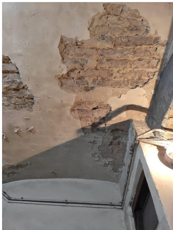
Rys. 7 Odspojenia tynku ze stropu w piwnicy
