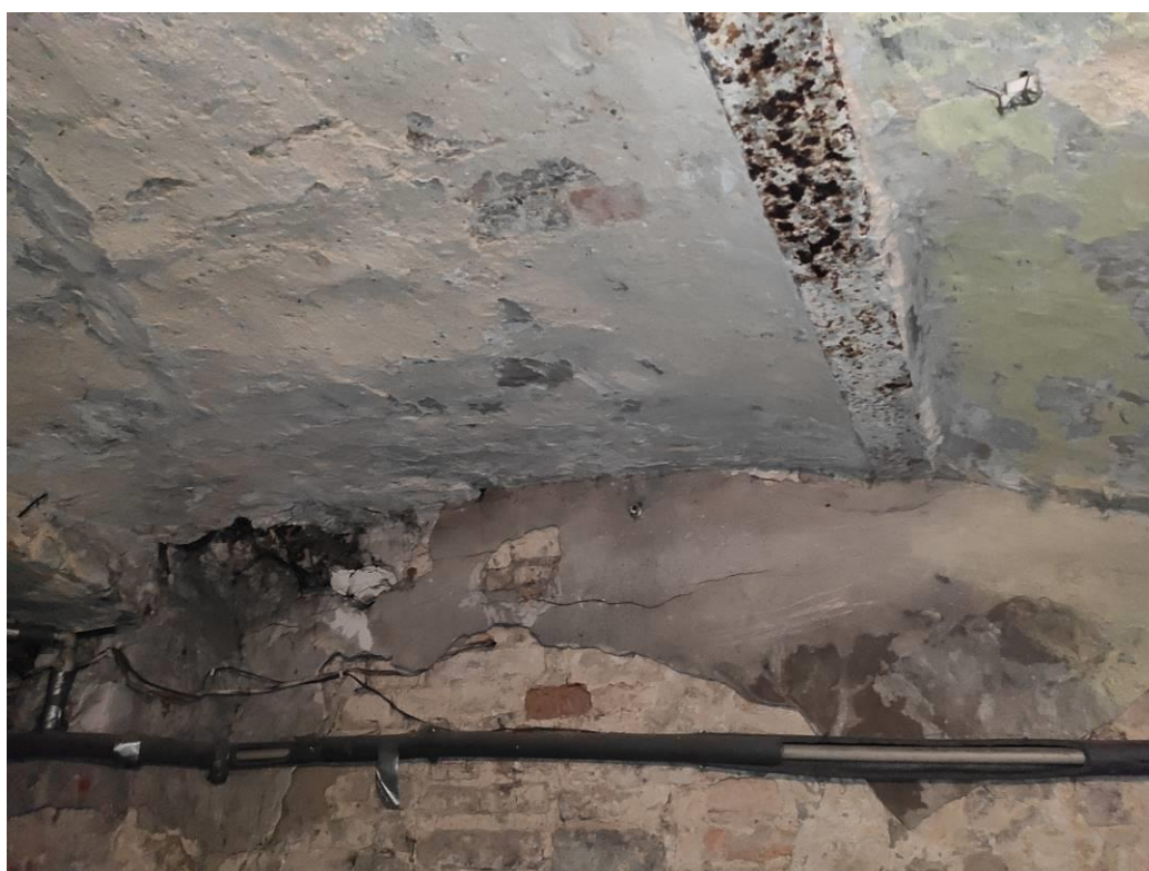
Rys. 6 Korozja stropowych belek stalowych w piwnicy
