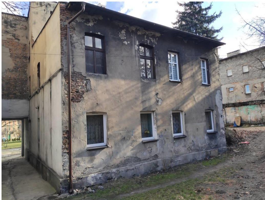
Rys. 16 Elewacja tylna budynku – Liczne odspojenia tynku na elewacji
