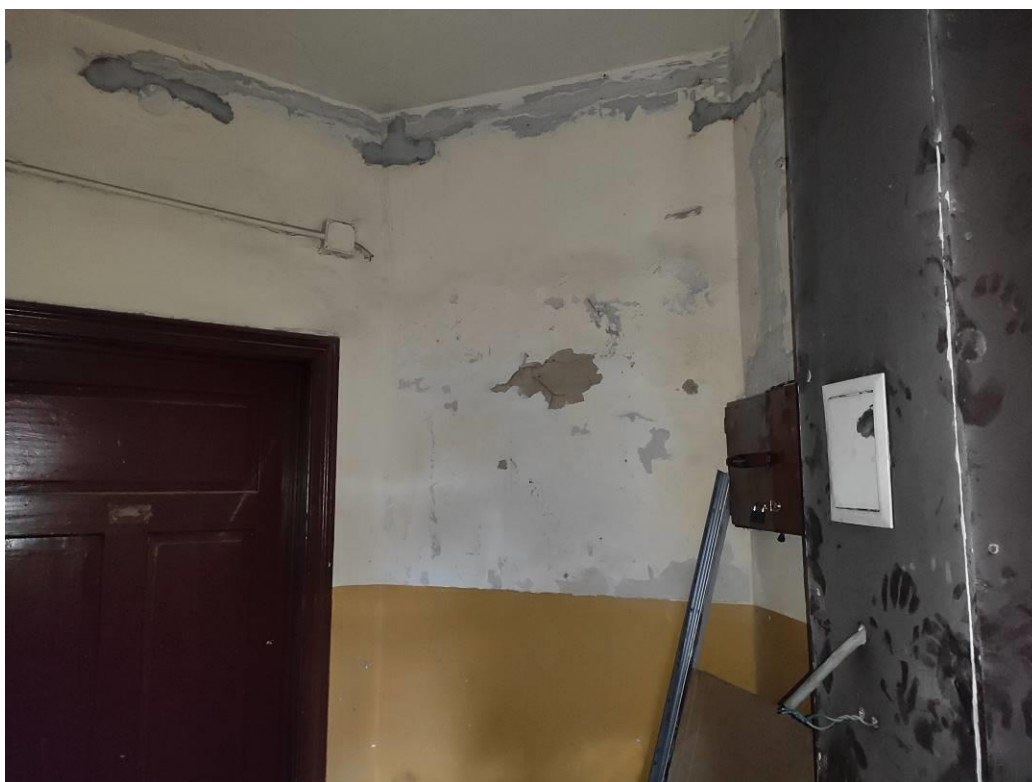
Rys. 10 Odspojenie tynku na klatce schodowej, łuszczenie powłoki malarskiej
