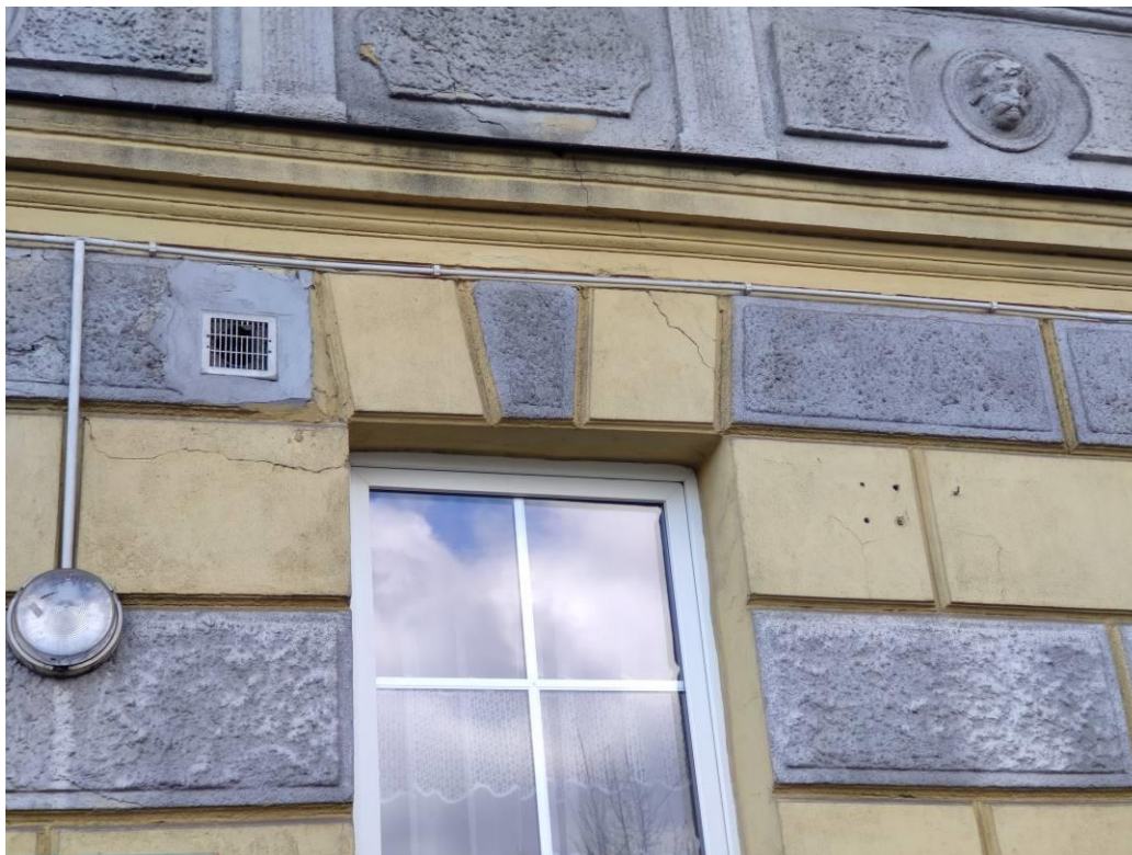
Rys. 21 Zarysowania ukośne, które koncentrują się głównie w narożach okien
