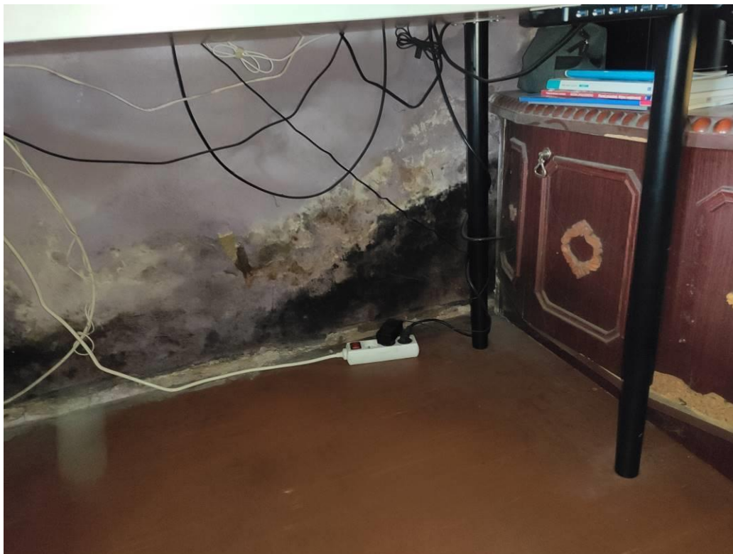
Rys. 9 Zagrzybiona ściana w lokalu mieszkalnym na parterze
