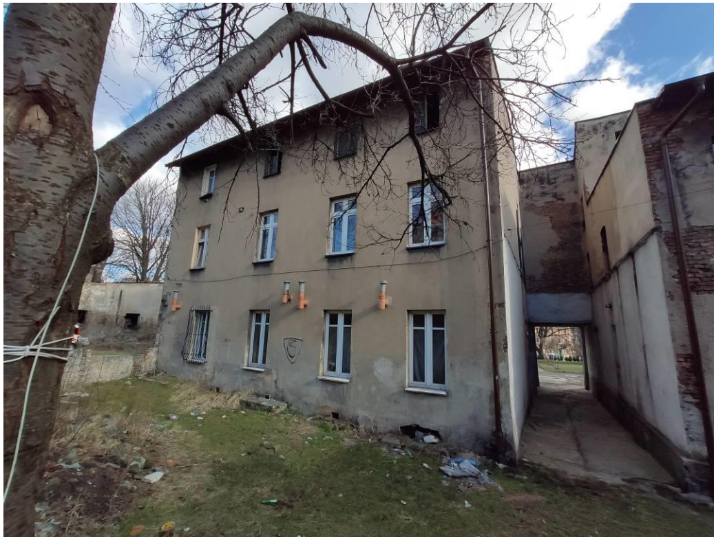
Rys. 17 Odspojenia tynku na elewacjach, zabrudzenia typu graffiti, zawilgocenia ścian w rejonach okien piwnicznych
