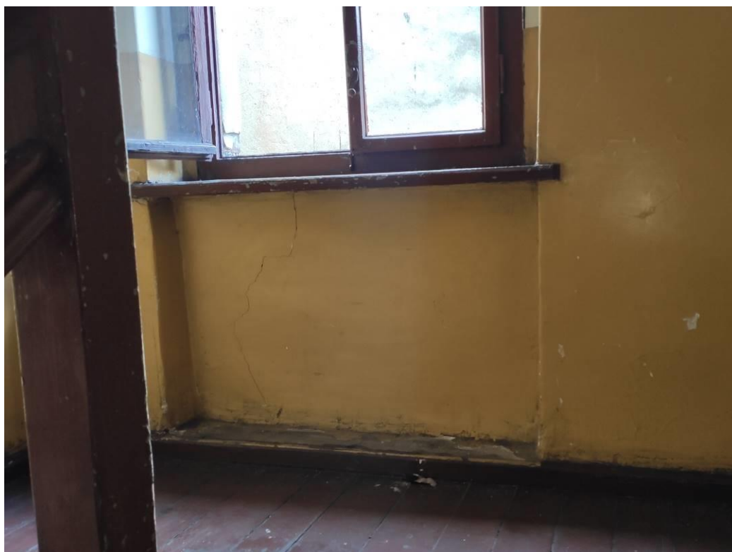
Rys. 11 Pęknięcie pionowe ściany
