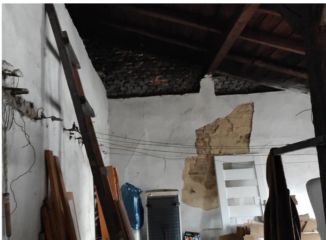
Rys. 14 Odspojenie tynku na dużej powierzchni na poddaszu
