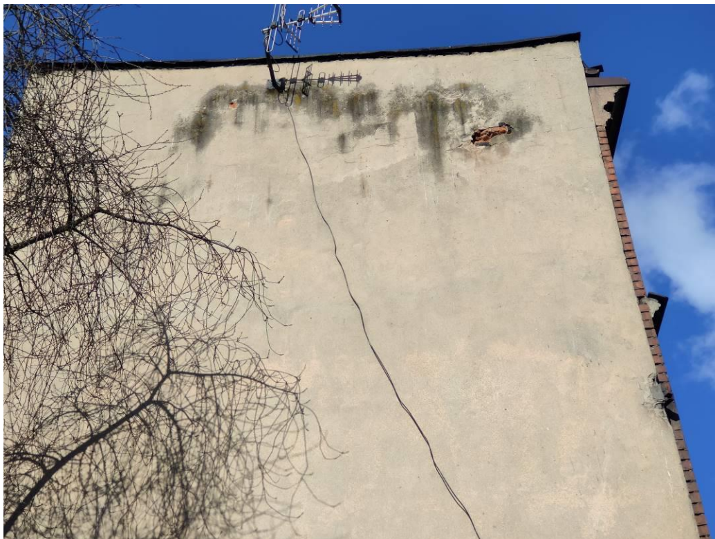
Rys. 19 Korozja biologiczna tynku w górnej części elewacji bocznej oraz zmurszenie cegieł
