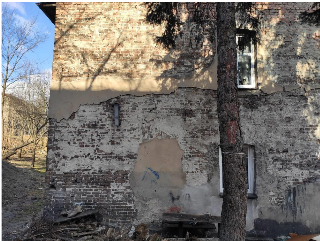
Rys. 18 Odspojenia tynku na dużej powierzchni na elewacji bocznej, lokalne ubytki cegieł w ścianie
