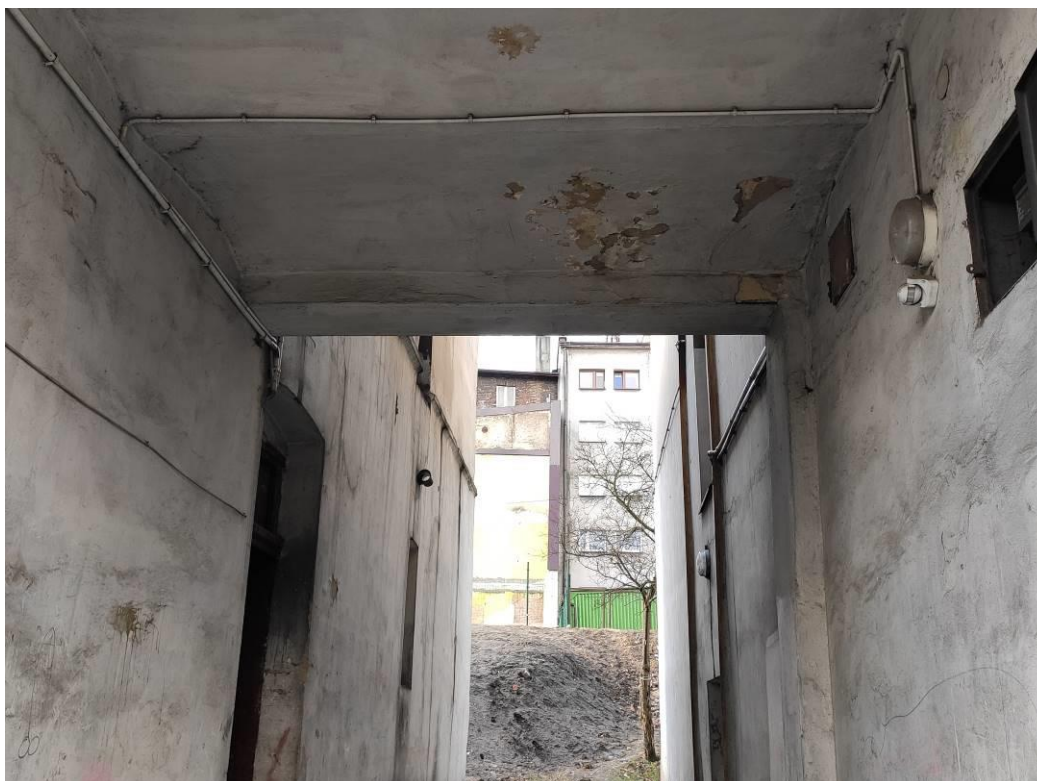
Rys. 22 Odspojenia tynku, łuszczenie farby na stropie
