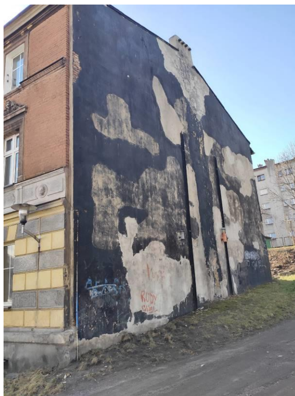
Rys. 20 Odspojenia tynku na elewacji bocznej
