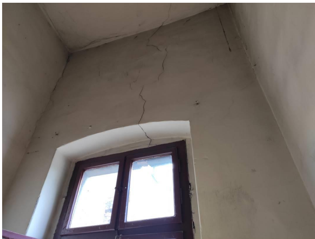
Rys. 12 Pęknięcie pionowe nad otworem okiennym
