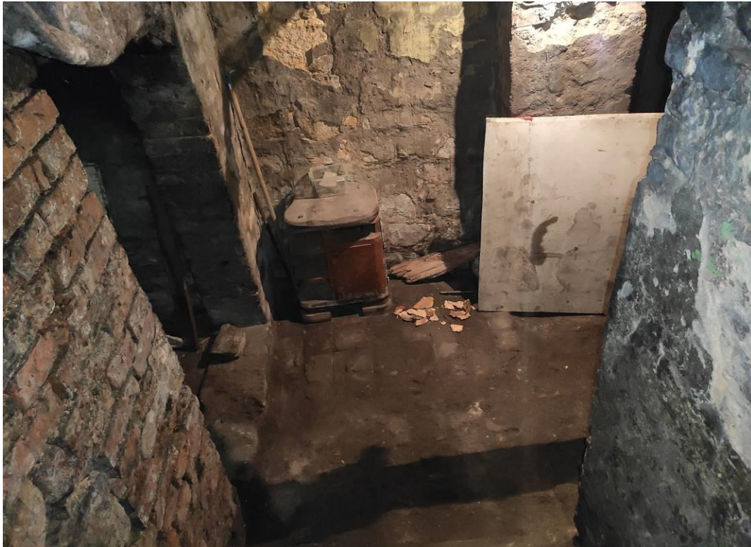
Rys. 3 Zawilgocenie ścian piwnic
