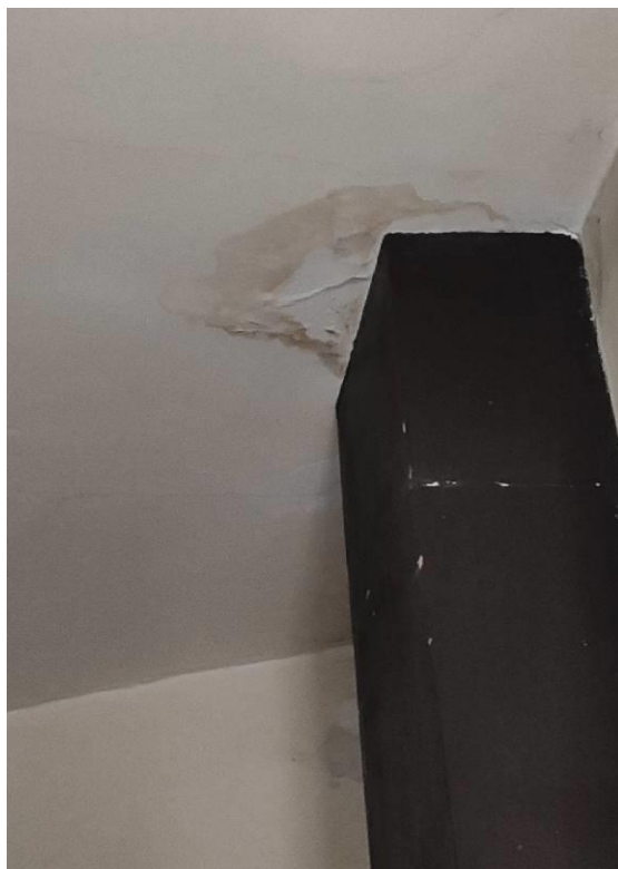
Rys. 13 Zacieki na stropie w rejonie komina
