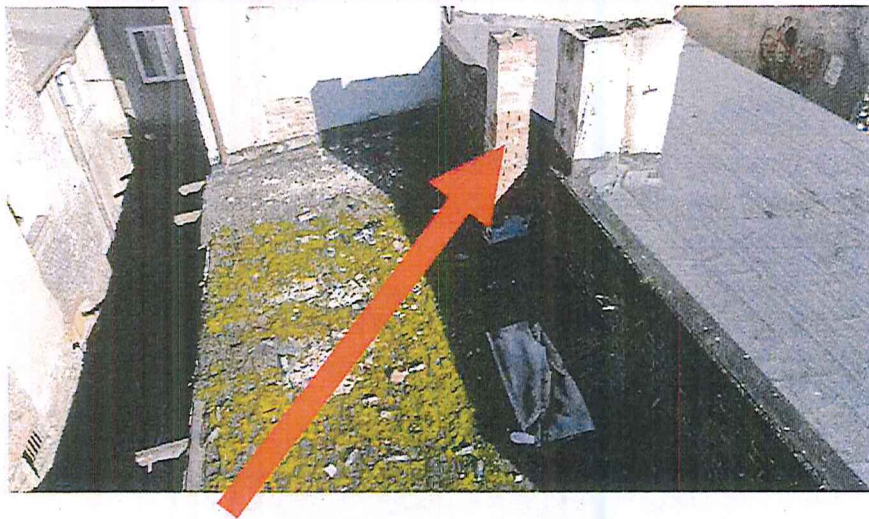
Brak spoin komina
