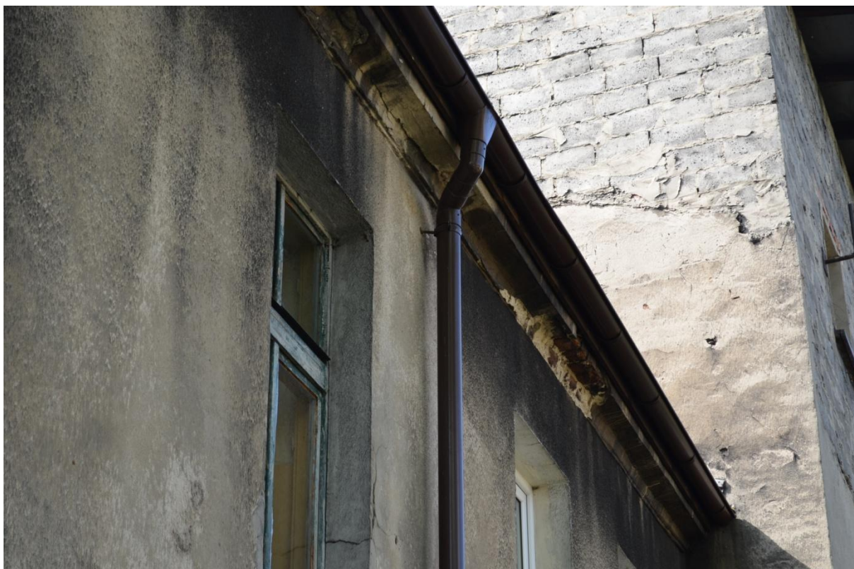
Zdjęcie nr 4 – Widok rynny, rury spustowej i gzymsu od strony podwórka
