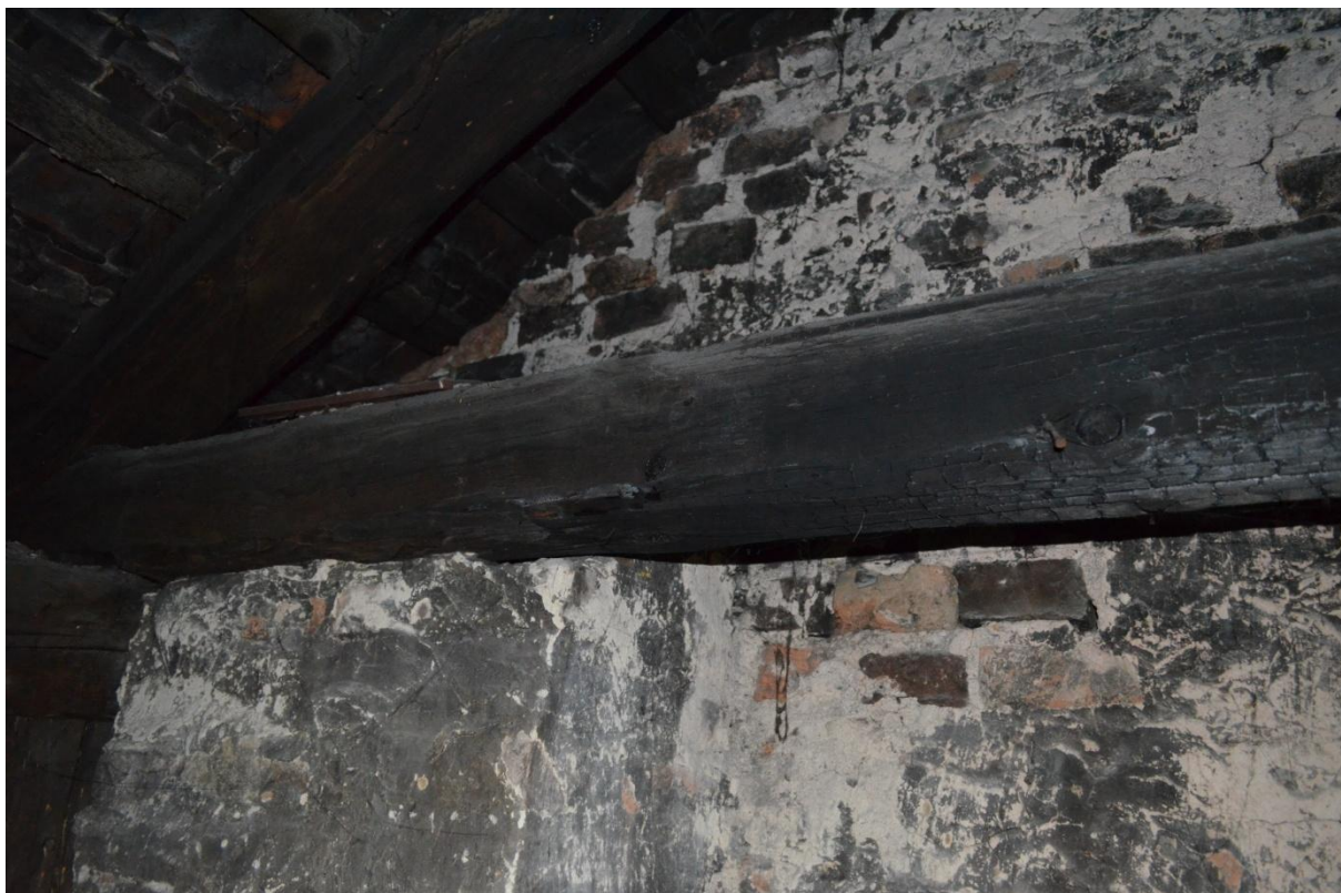
Zdjęcie nr 12 – Nadpalone elementy konstrukcji dachowej przy ścianie szczytowej
