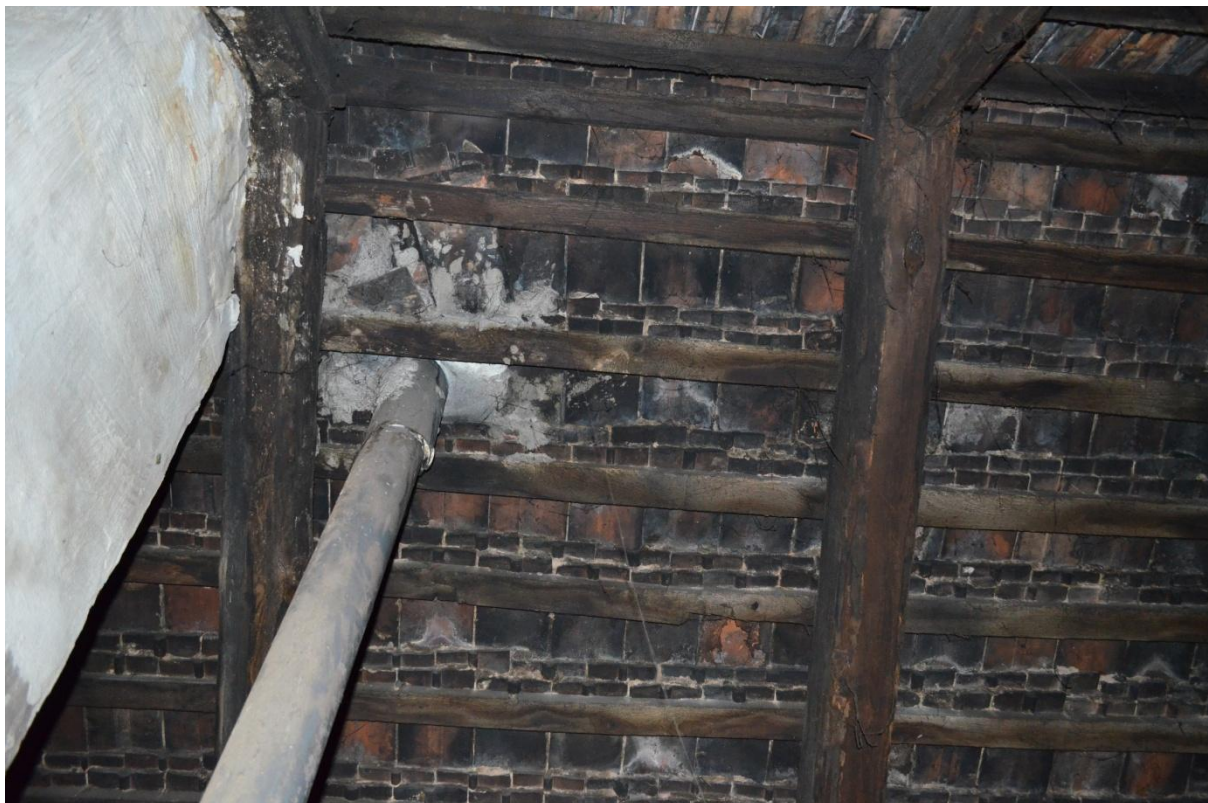
Zdjęcie nr 9 – Nieszczelne przejście rury wywiewnej przez połać dachową
