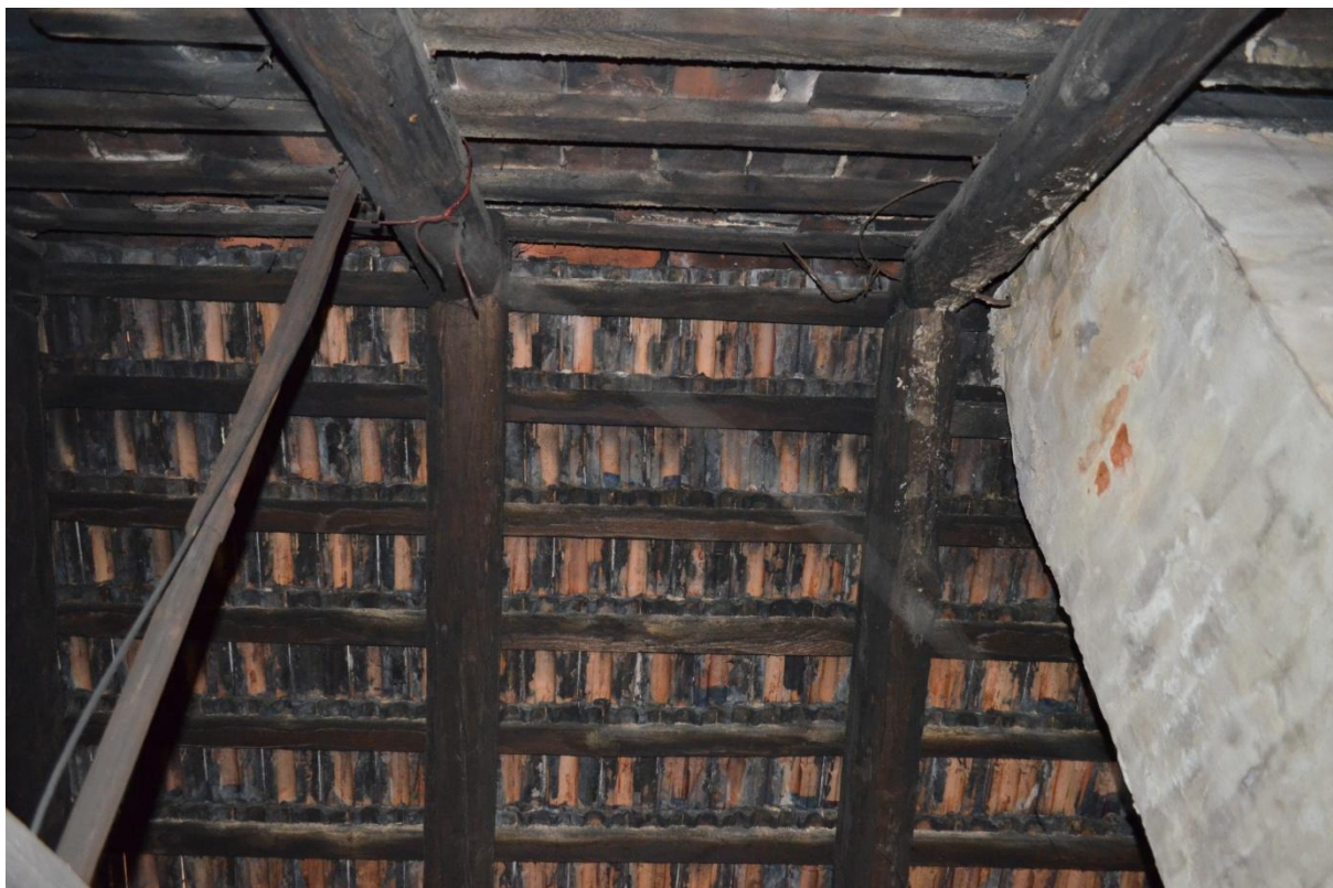
Zdjęcie nr 10 – Korozja krokwi dachowych wokół kominów
