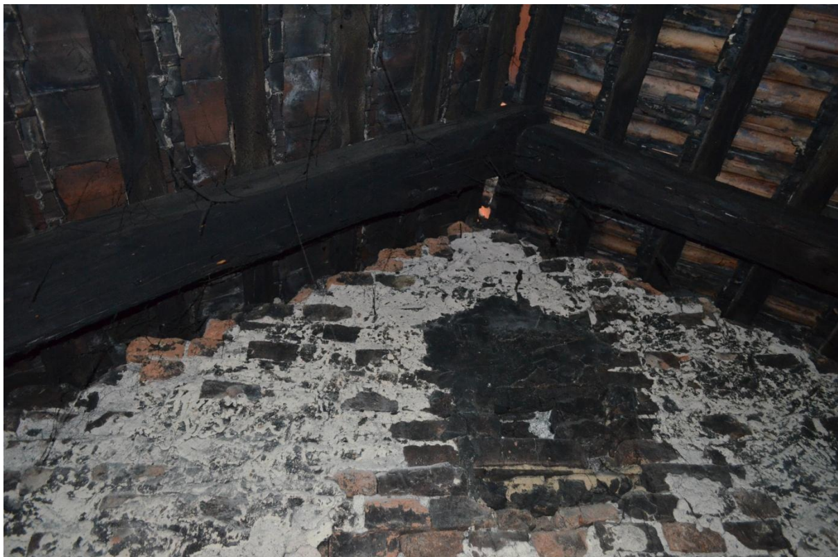
Zdjęcie nr 13 – Nadpalone krokwie, sadza na ścianie szczytowej
