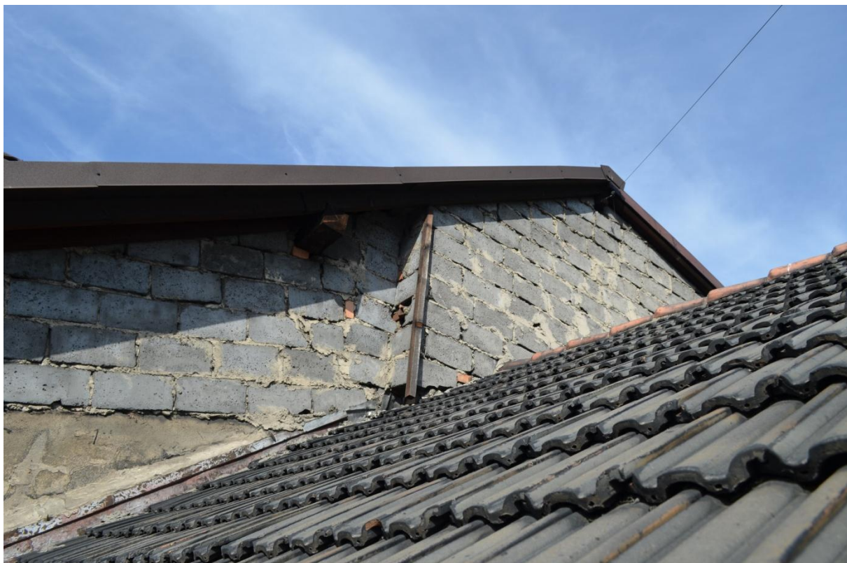
Zdjęcie nr 6 – Widok ściany szczytowej budynku przyległego, nieszczelność obróbki blacharskiej
