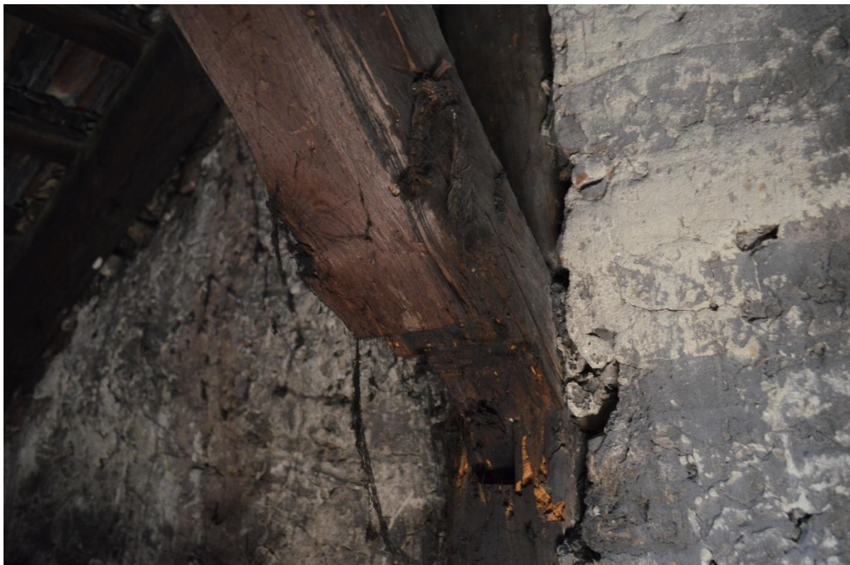
Zdjęcie nr 7 – Uszkodzenie miecza konstrukcji więźby dachowej
