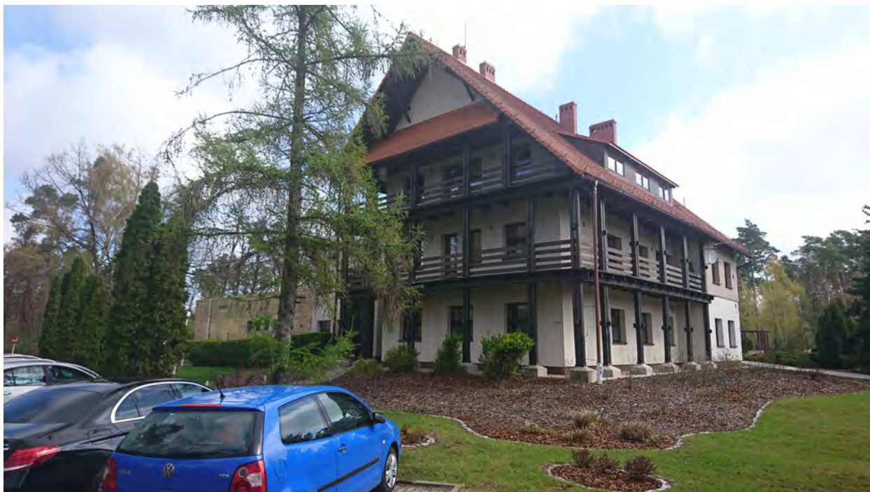
FOTO 1 – DACH NA SZCZYCIE BUDYNKU – NADMIERNE UGIĘCIA
