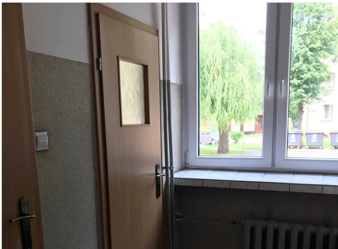
Fot. 13. Nie zasłonięte okna w korytarzu, mogące powodować oślnienie.
