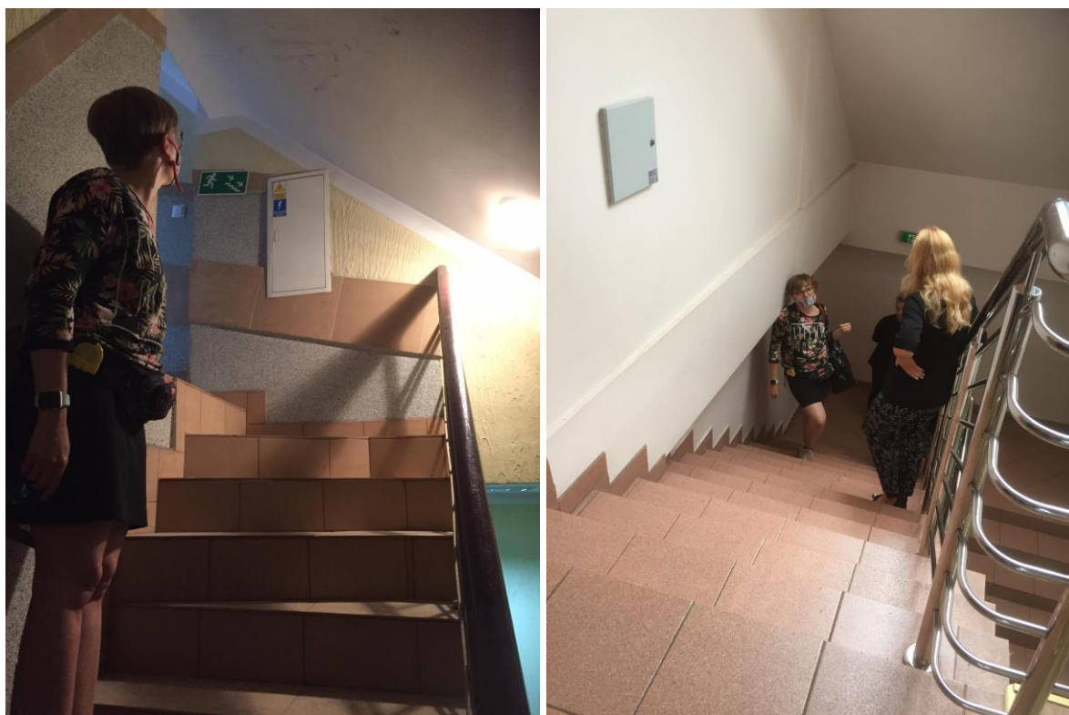
Fot. 1 (po lewej). Klatka schodowa prowadząca na strych od strony części administracyjnej. Fot. 2 (po prawej). Zaniżenie na głównej klatce schodowej.
