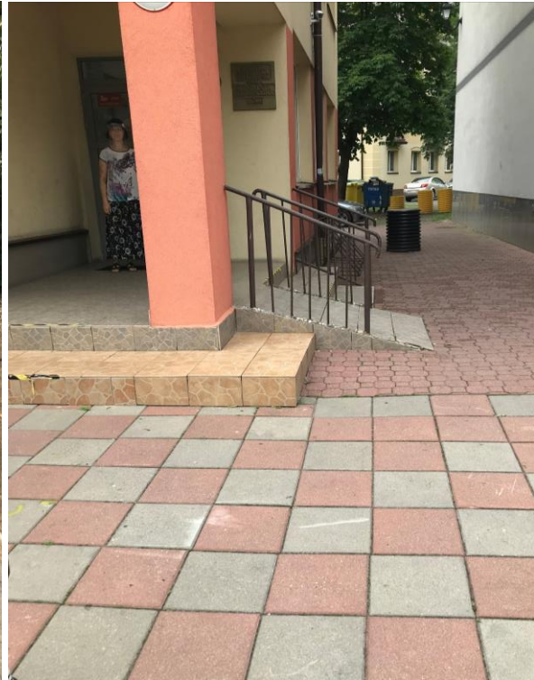
Fot. 2 (po prawej). Pochylnia nie dostosowana do potrzeb osób z niepełnosprawnościami.
