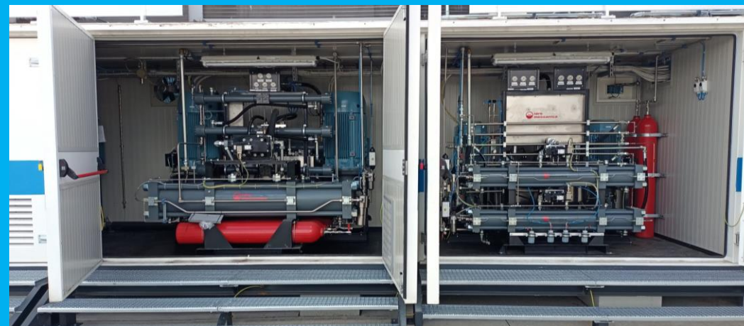
Kompresor wodorowy | Elektrolizer
