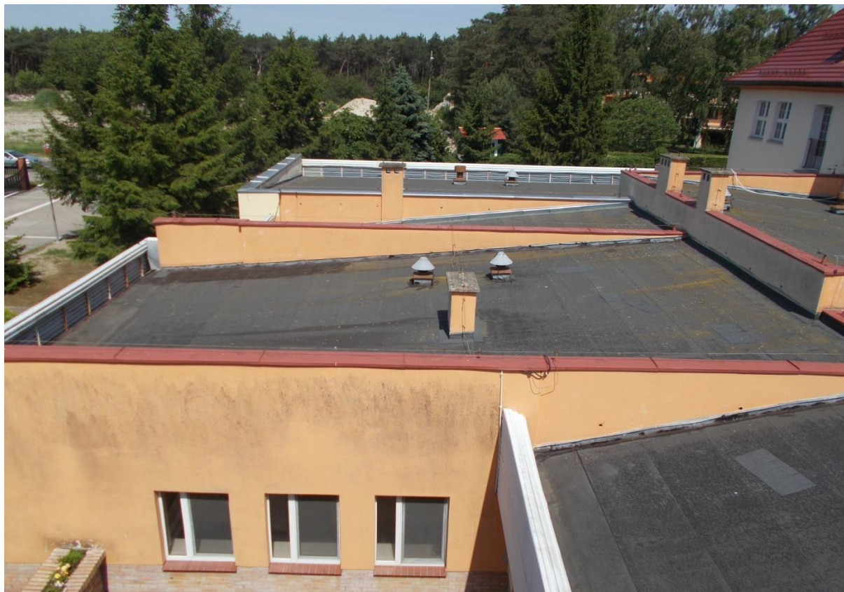
Stan techniczny dachu i pokrycia z papy
