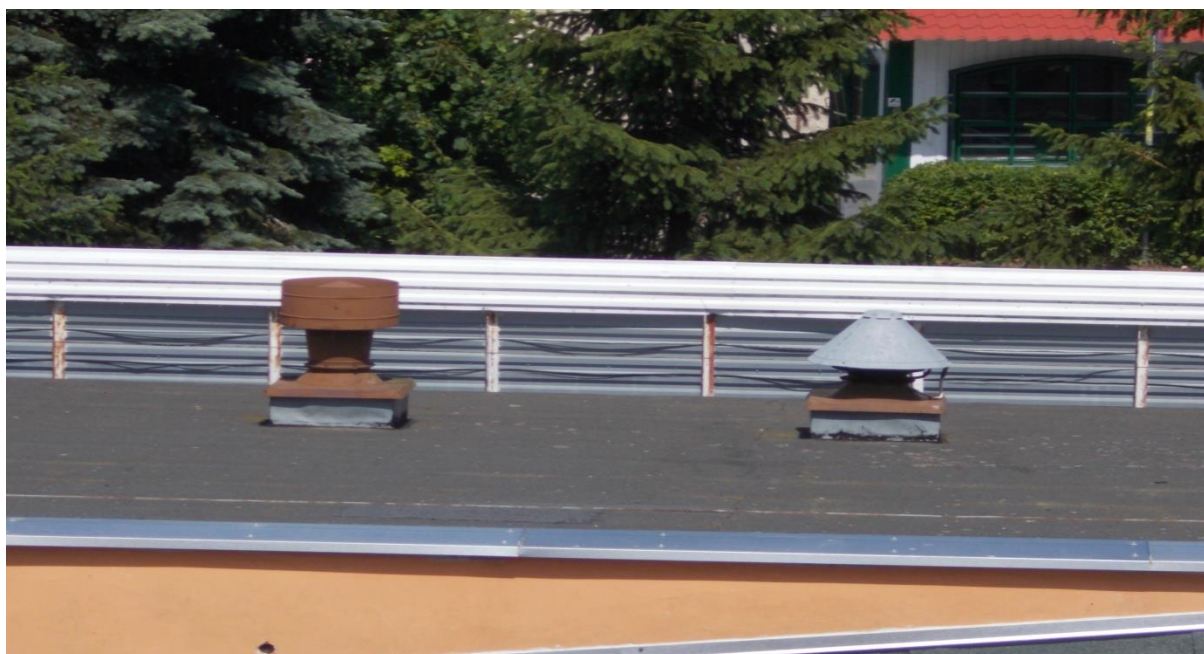
Stan techniczny dachu i pokrycia z papy
