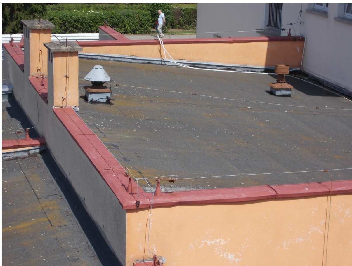
Stan techniczny dachu i pokrycia z papy
