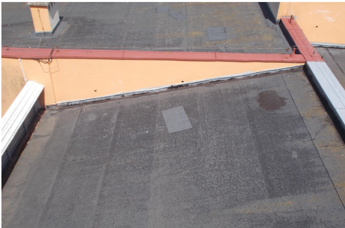
Stan techniczny dachu i pokrycia z papy
