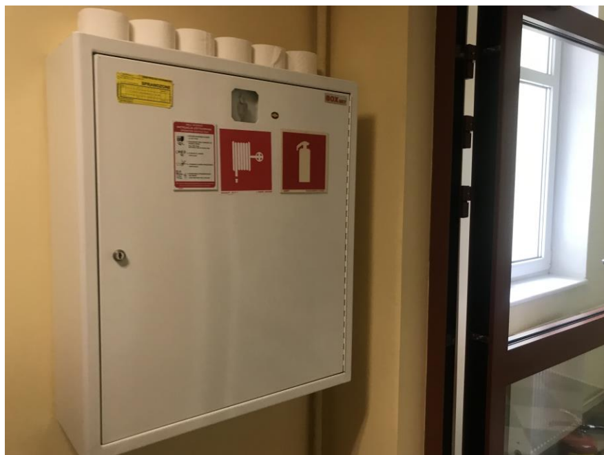
Szafka hydrantowa – do wymiany
