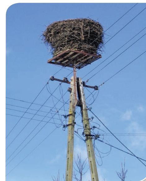
Wysokie i ciężkie gniazdo wymagające odciążenia. Fot. AT
