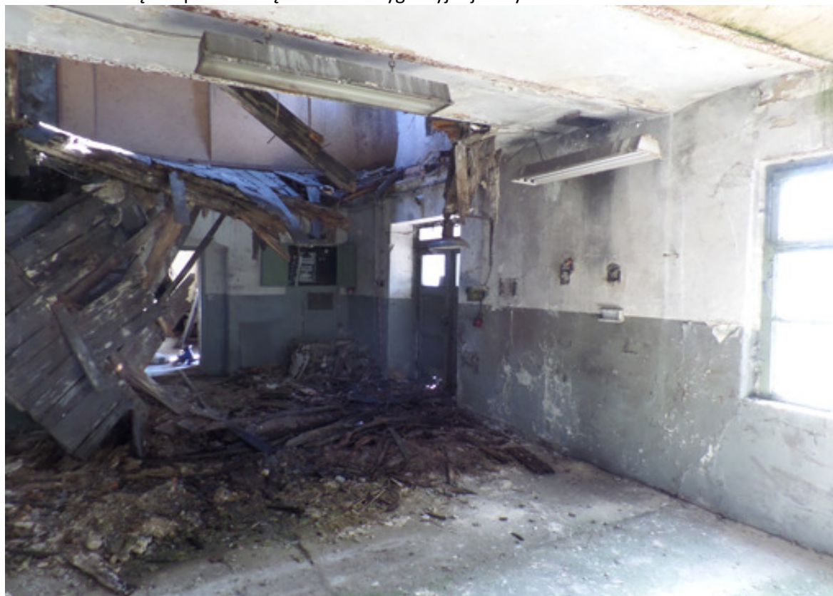
Fot. Nr 6b – wnętrze parteru części dwukondygnacyjnej budynku z zawalonym stropem drewnianym
