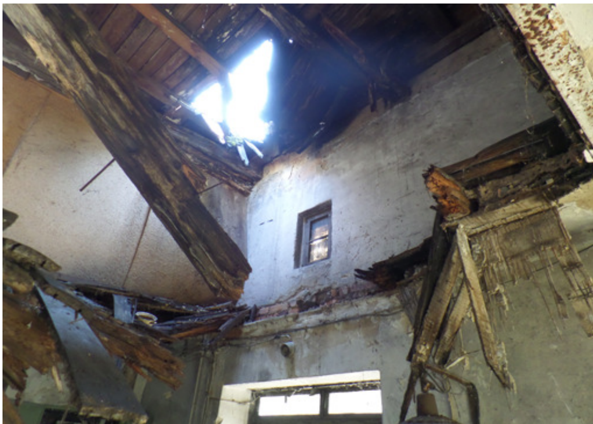
Fot. Nr 6c – wnętrze parteru części dwukondygnacyjnej budynku z zawalonym stropem drewnianym i dachem
