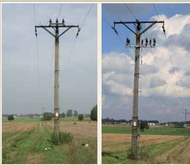
Rozłącznik na którym doszło do porażenia bocianów oraz ten sam po modernizacji. Fot. IK
