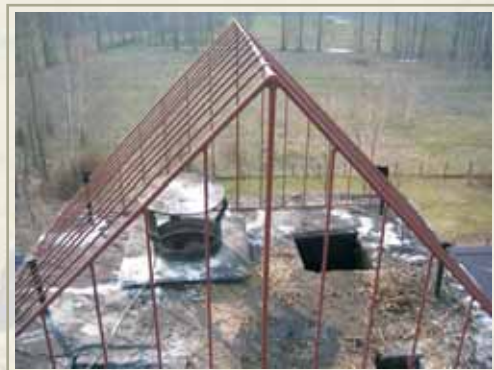
Stożek zabezpieczający komin przed siadaniem bocianów. Fot. AT
