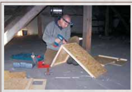
Skrzynki montowane są z elementów dopiero na miejscu powieszenia. Fot. DK
