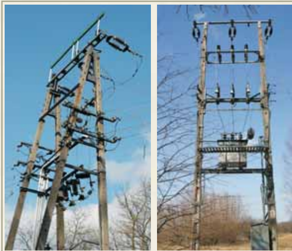
Różne sposoby zapobiegania porażeniom (podest i niebezpieczne odgromniki umieszczone poniżej górnego poprzecznika słupa). Fot. MO i IK
