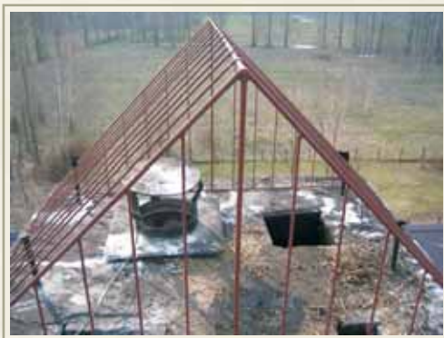
Stożek zabezpieczający komin przed siadaniem bocianów. Fot. AT
